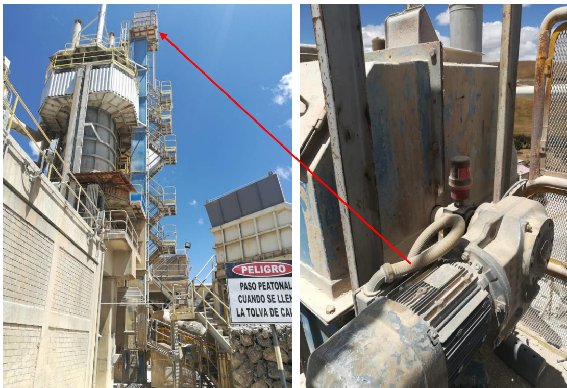
Figura 10: Ubicación del reductor y motor en el elevador de cangilones. Éste alimenta al horno con caliza, su altura aproximada es de 25 m.
