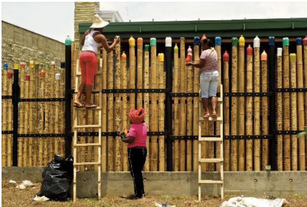
Figura 3: Proceso de participación en el proyecto Centro de Desarrollo Infantil El Guadual
