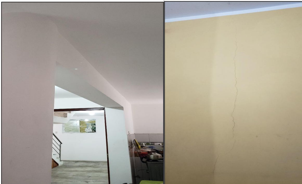
Anexo 1.24 : Pórtico con columna de sección circular en el 4to piso y muro confinado de albañilería con presencia de fisuras en el 1er piso de la edificación N° 14
