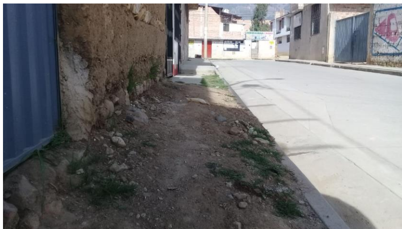
Figura 44. Sección de cuadra con falta de acera en el Jr. Celendín.
