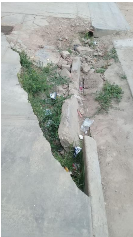
Figura 43. Acera en mal estado.
