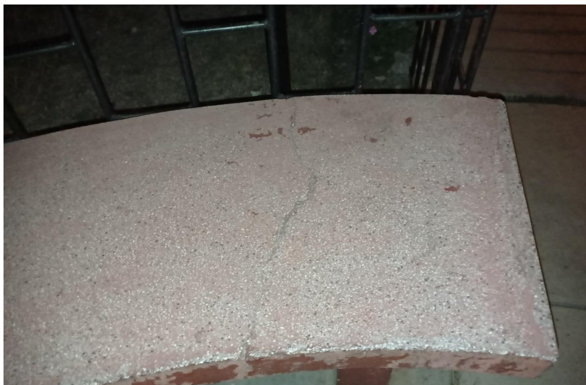
Figura 56. Presencia de banca con grietas.
