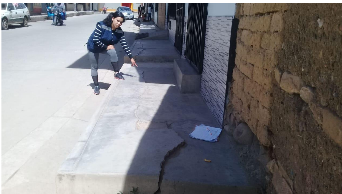
Figura 42. Acera con grietas y desniveles.
