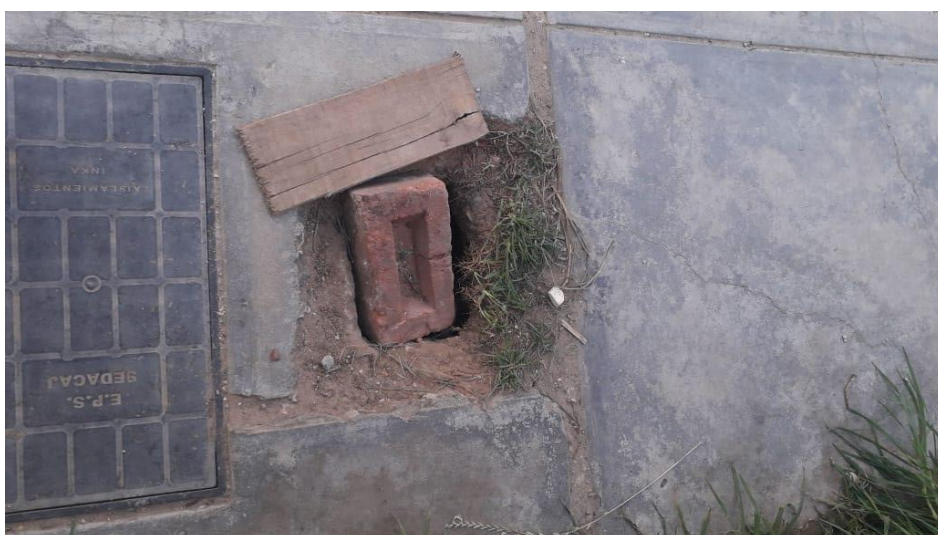
Figura 34. Existencia de hoyo en Jr. Cusco.
