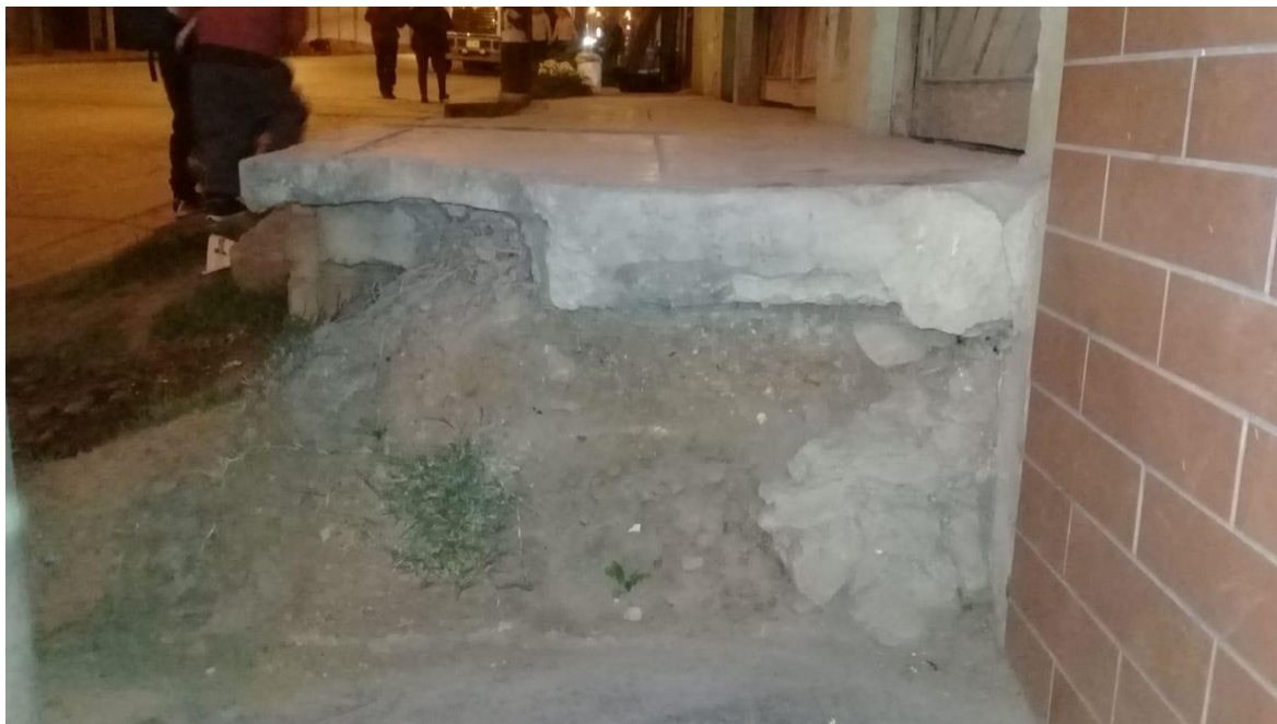
Figura 39. Av. Tahuantinsuyo presencia de desnivel y mal estado de la acera.
