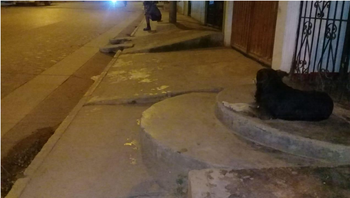
Figura 37. Disconformidad de aceras en Av. Tahuantinsuyo.
