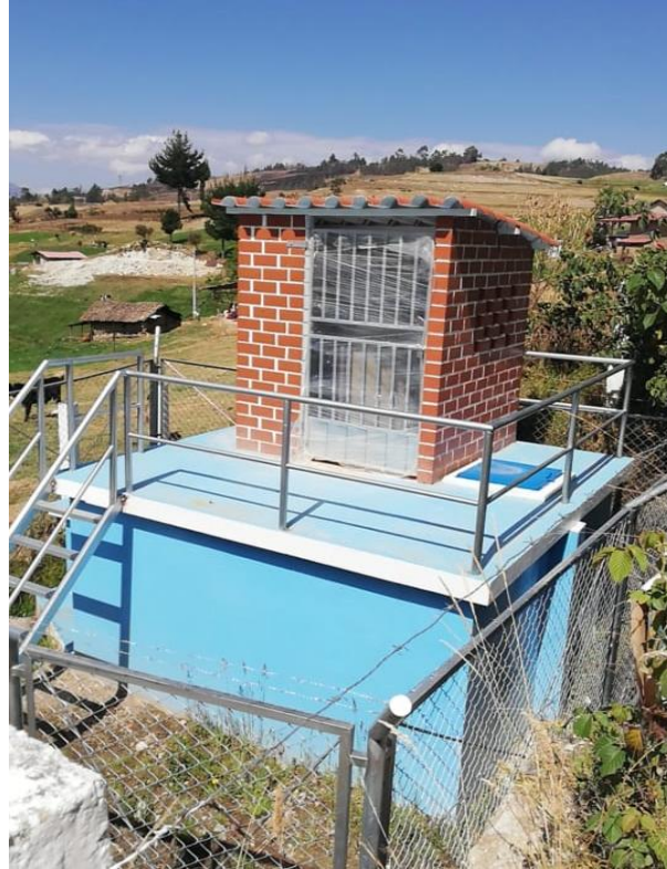
Figura 2. Punto N°2 de muestreo reservorio y caseta de cloración.
