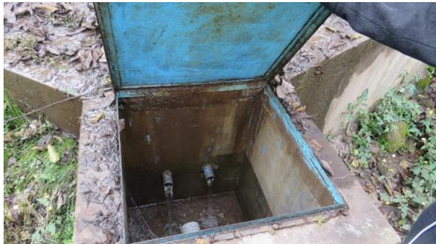
Figura 1. Punto N°1 Captación de Agua.
