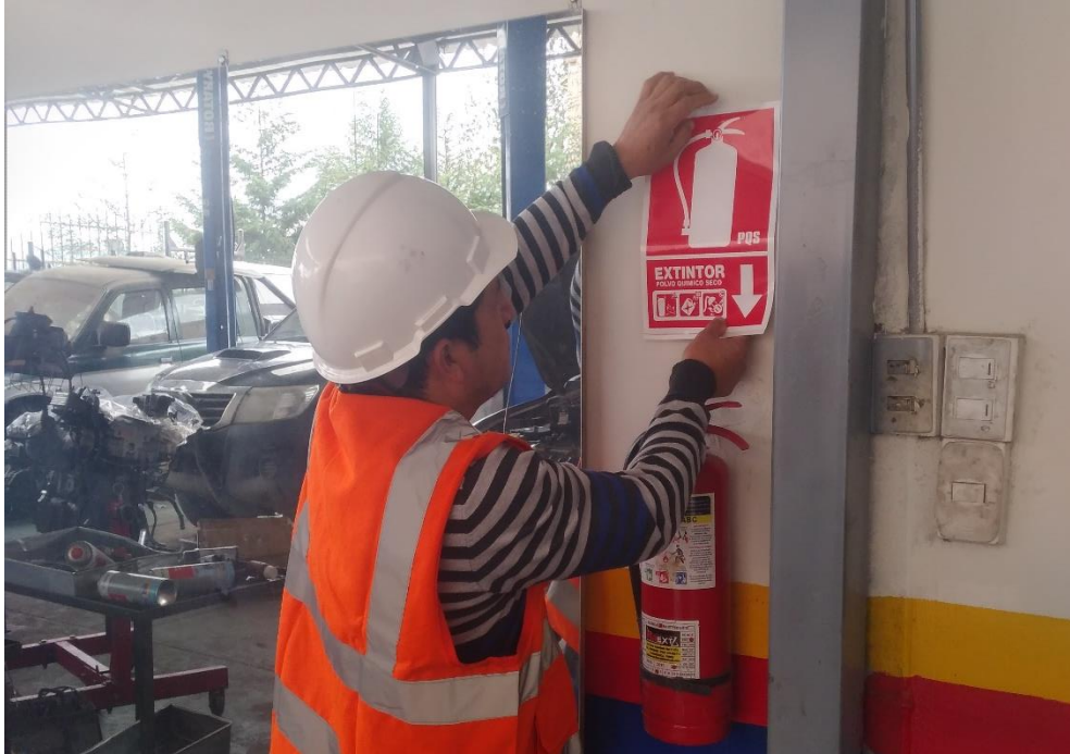
Figura 13: Implementación de señalización de equipos de emergencia.
