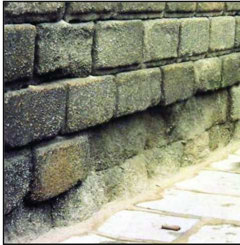
Fig. 3 Erosión atmosférica en muro de Piedras
