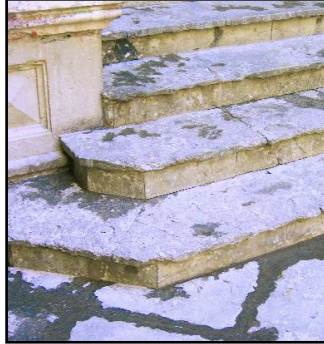
Fig. 7 Casos de Erosión Mecánica
