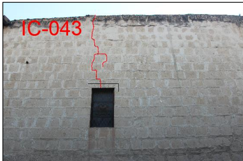
Fig. 52 Grieta IC-043 (Zona de Mayor Influencia)
