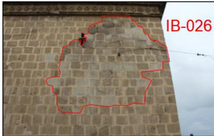
Fig. 61 Erosión IB-026 (Zona de Mayor Influencia de Patología)
