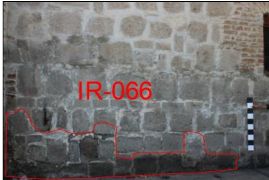
Fig. 54 Erosión IR-066 (Zona de Mayor Influencia de Patología)
