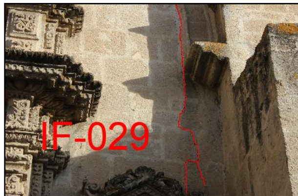
Fig. 39 Grieta IF-029 San Francisco
