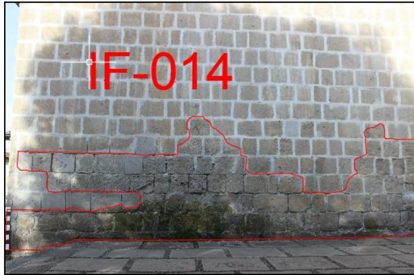
Fig. 57 Erosión IF-014 (Zona de mayor influencia de Patología)
