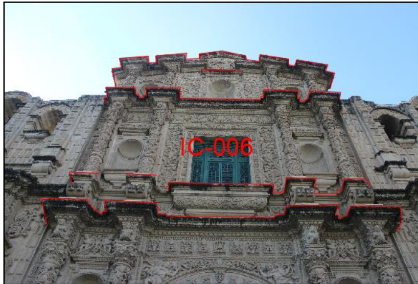
Fig. 51 Suciedad por Filtración de Agua IC-006 (Zona de Mayor Influencia)
