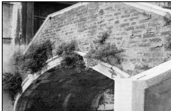
Fig. 1 Proliferación de Hongos, Musgos y Vegetales por humedad
