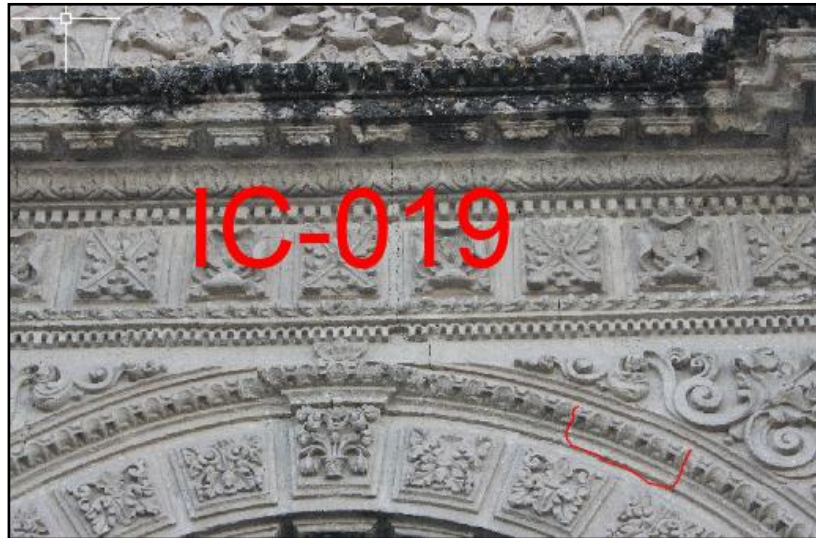
Fig. 53 Fisura IC-019 (Zona de Mayor Influencia)
