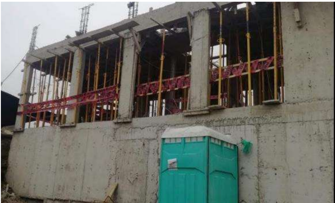
Nota: Controles operacionales
