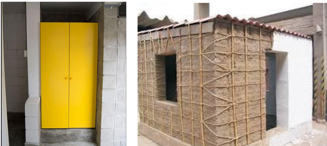
Figura 4. Modelo puertas en vivienda Autosostenible. Se distingue de los actuales modelos de vivienda social, ya que permite la construcción progresiva de manera segura y sostenible, a partir de la iniciativa de la Embajada Británica (izquierda) y una construcción a base de adobe (derecha)
