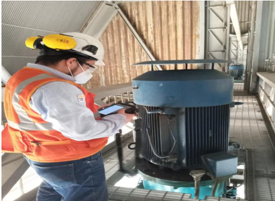
Figura N° 14. Monitoreo de vibraciones Motor-Reductor-Ventilador Fuente: Elaboracion propia
