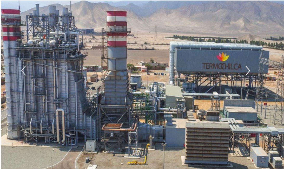
Figura N° 2. Panorámica de la Planta de generación eléctrica Santo Domingo de los Olleros
