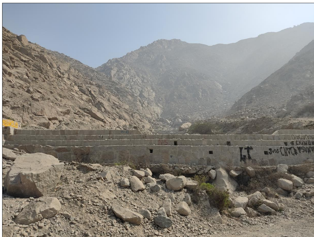
Foto 8 Diques En la quebrada Chacrasana se encuentran 8 diques, todas requieren limpieza.
