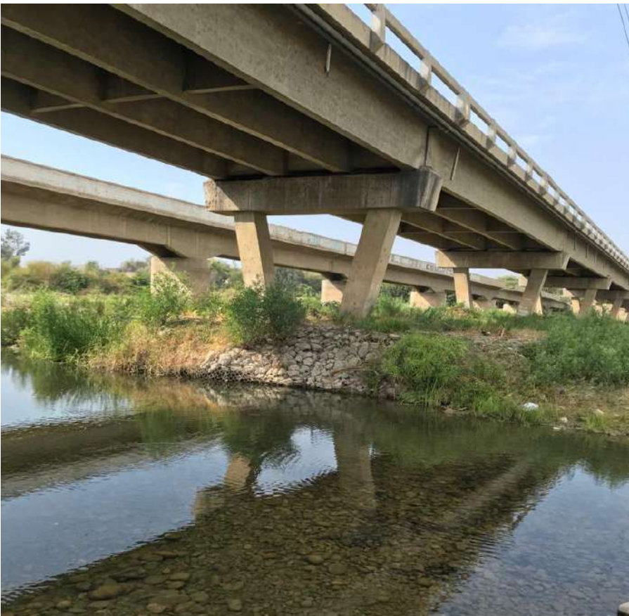
Figura III.34. Erosión del cauce
