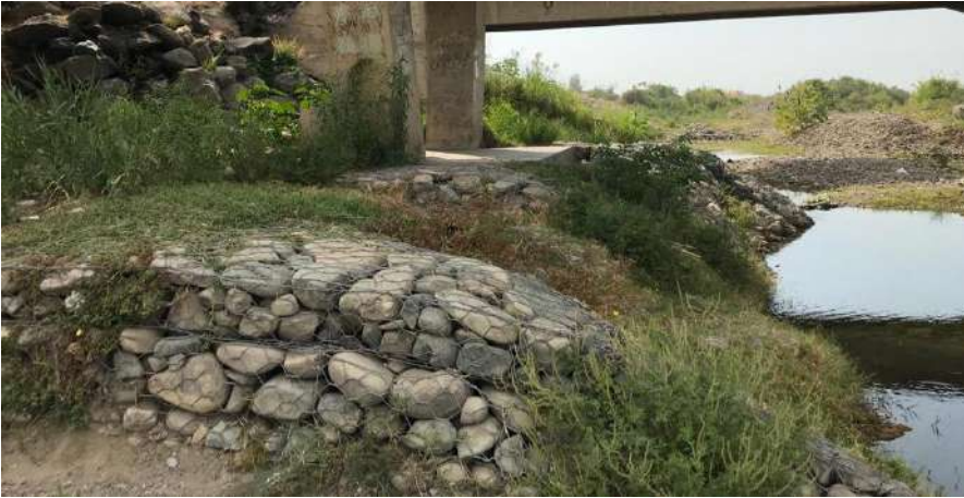
Figura III.33. Deterioro del manto de escollera
