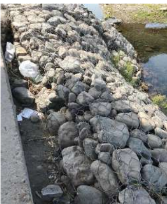
Figura III.32. Deterioro de manto de escollera
