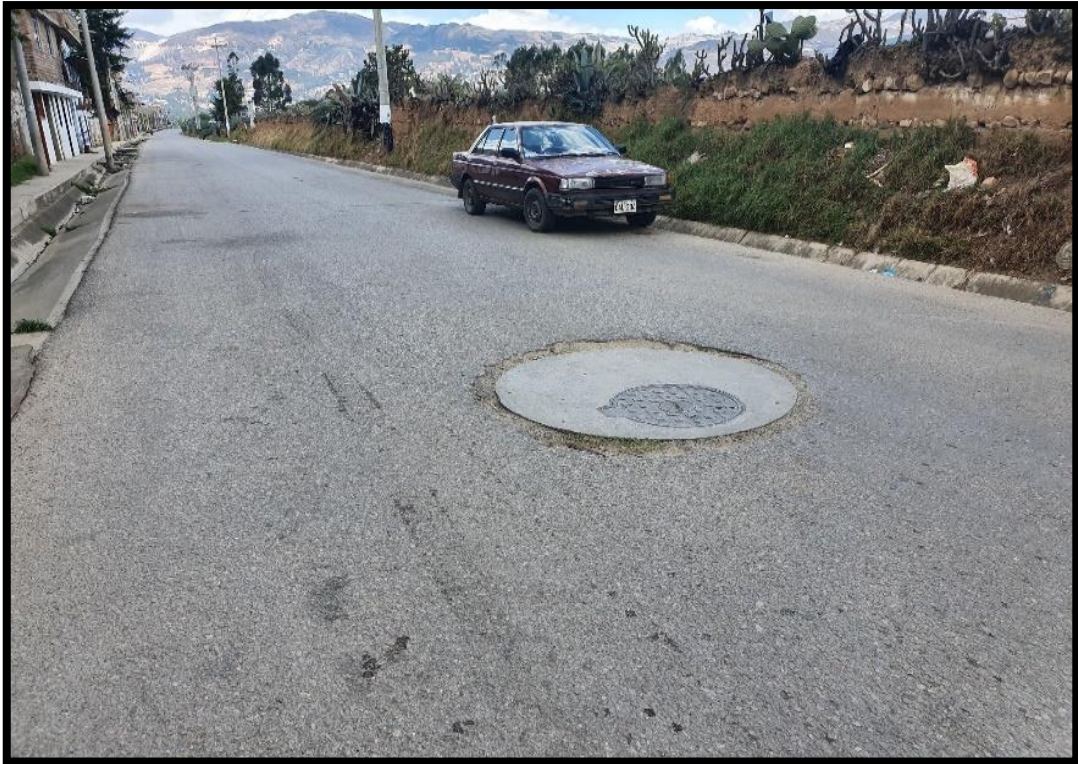
FOTOGRAFÍA 14: Desnivel entre el pavimento y buzón presente en la carretera
