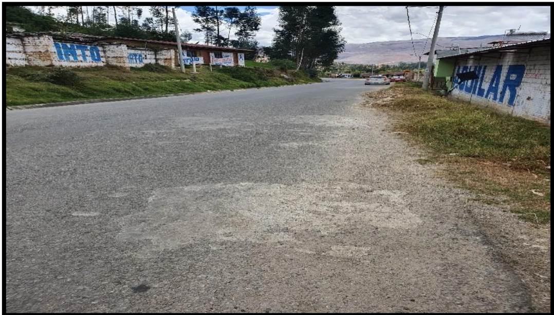
FOTOGRAFA 15: Irregularidad superficial causada por residuos de mezcla de concreto
