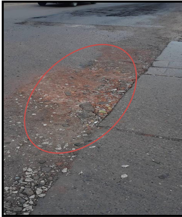
FOTOGRAFÍA 2: Pavimento en mal estado, relleno con material de desmonte, 2018.
