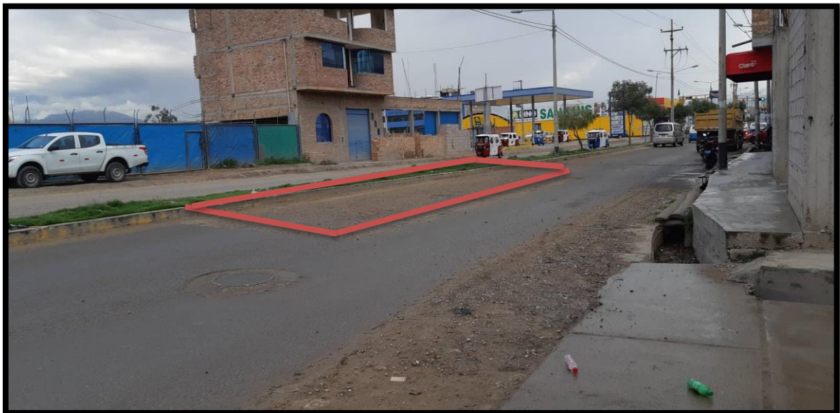
FOTOGRAFÍA 3: Ausencia de carpeta asfáltica, Vía de evitamiento norte, 2018.
