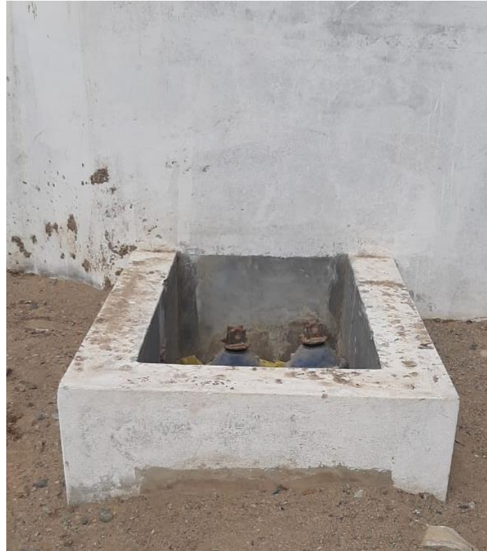
Figura 13. Caja de llaves de la planta de tratamiento de aguas residuales.
