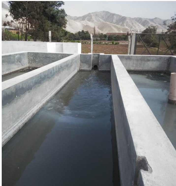
Figura 21. Tanque Imhoff de la Planta de Tratamiento de aguas residuales.
