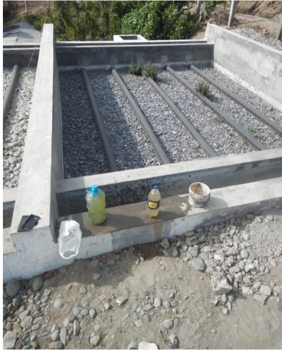
Figura 20. Filtros Biológicos de la Planta de Tratamiento de aguas residuales, se ha tomado las muestras para los análisis respectivos.
