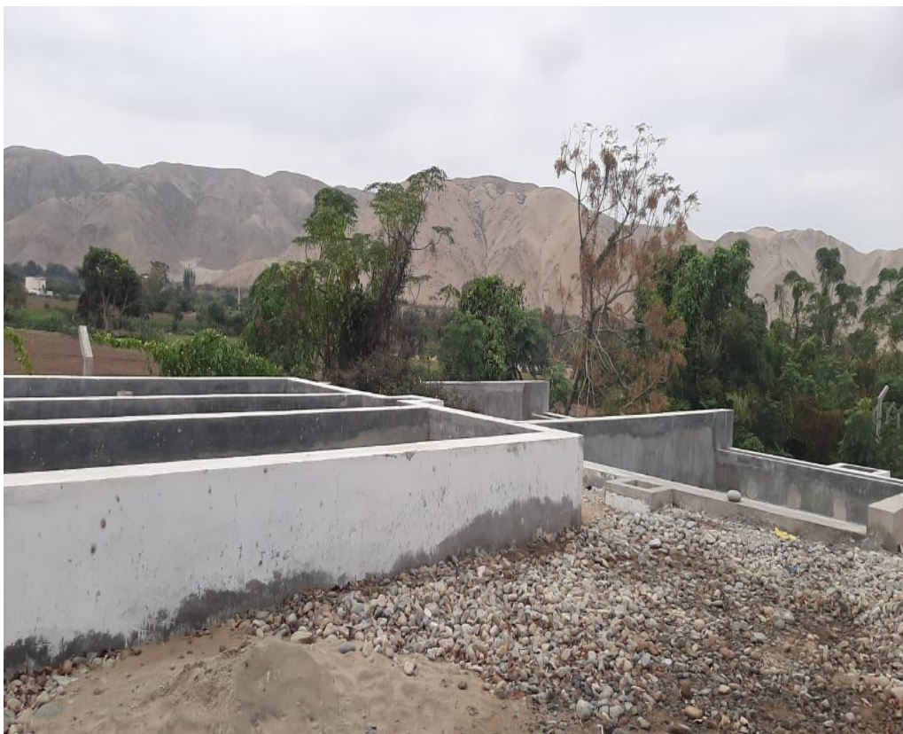
Figura 19. Cámara de distribución de la Planta de Tratamiento de aguas residuales.
