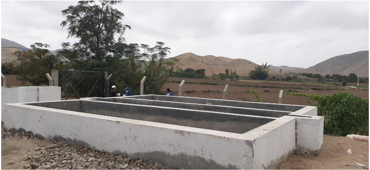
Figura 18. Tanque Imhoff de la Planta de Tratamiento de aguas residuales.
