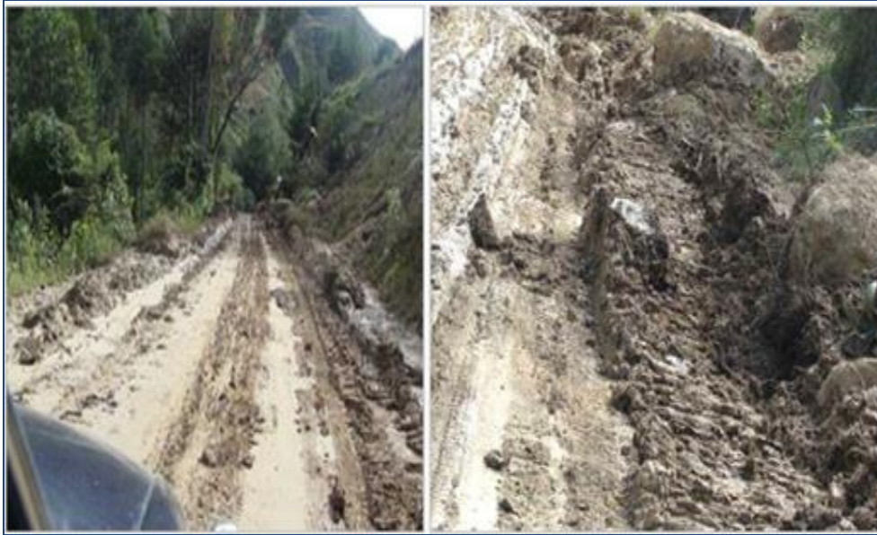
Figura 8. Mal Estado de la Carretera a Combayo
