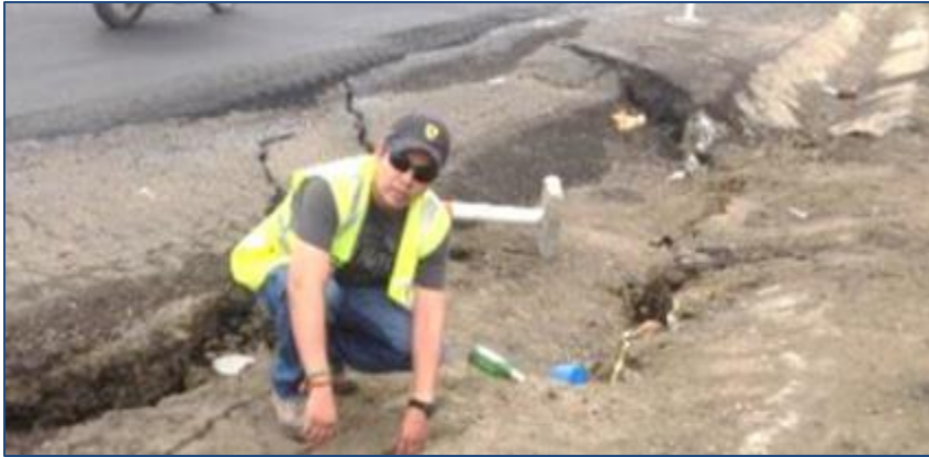
Figura 7. Asentamiento de la Vía a Causa de Arcillas Expansivas
