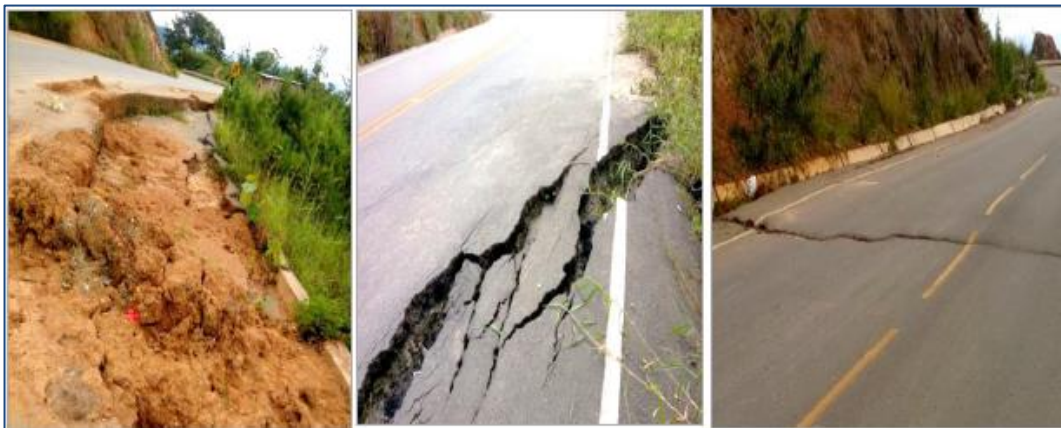
Figura 9. Falla del Pavimento de la Carretera de San Ignacio
