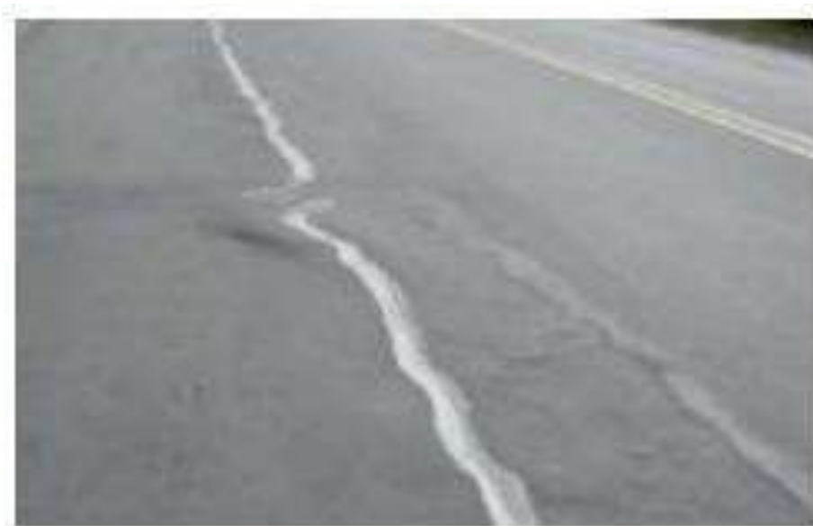
Figura 17 Ondulación en la vía
