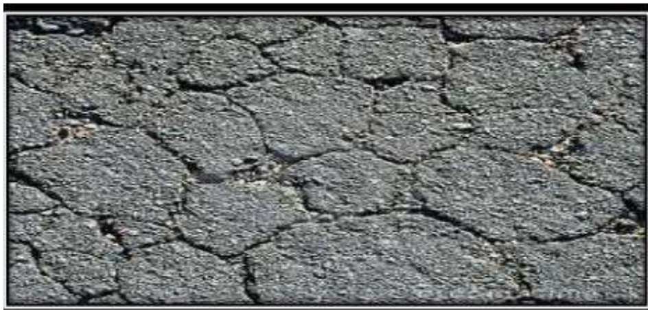
Figura 20. Falla piel de cocodrilo
