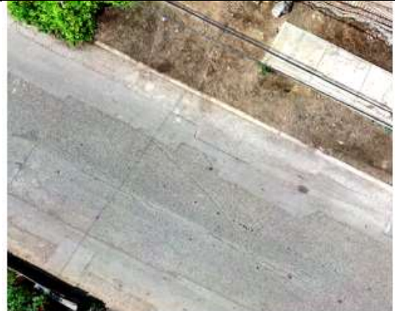
Identificación de falla de tipo Grieta con severidad Leve , con dimensiones de 2 m de Longitud.Se ubica con en la Unidad Muestral N° 1.
