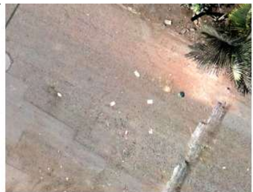
Identificación de falla de tipo Desprendimiento de Agregado con severidad Media .Se ubica con en la Unidad Muestral N° 4.
