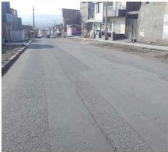
Identificación de falla de tipo Parche con severidad Leve .Se ubica con en la Unidad Muestral N° 10.
