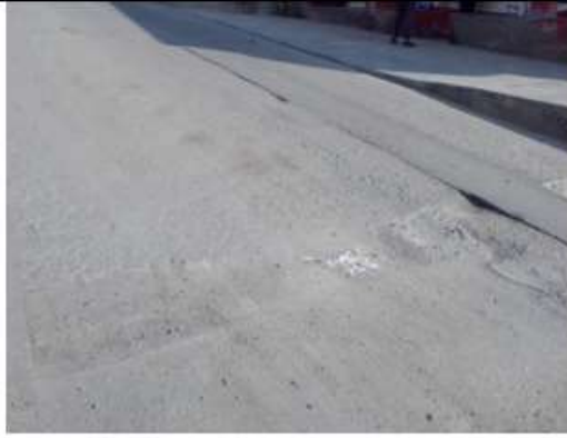
Identificación de falla de tipo Hundimiento con severidad Media .Se ubica con en la Unidad Muestral N° 8.
