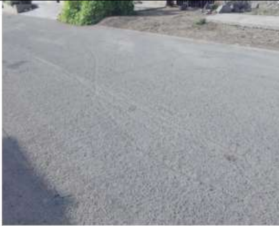
Identificación de falla de tipo Grieta con severidad Leve , con dimensiones de 2.16 m de Longitud .Se ubica con en la Unidad Muestral N° 1.
