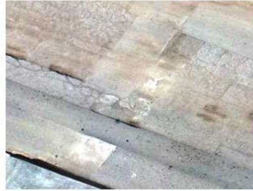
Identificación de falla de tipo Desprendimiento| de Agregado con severidad Media .Se ubica con en la Unidad Muestral N° 4.
