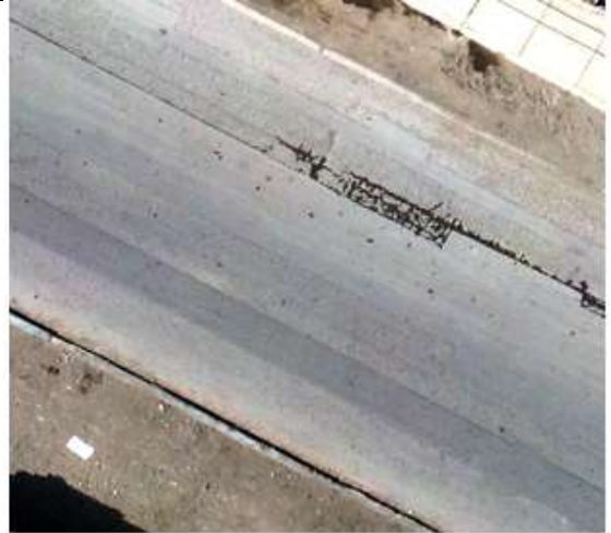
Identificación de falla de tipo Parche con severidad Leve .Se ubica con en la Unidad Muestral N° 10.
