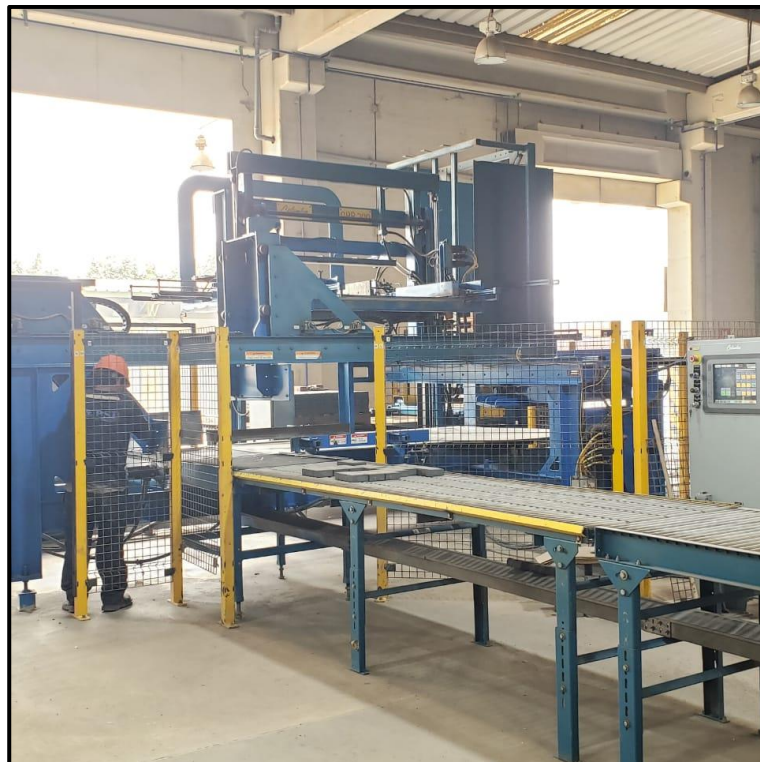
Figura 54. Inspección de componentes de la cubadora.
