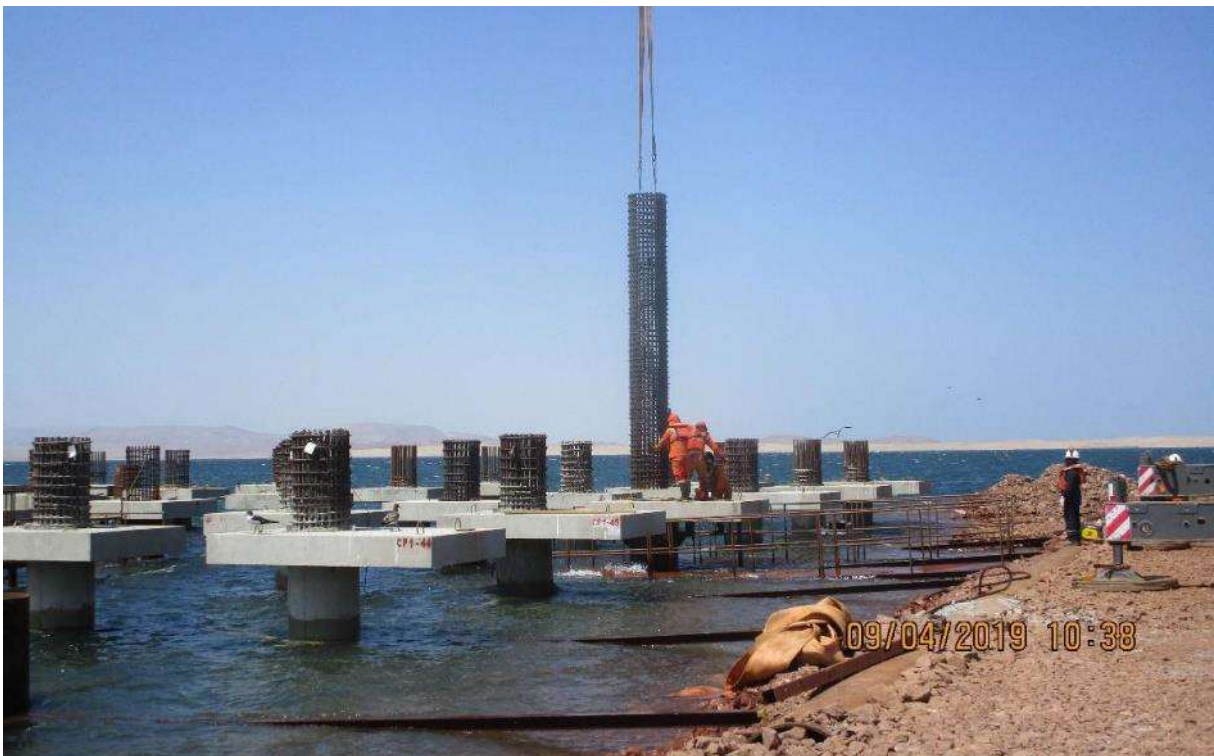
Figura 50. Habilitado de Estructura de Acero para Vaciado de Concreto Pilote. Fuente: Propia
