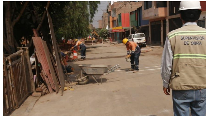
Figura 32 Corte con disco diamantado sobre la ventana de fragmentación y conexiones de alcantarillado.
