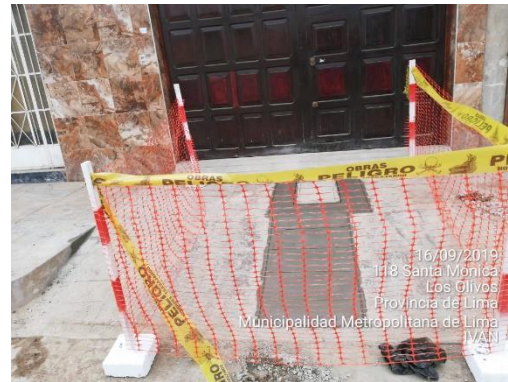
Figura 48 Relleno y compactación de base con material afirmado para tapado de zanja.
