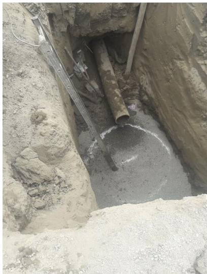
Figura 65 Salida de tubería de alcantarillado hacia la otra ventana de fragmentación.
