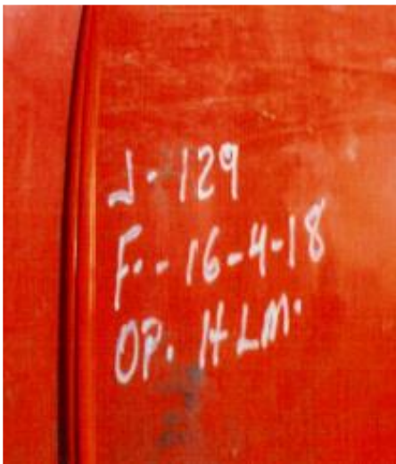
Figura 71 Junta de la tubería de HDPE, efecto de la termofusión.
