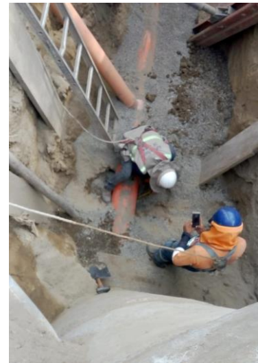
Figura 66 Tubería adosada al buzón.
