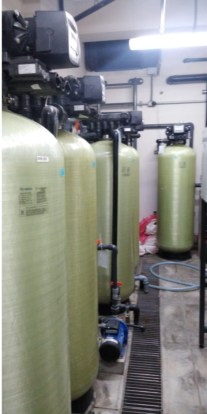
Foto 2. filtros para tratamiento de agua, Planta de tratamiento de agua del hospital de Alta complejidad Virgen de la Puerta, Trujillo - 2020
