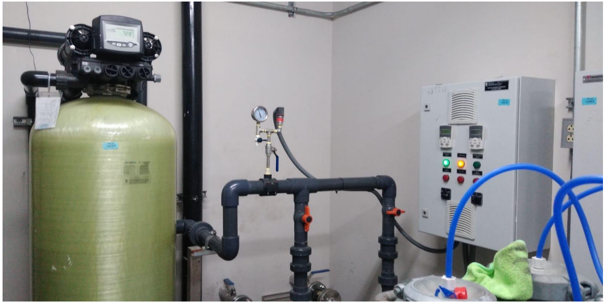
Foto 3. Tablero de Alternado de electrobombas, Planta de tratamiento de agua del hospital de Alta complejidad Virgen de la Puerta, Trujillo - 2020
