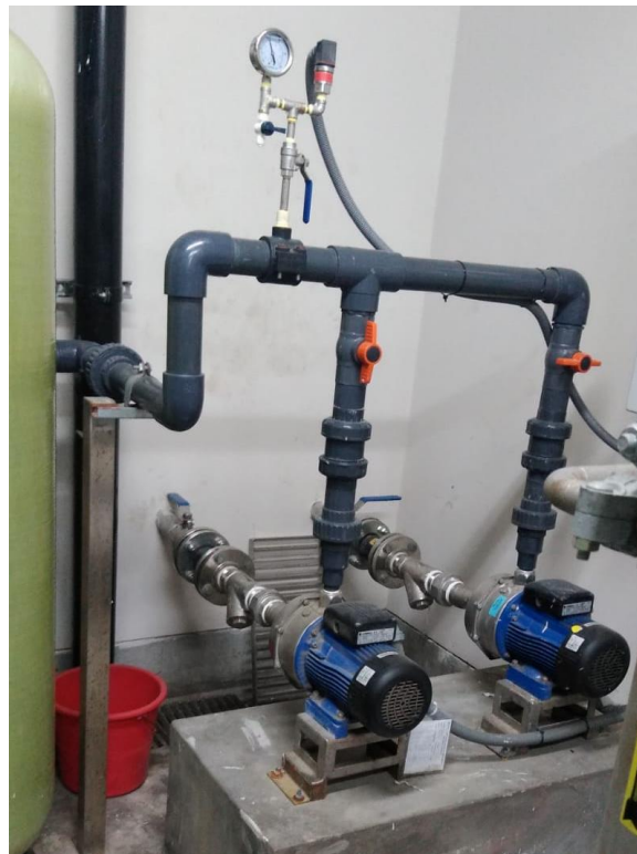
Foto 4. Electrobombas de 2.5 HP, Planta de tratamiento de agua del hospital de Alta complejidad Virgen de la Puerta, Trujillo - 2020
