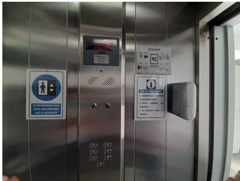
Señalización y expendedor de gel dentro del ascensor
