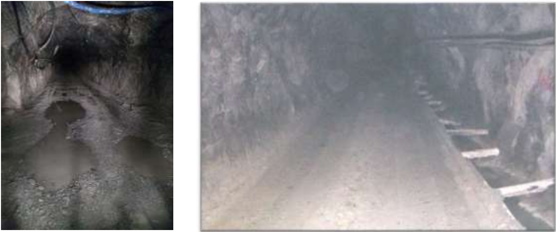
Figura 12. Vía con charcos de agua (lado izquierdo), mantenimiento de vías con ripeado y ribeteo de cunetas (lado derecho).
