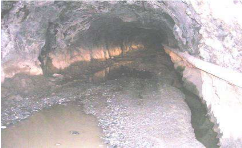
Figura 1. Vías de transporte en mal estado con huecos
