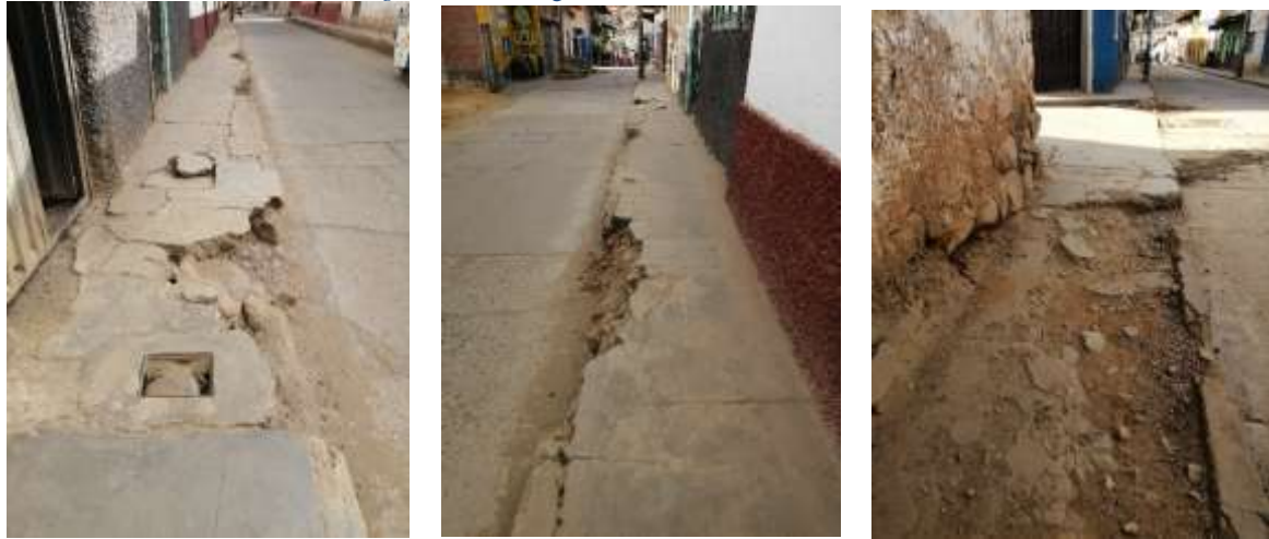
Figura 42. Daños generados en veredas de concreto
