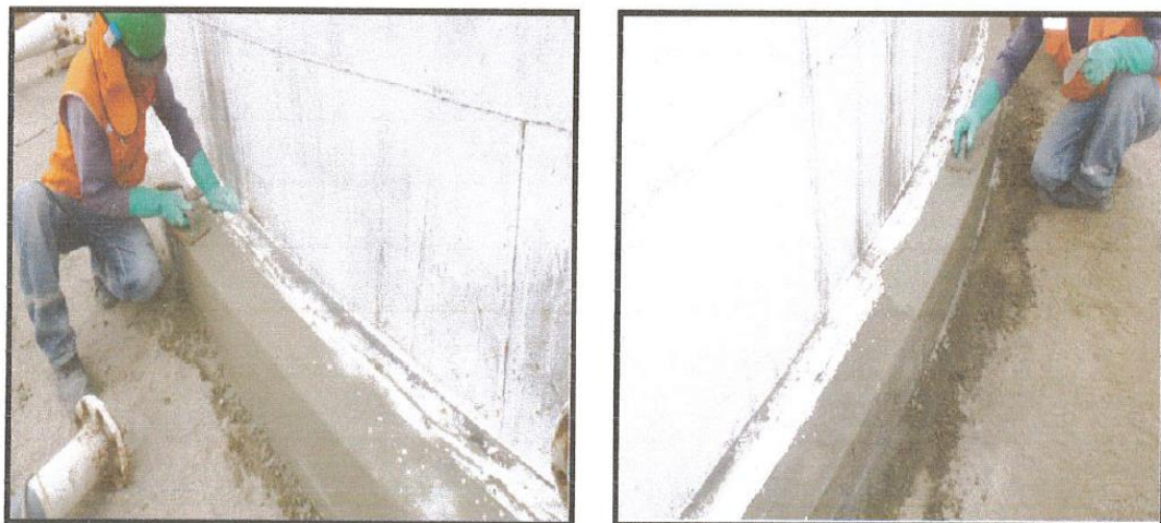
Trabajo de Resane en el Anillo de Concreto de los Tanques 3 y 14
