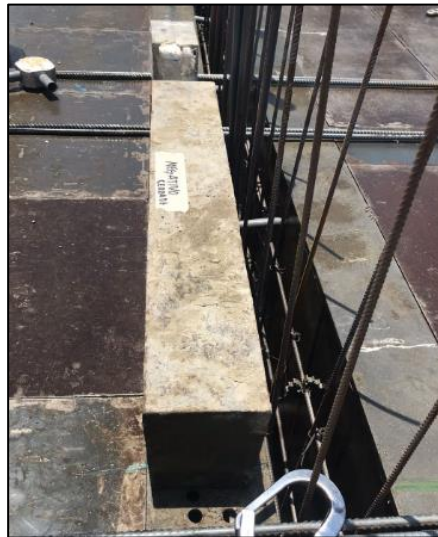
Figura 14: Negativos (NG). Fuente: Edificación Proyecto 01
