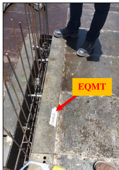
Figura 15: Cuchillas (EQMT). Fuente: Edificación Proyecto 01
