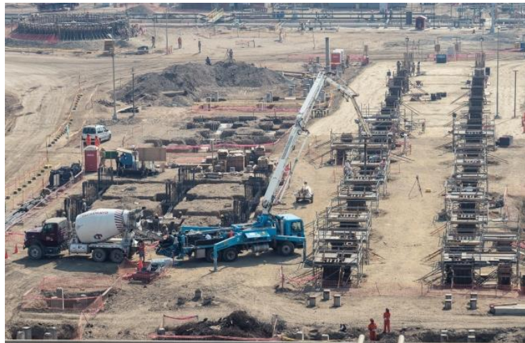
Figura 14. Vaciado de concreto en fundaciones. Modernización de refinería de Talara de Petroperú Fuente: (COSAPI, 2021)
