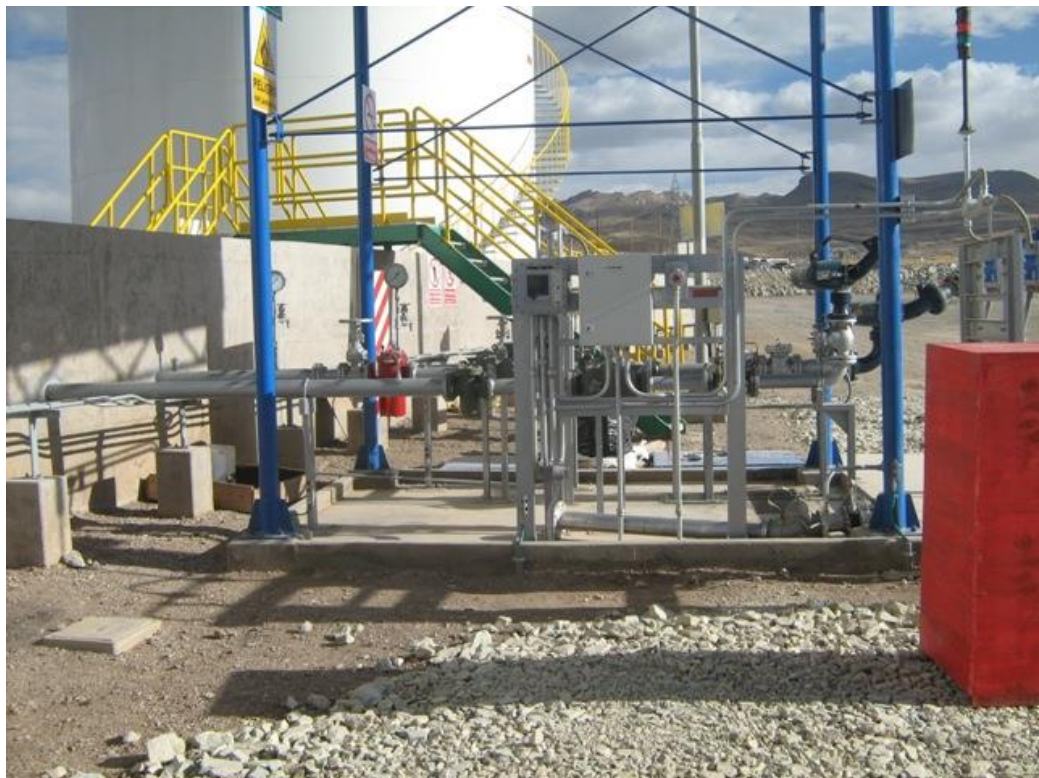
Figura 26. Proyecto Islas abastecimiento combustible. Cliente Minera Antapaccay, Espina - Cusco. Fuente: JYS Control Automation (2017)
