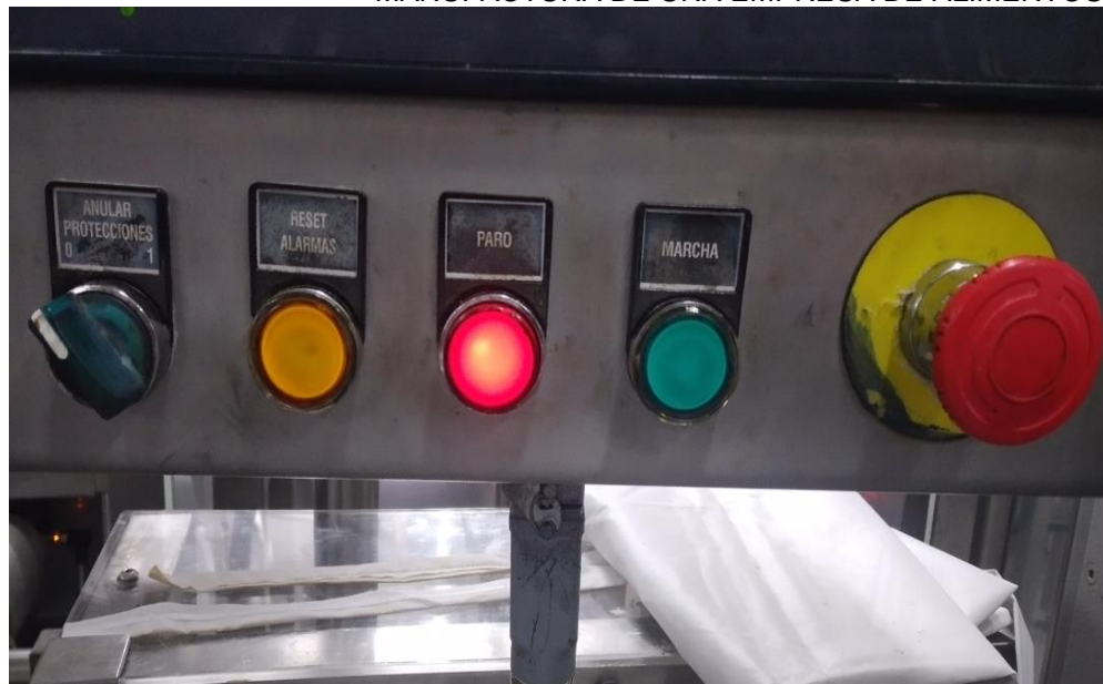
Figura 20. Ingreso manual de Aceite por botoneras. Cliente Alicorp S.A. Fuente: JYS Control Automation (2018)
