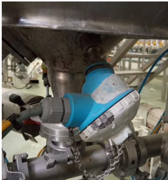
Figura 50. Transmisor de temperatura ubicado en tanque Premixer. Fuente: JYS Control Automation (2020)
