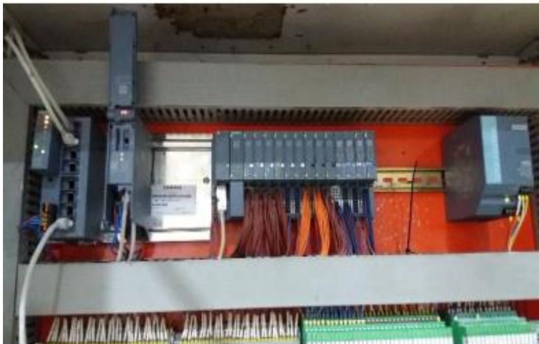
Figura 9. Tablero de control. Cliente Molitalia Planta Costa distrito los Olivos.
