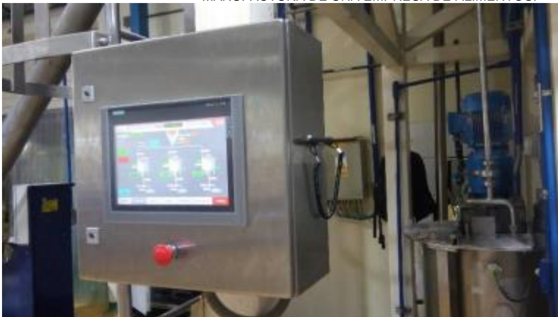
Figura 10. Panel táctil HMI. Cliente Molitalia Planta Costa distrito los Olivos.
