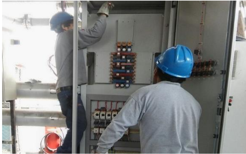
Figura 6. Instalación de tablero eléctrico. Cliente Baterías ETNA distrito de Independencia. Fuente: JYS Control Automation (2018)
