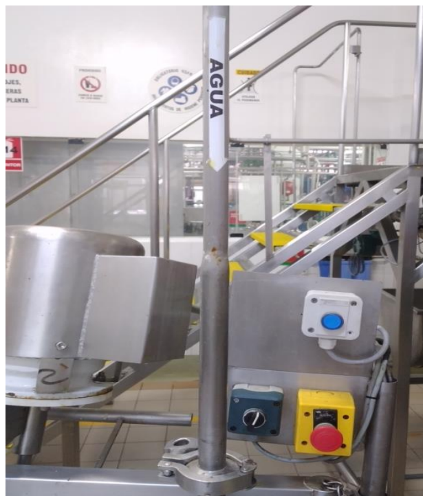
Figura 19. Ingreso manual de Agua por botoneras. Cliente Alicorp S.A. Fuente: JYS Control Automation (2018)
