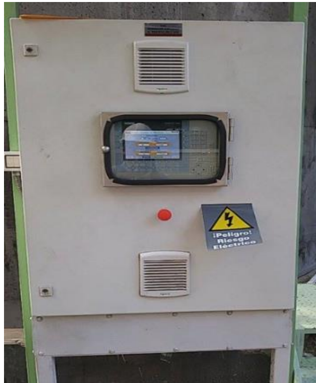
Figura 17. HMI de operación. Cliente Alicorp S.A. Fuente: JYS Control Automation (2019)
