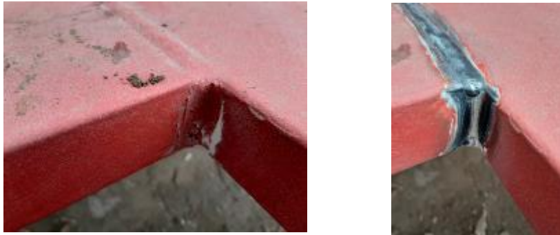
Figura 11. Defecto en el proceso de soldadura. Fue masillado. Fuente: IFLUTECH S.A.C. (2018).
