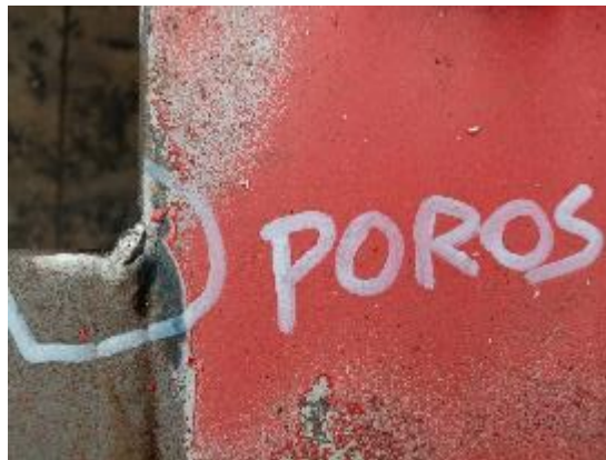
Figura 12. Defecto de soldadura. Poro. Fuente: IFLUTECH S.A.C. (2018).
