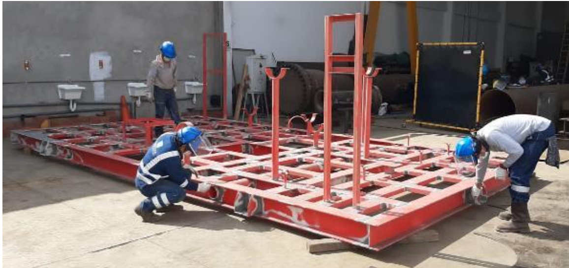
Figura 13. Limpieza de todos los cordones de soldadura para inspección. Reproceso. Fuente: IFLUTECH S.A.C. (2018).
