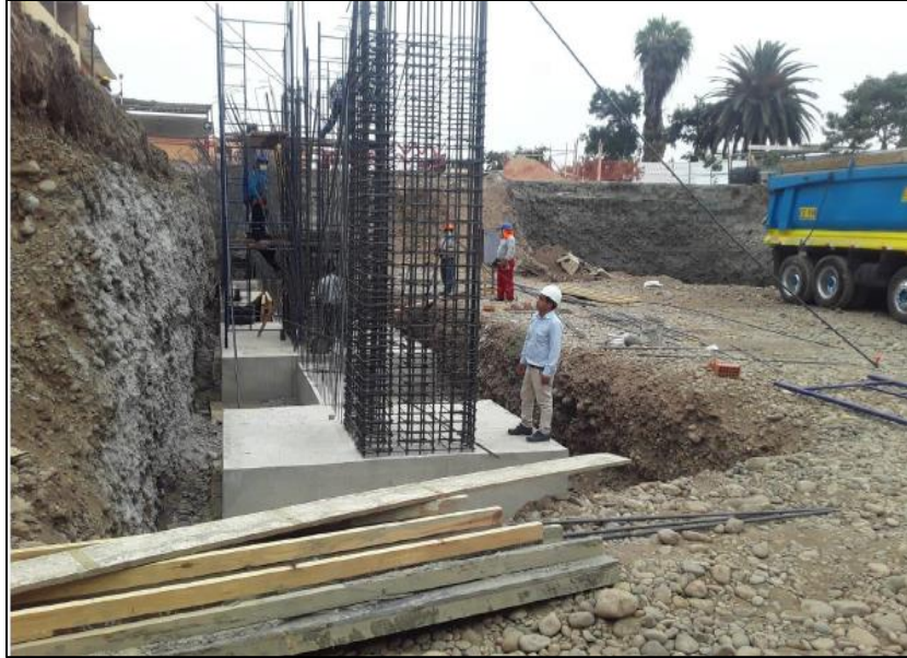
Figura 10: Exposición de acero de elemento vertical
