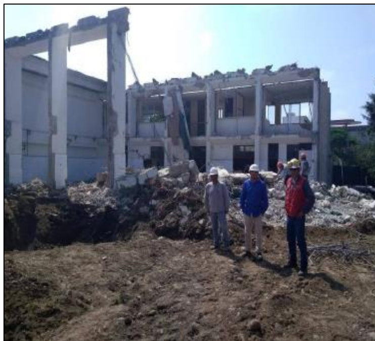
Figura 5. Demolición para ampliación de la planta piloto de alimentos de la Facultad de Química de la UNMSM
