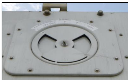
Figura N°28: Ventilador de reefer.
