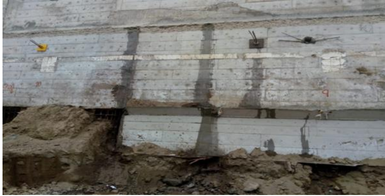
Figura 3. Filtración de agua a través de los muros anclados. Fuente: Propia
