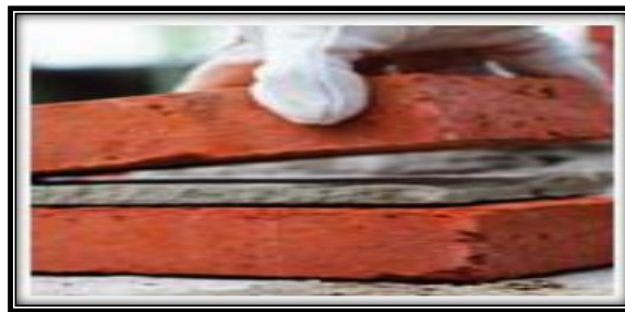
Figura 3. Falta de adherencia del mortero.
