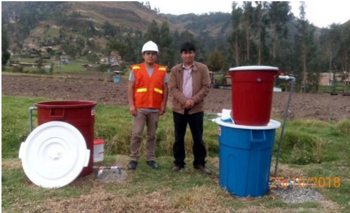
Figura 399. Inspección de campo por el asesor en la instalación del sistema de tratamiento convencional.
