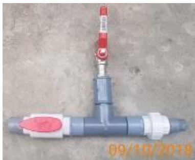
Figura 15. Tubería de salida del tanque dosador.
