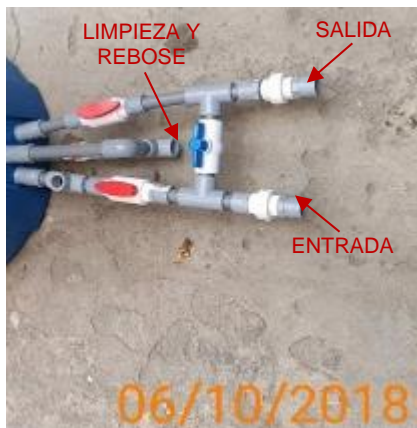
Figura 11. Tubería de entrada, salida, limpieza y rebose del tanque de almacenamiento.
