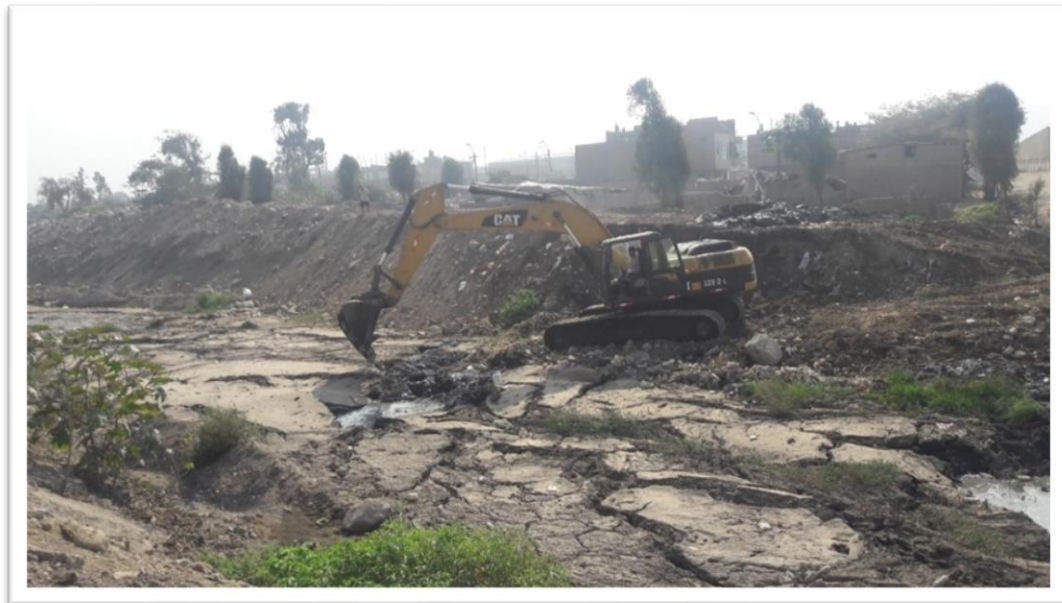
Figura 49. Formación de material contaminante (lodo) promedio de 1.50 – 2.00 mt de profundidad prog. 4+260 - 4+340.
