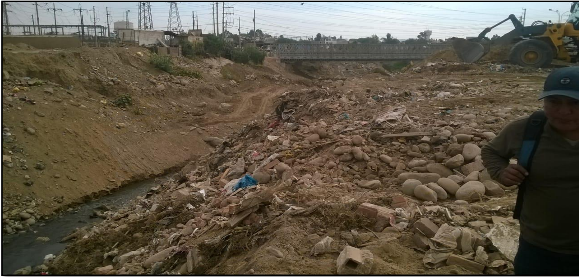
Figura N°: 24 Excesivo material contaminado el cual obstruye la circulación normal del cauce del río.
