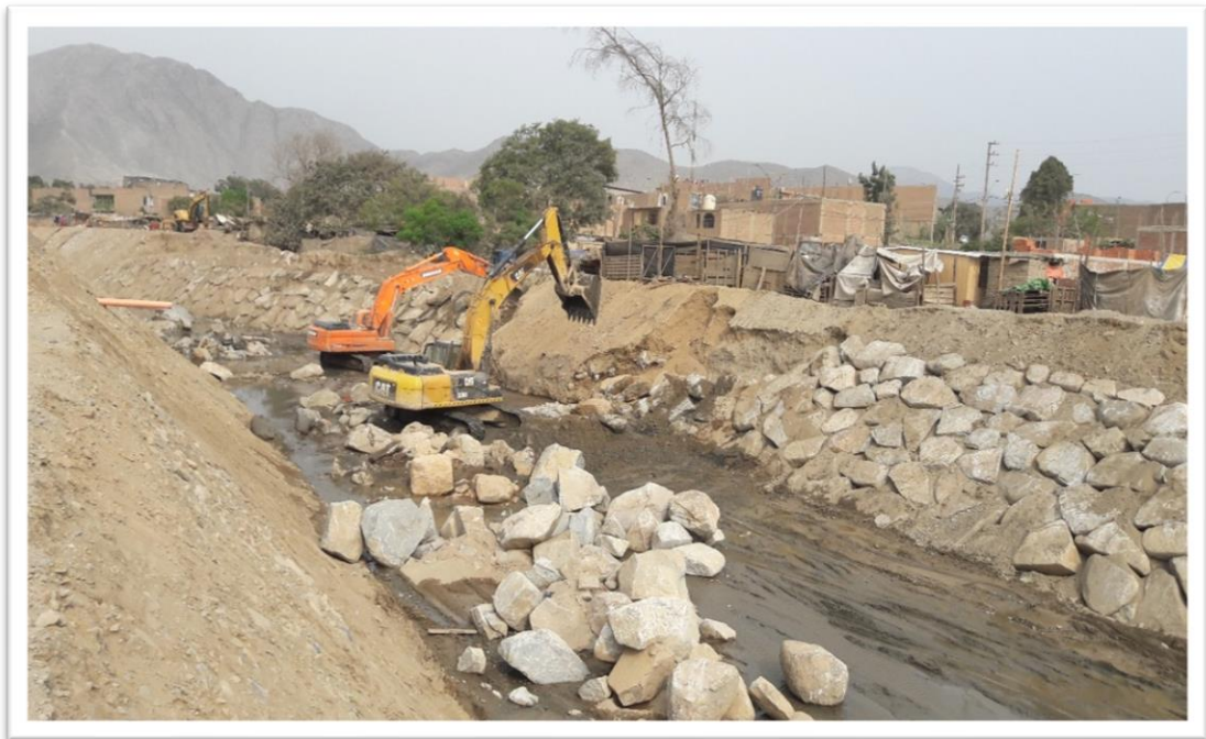
Figura 55. Enrocado en el margen izquierdo en la curva N°24 teniendo 120 ml desde la progresiva Km 3+720 al km 3+840
