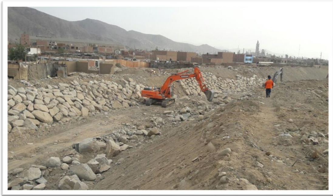
Figura 58. Nos encontramos realizando los trabajos de los 170 ml de enrocado en la progresiva Km 1+450 al 1+620
