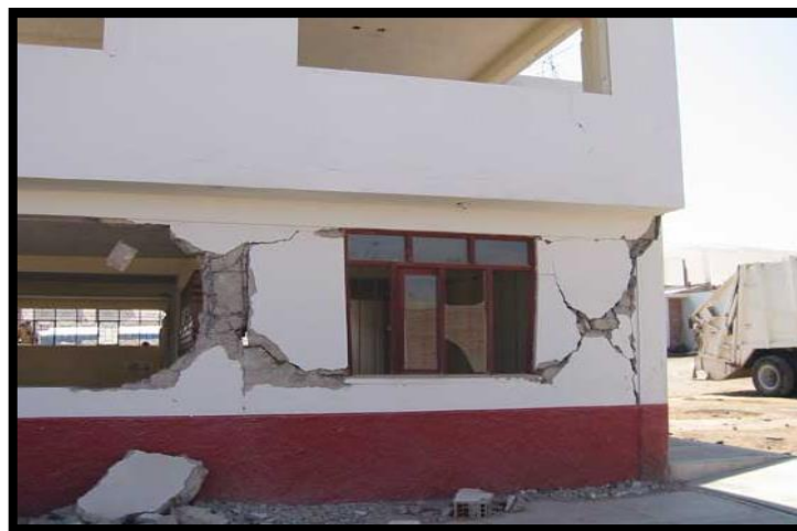
Figura 73. Daños estructurales a la municipalidad de Ciudad nueva en Tacna. Fuente DRM, 2001
