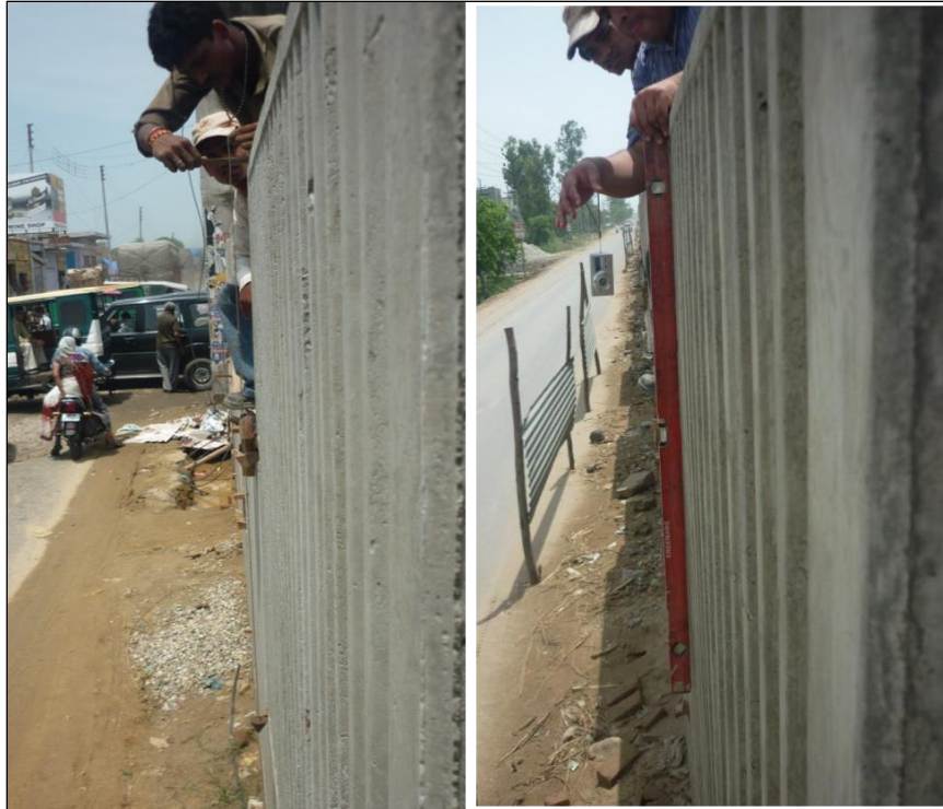
Figura 63. Inclinación de los paneles
