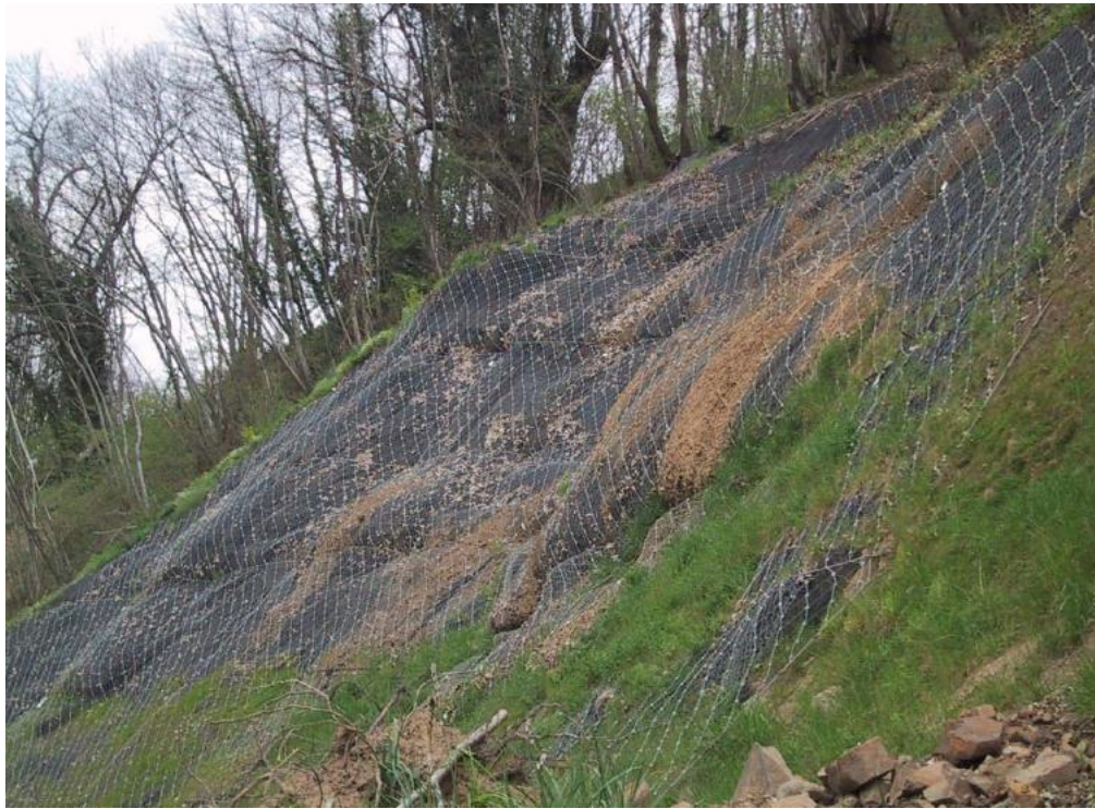
Figura 10. Membrana flexible anclada al terreno. Ejemplo de red de cables en un talud de suelo
