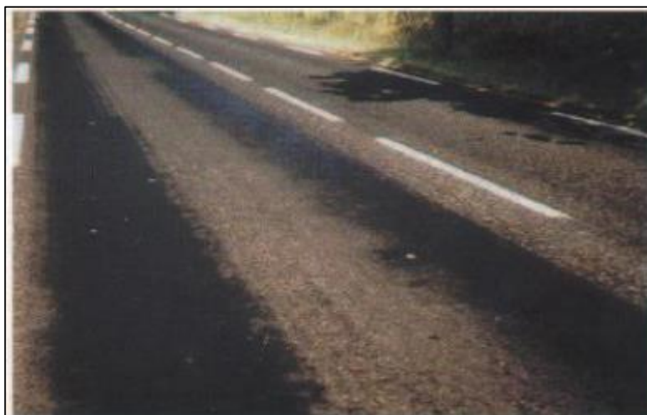
Figura 40 Falla tipo exudación en pavimento flexible en nivel de severidad alto Fuente: Manual de Carreteras Conservación Vial MTC (2013)
