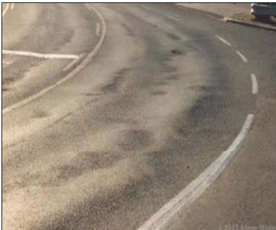
Figura 57 Falla tipo desplazamiento en pavimento asfáltico en nivel de severidad media. Fuente: Universidad Nacional de Ingeniería de Nicaragua (2010)
