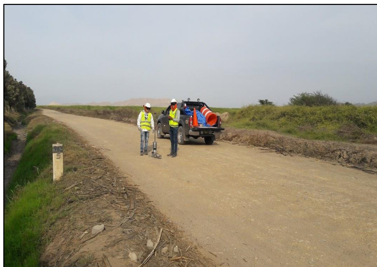
Figura 10 Trabajos de deflectometría Liviana en el tramo Laran- Pomalca para Geoconsult Fuente: Elaboración propia
