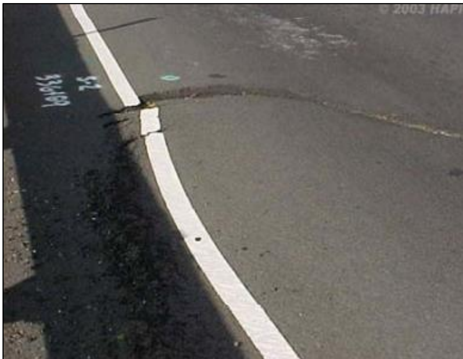
Figura 58 Fala tipo grieta parabólica en pavimento asfáltico en nivel de severidad media Fuente: Universidad Nacional de Ingeniería de Nicaragua (2010)
