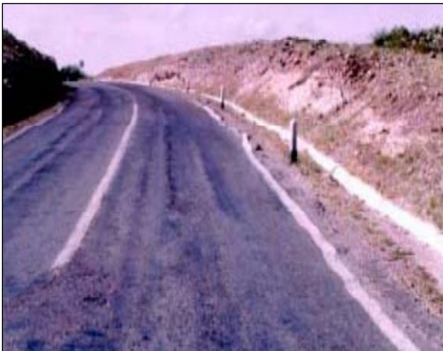
Figura 59 Falla tipo hinchamiento en pavimento asfaltico en nivel de severidad alta. Fuente: Universidad Nacional de Ingeniería de Nicaragua (2010)
