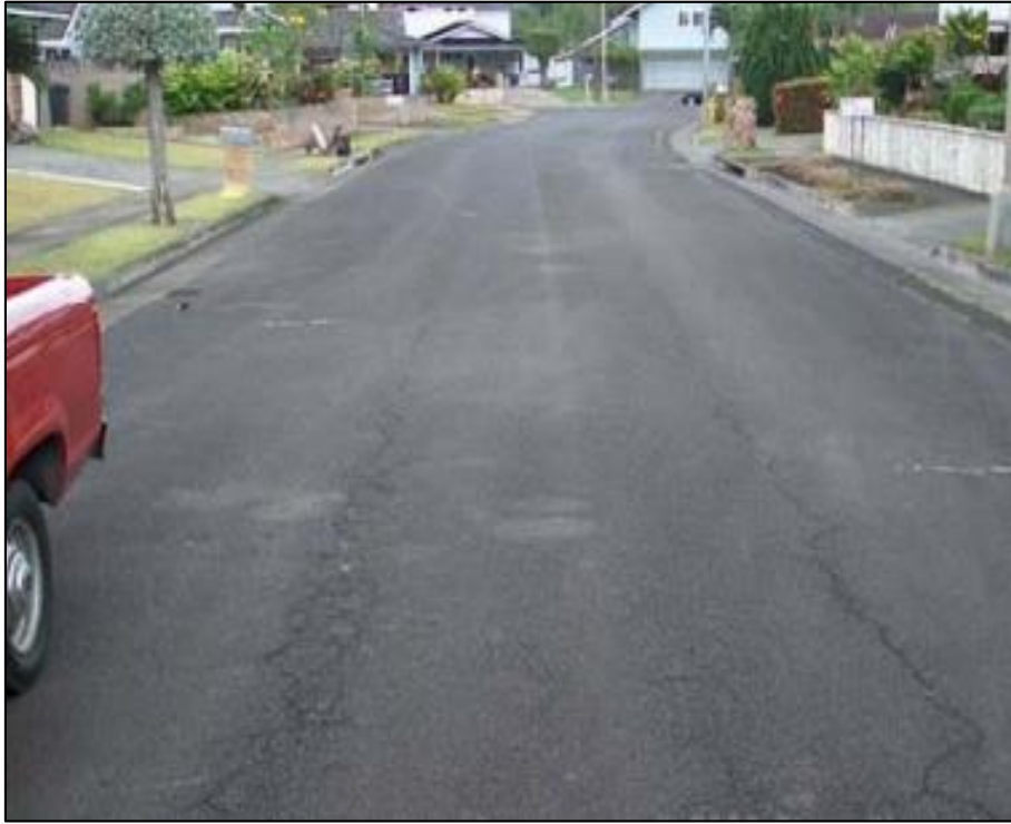
Figura 47 Fallas de grietas longitudinales y transversales en pavimento asfaltico con nivel de severidad media. Fuente: Universidad Nacional de Ingeniería de Nicaragua (2010)
