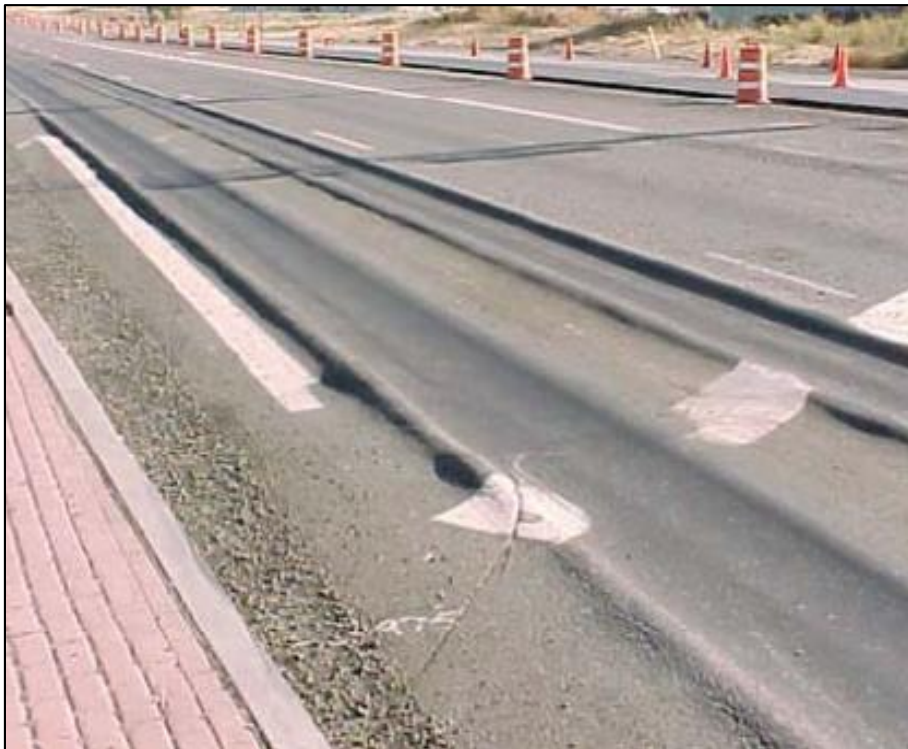
Figura 56 Falla tipo ahuellamiento en pavimento asfaltico en nivel de severidad alta . Fuente: Universidad Nacional de Ingeniería de Nicaragua (2010)
