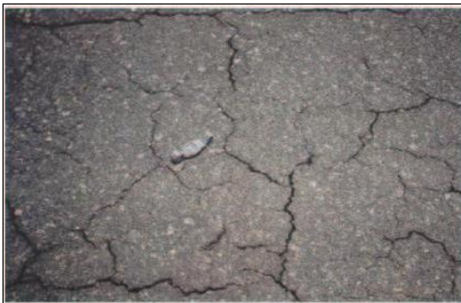
Figura 39 Falla tipo piel de cocodrilo en nivel de severidad media Fuente: Manual de Carreteras Conservación Vial MTC (2013)
