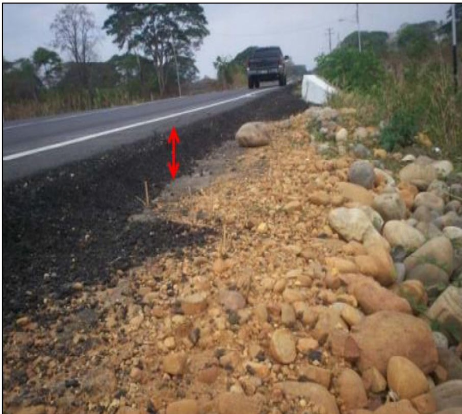
Figura 46 Falla tipo desnivel-carril en nivel de severidad alta. Fuente: Universidad Nacional de Ingeniería de Nicaragua (2010)
