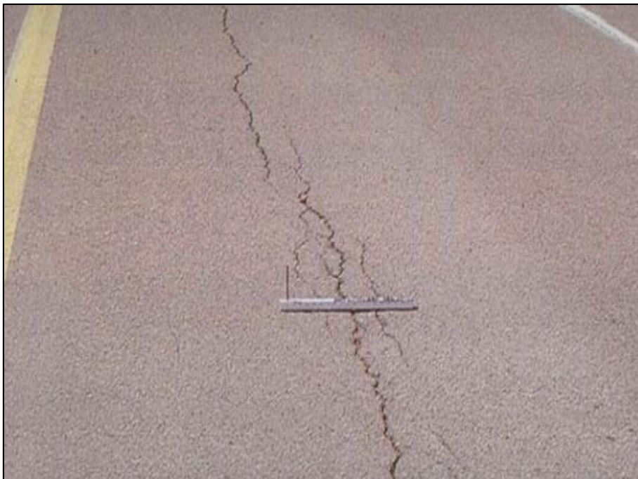
Figura 48 Fisura longitudinal en pavimento asfaltico en severidad alta. Fuente: Universidad Nacional de Ingeniería de Nicaragua (2010)
