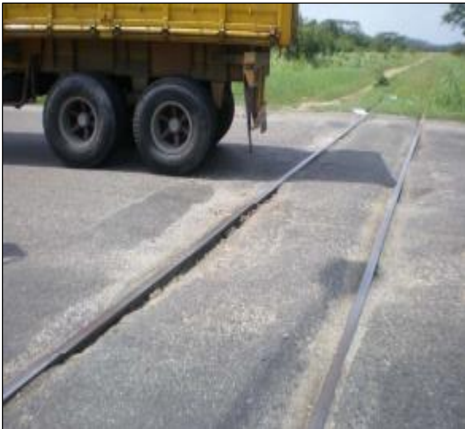
Figura 53 Falla tipo cruce de vía férrea en nivel de severidad media. Fuente: Universidad Nacional de Ingeniería de Nicaragua (2010)
