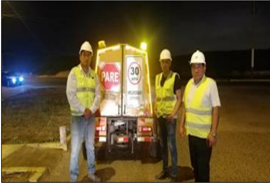
Figura 29 Evaluación estructural mediante el deflectómetro de impacto FWD en la Av. Santa Rosa – Callao, en esta imagen se tomó con los 02 ingenieros, uno por parte de la empresa concesionaria y la otra parte de supervisión. Fuente: Elaboración propia
