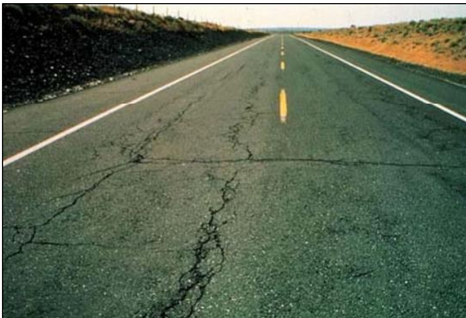
Figura 41 Falla de agrietamiento en bloque en nivel de severidad media Fuente: Universidad Nacional de Ingeniería de Nicaragua (2010)
