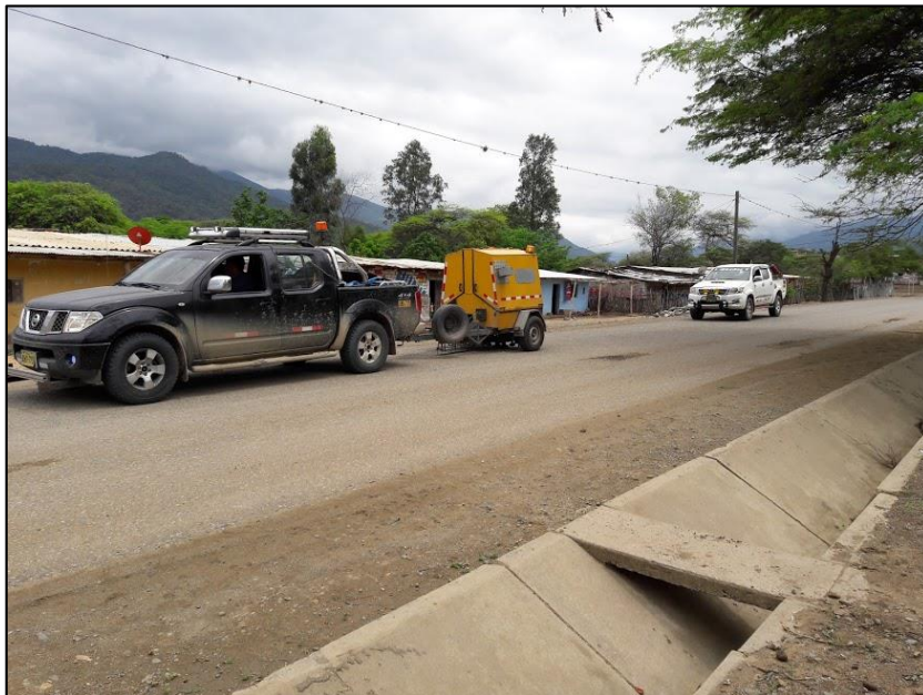
Figura 20 Trabajos de evaluación estructural mediante el deflectómetro de impacto FWD en el tramo Paimas – Pampa de Lobos para la empresa IHACSAC Fuente: Elaboración propia
