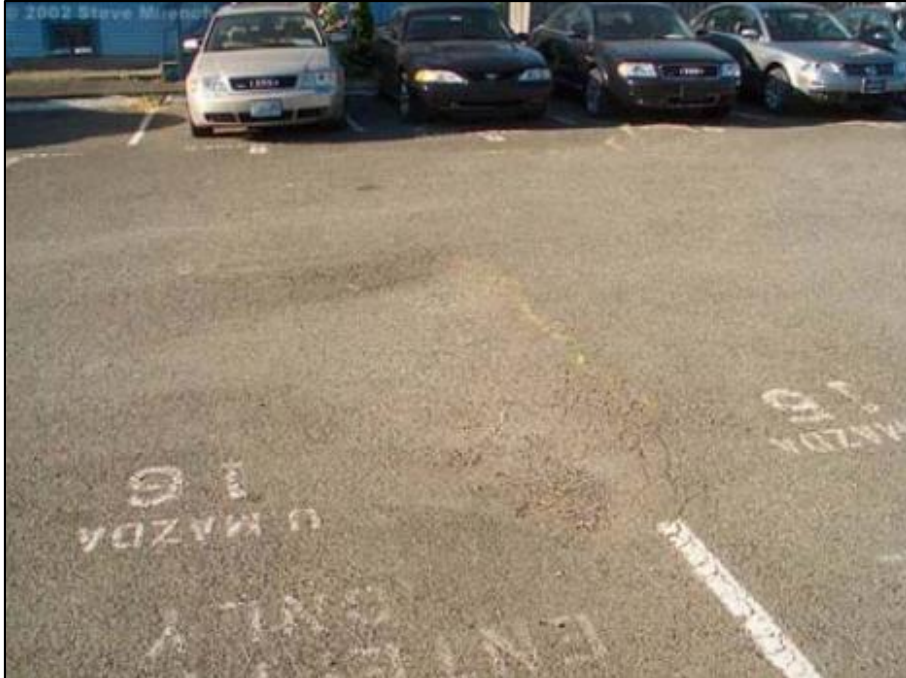
Figura 42 Falla de hundimiento en nivel de severidad media Fuente: Universidad Nacional de Ingeniería de Nicaragua (2010)
