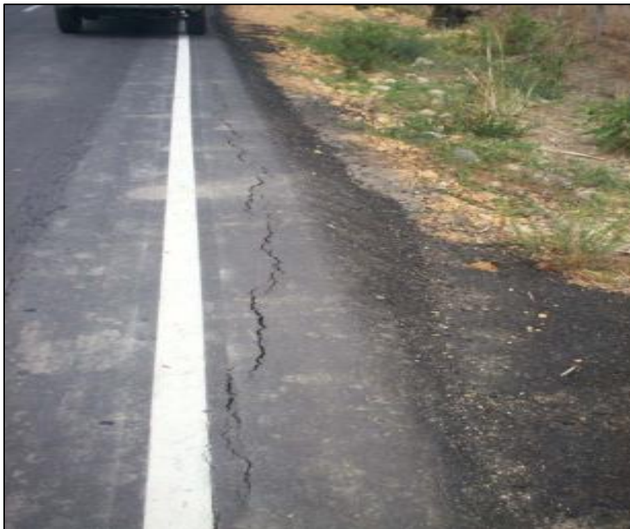
Figura 44 Fallas en grietas de borde en nivel de severidad media. Fuente: Universidad Nacional de Ingeniería de Nicaragua (2010)
