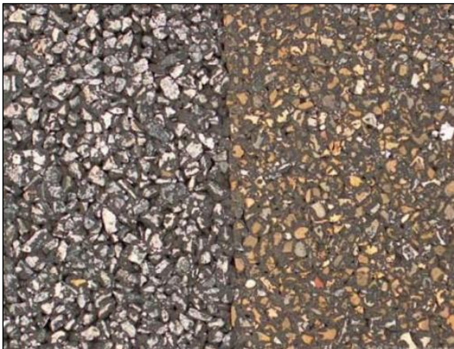
Figura 50 Falla tipo agregado pulido en pavimentos asfálticos. Fuente: Universidad Nacional de Ingeniería de Nicaragua (2010)
