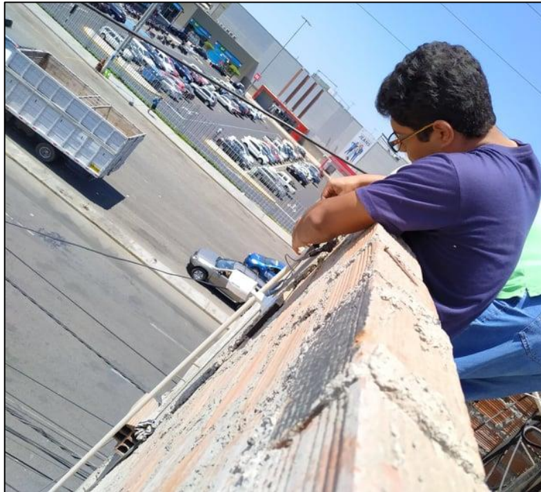
Figura 14. Proceso de Instalación de las cámaras de videograbación
