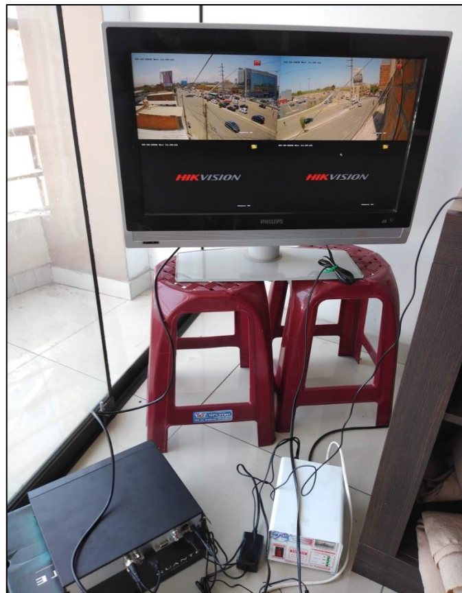
Figura 15. Sistema final de videograbación instalado
