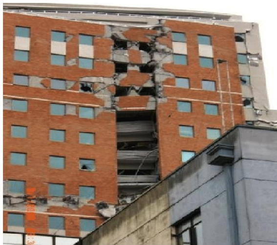
Figura 1.2. Edificio O'Higgins – Terremoto Chile 2010.
