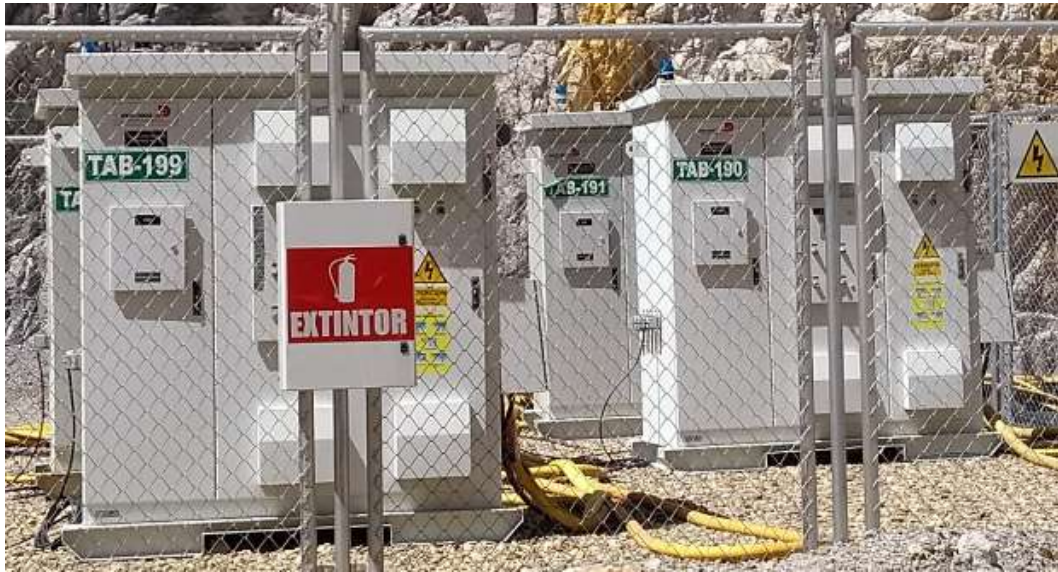
Figura 8: Detalle de partes Tablero de control Eléctrico
