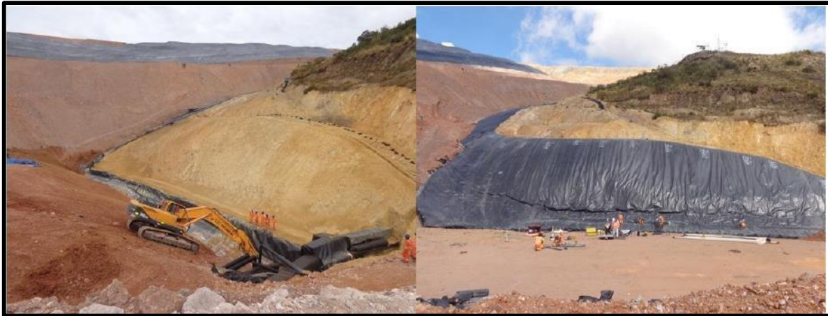
Figura 6. PAD Estribo Norte en la Minera Barrick Misquichilca Jangas en Ancash.
