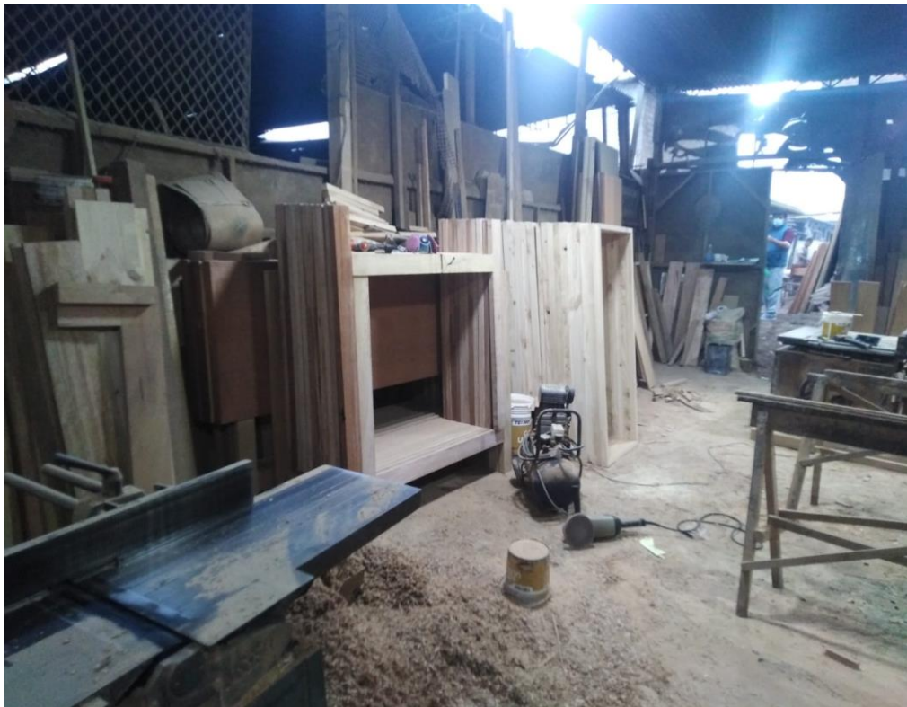
Figura 25. Compresora de aire nueva, instalada en el área de acabados.
