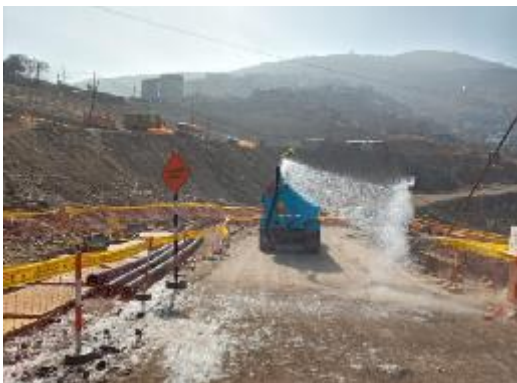
Fig. 4 Riego en Av. Unión en el tramo de CE-18 a CE-19
