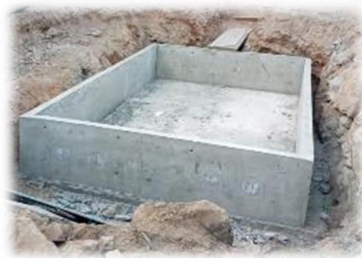
Fig. 3 Cámara de empalme N°18
