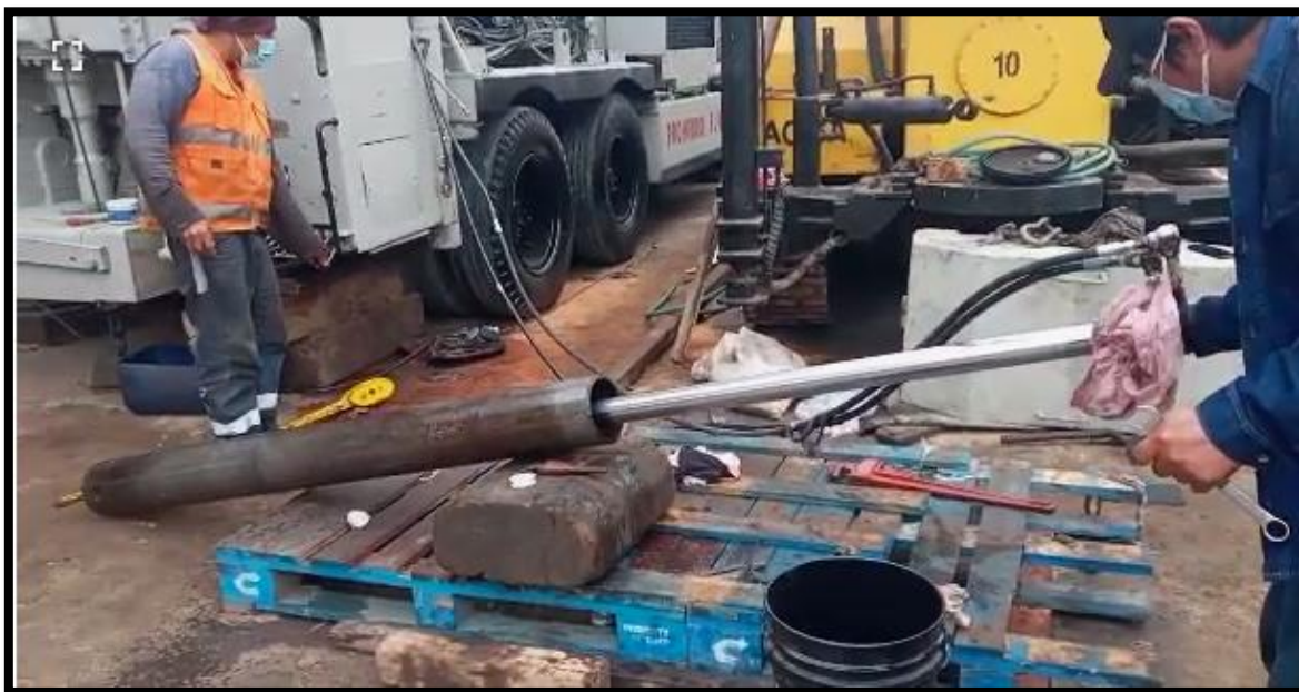
Mantenimiento preventivo a los pistones hidráulicos de la maquina rotaria antes de salir a obra.
