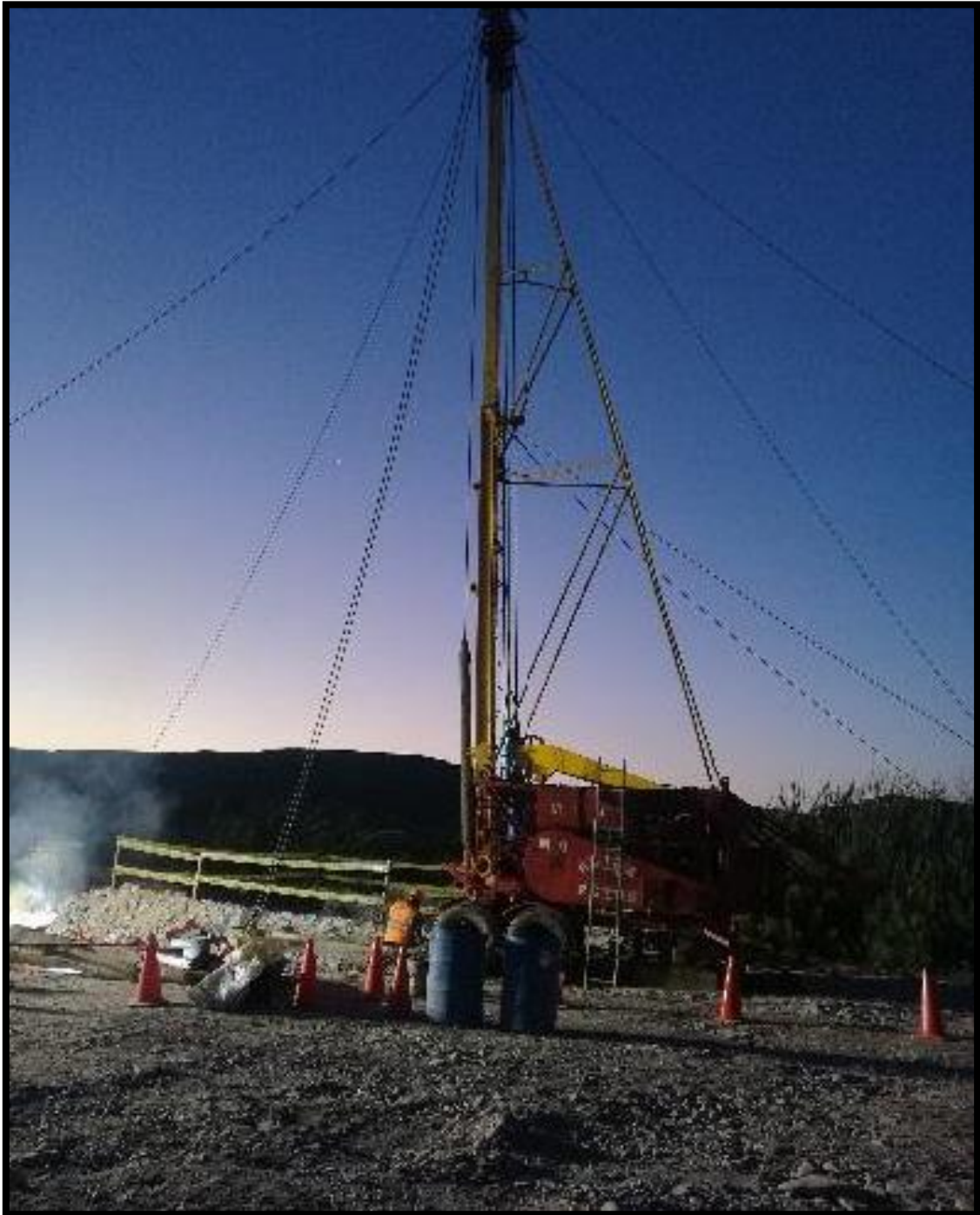
Perforación de piezómetros para el control del volumen del agua en el subsuelo – consorcio Callao - Lima
