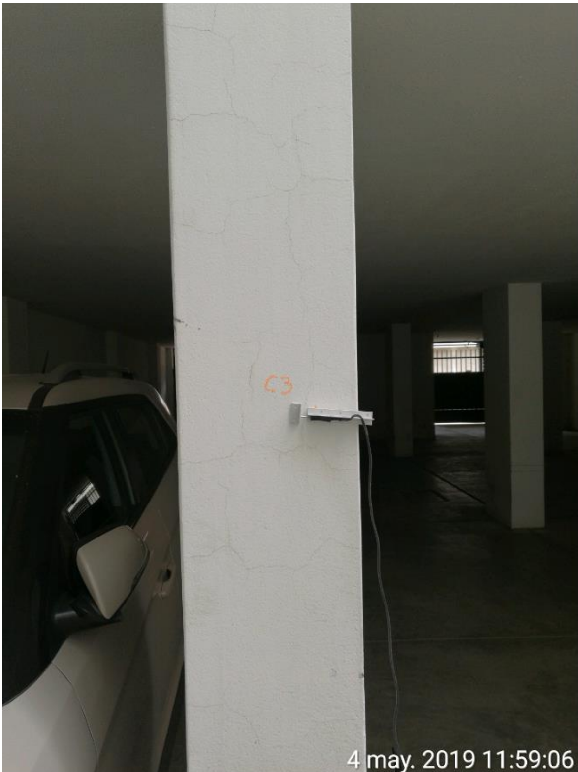
Fotografía 63: Fisura 03 en Columna de Estacionamiento, Zona Común.
