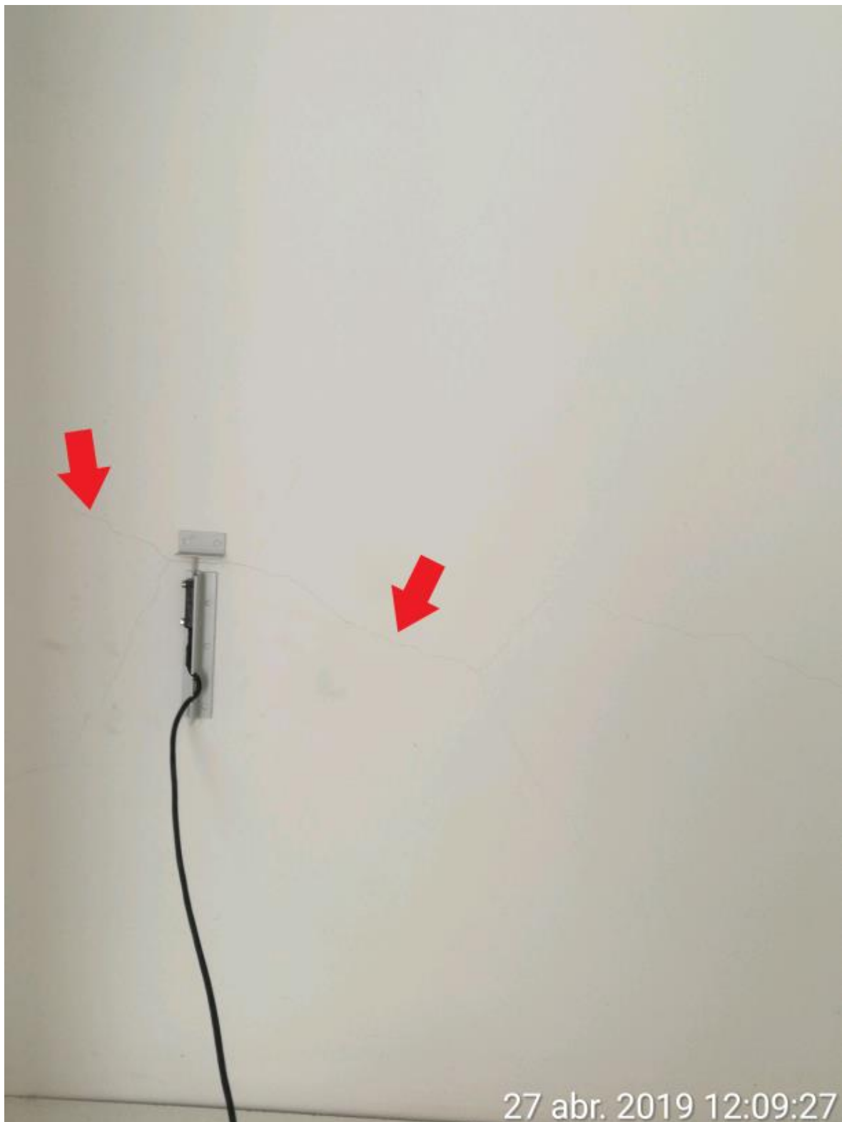
Fotografía 31: Fisura en Respaldo de Closet en Dormitorio 03, Departamento 502
