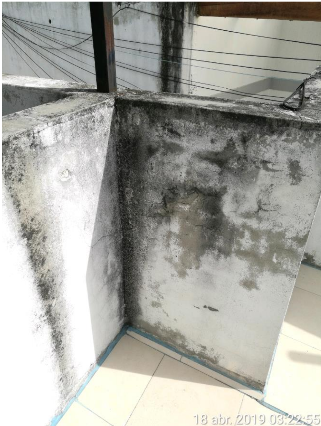
Fotografía 111: Humedad en parapetos.
