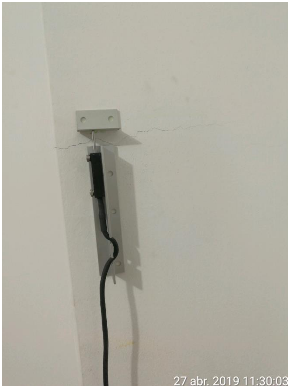
Fotografía 25: Fisura en Columna 01 de Dormitorio 02, Departamento 502
