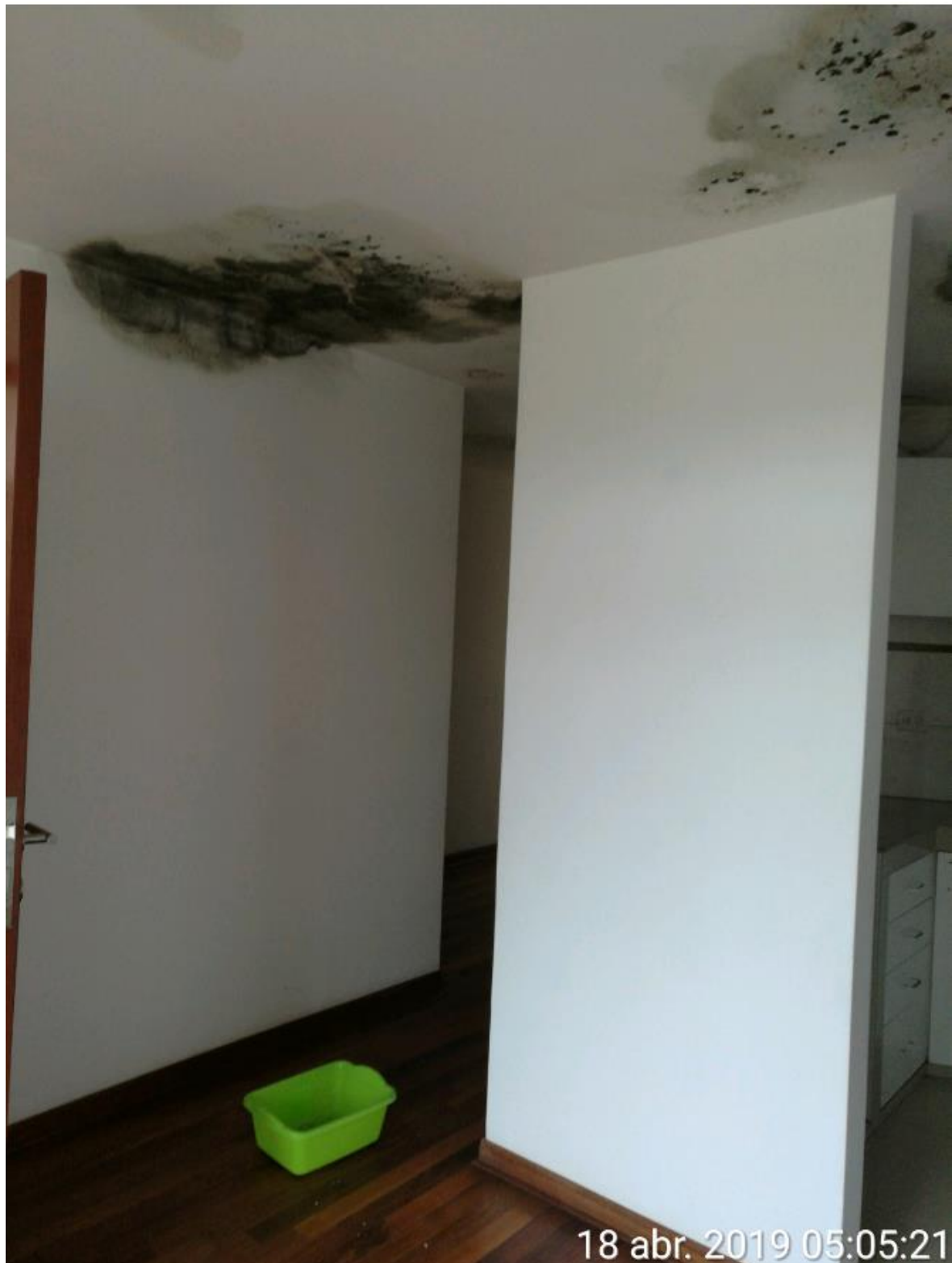
Fotografía 113: Filtración de Agua en departamento 502.
