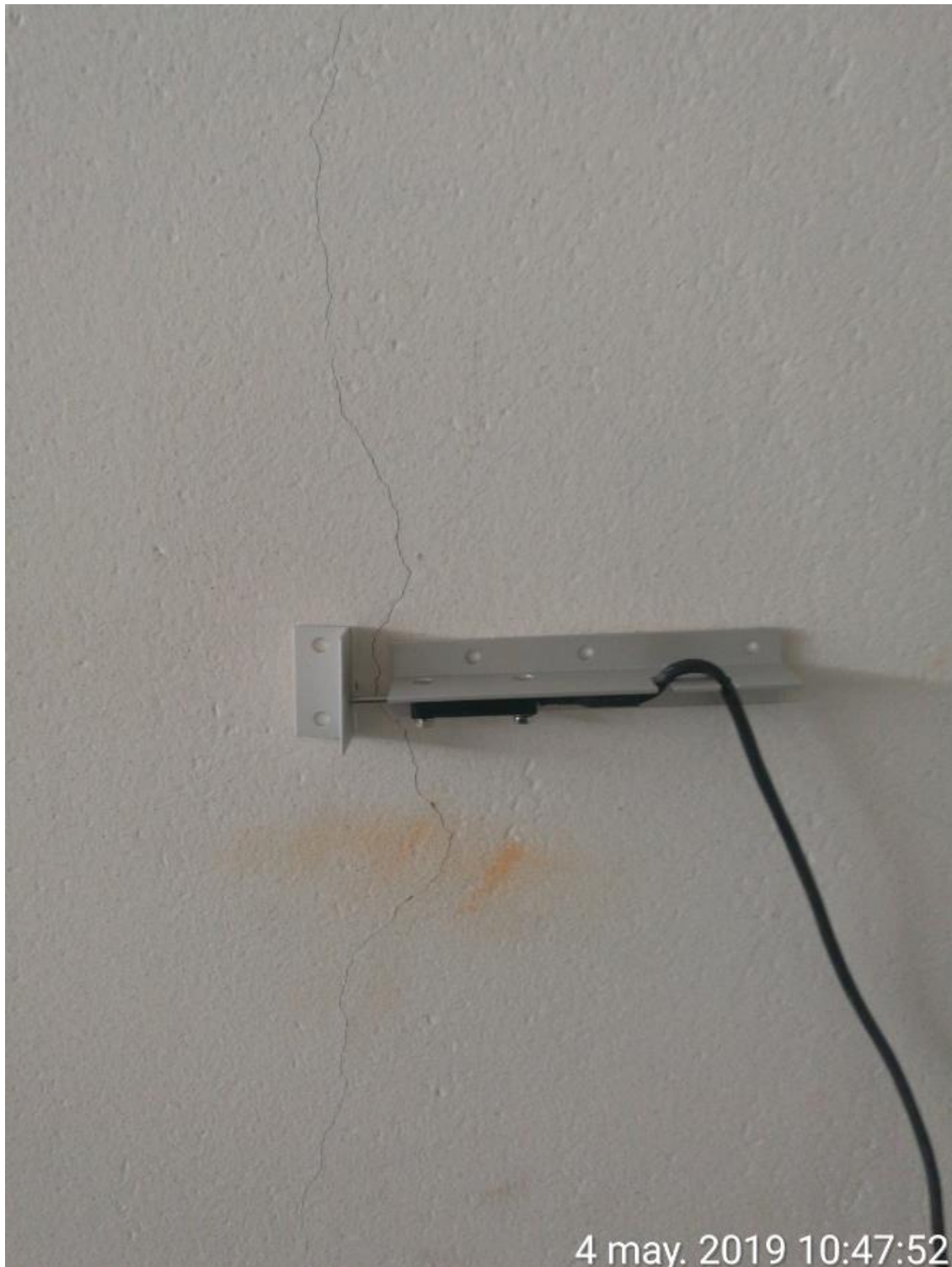
Fotografía 50: Fisura 01 en Pared de Estacionamiento, Zona Común.
