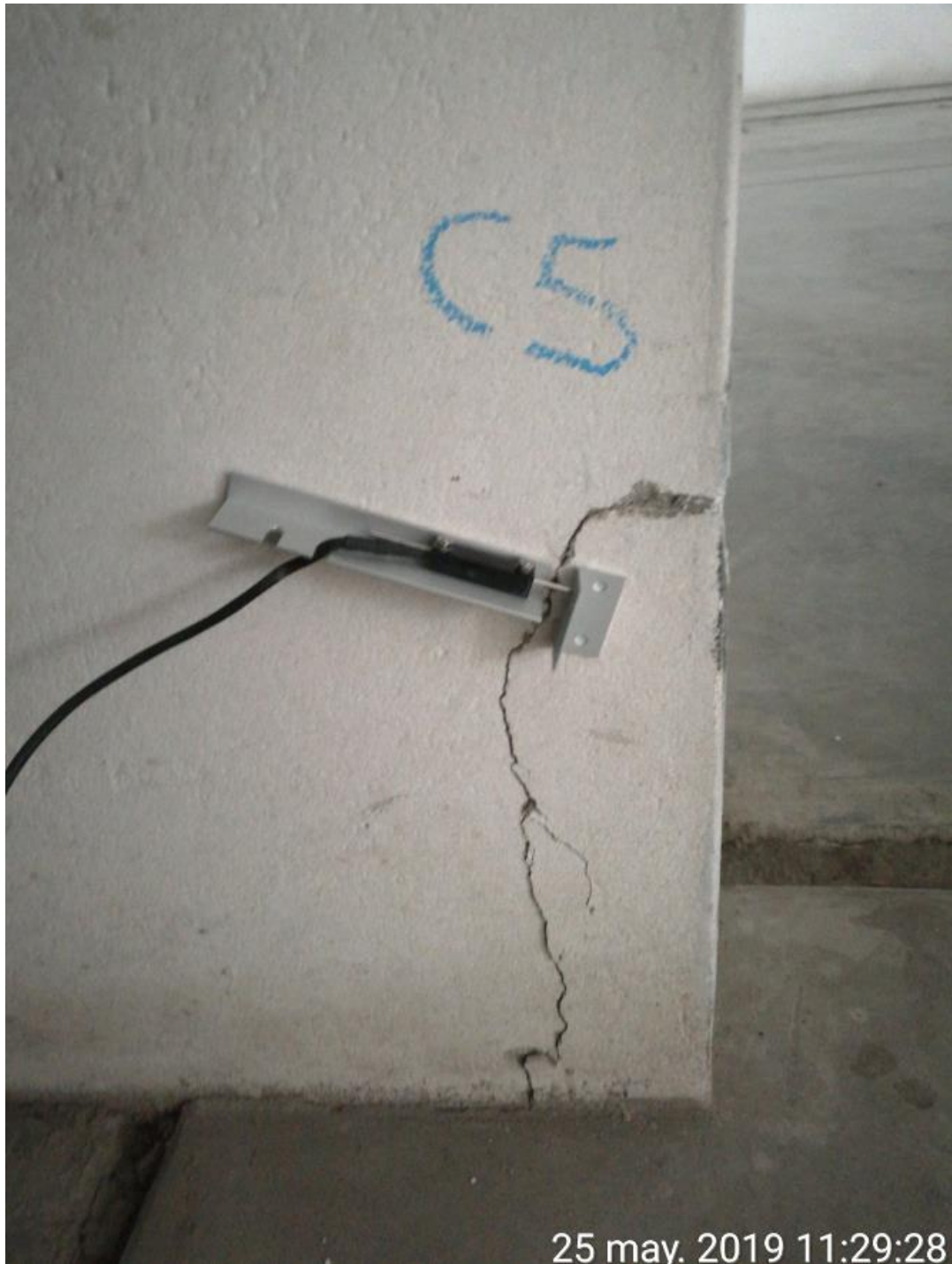
Fotografía 74: Fisura 05 en Columna de Estacionamiento, Zona Común.
