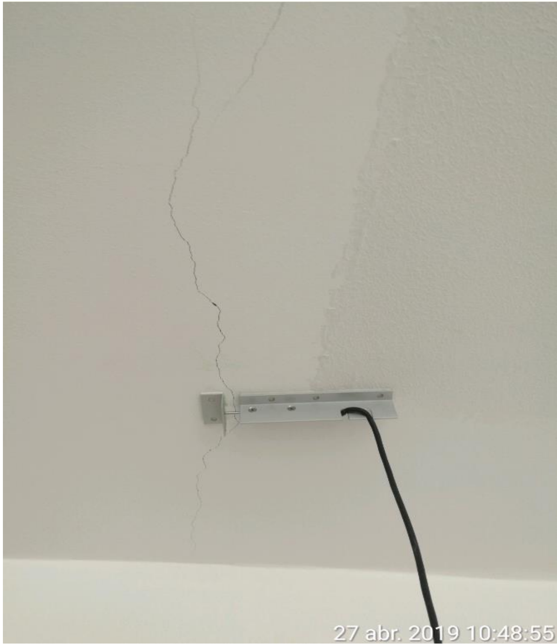
Fotografía 20: Fisura en Losa de Dormitorio 01, Departamento 502
