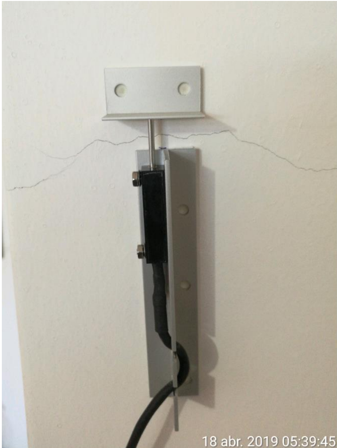
Fotografía 13: Fisura en Columna de Sala - Comedor, Departamento 502.
