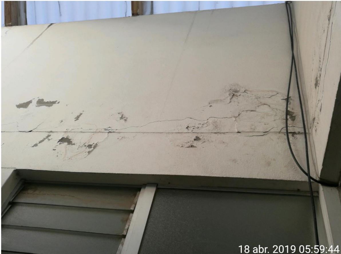
Fotografía 105: Fisuras en Ductos.
