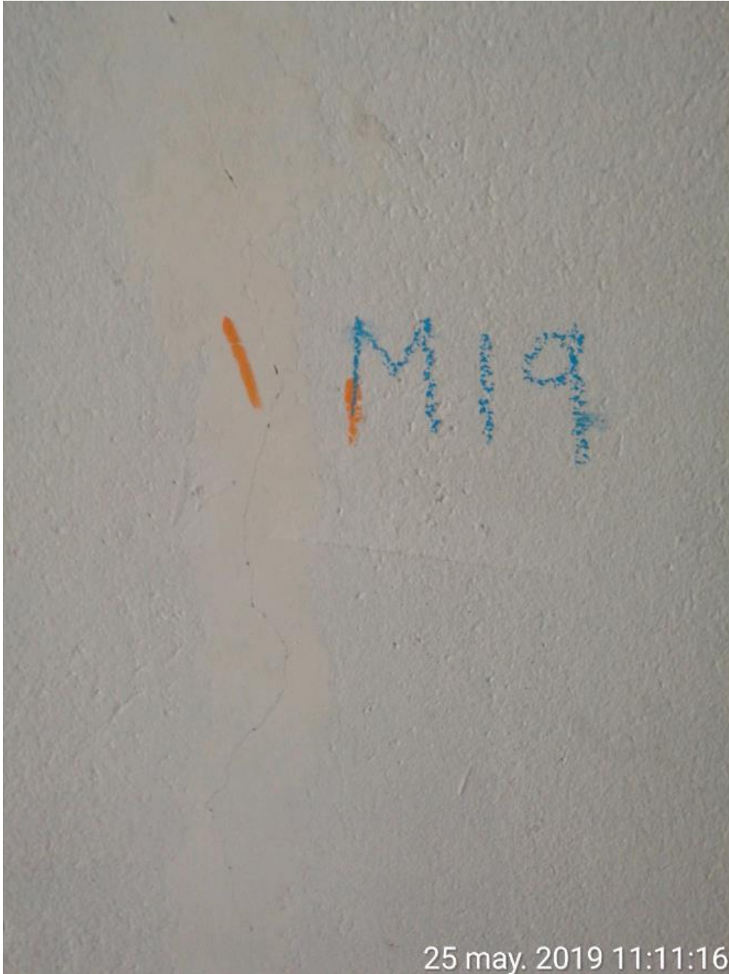
Fotografía 70: Fisura 19 en Muro de Estacionamiento, Zona Común.
