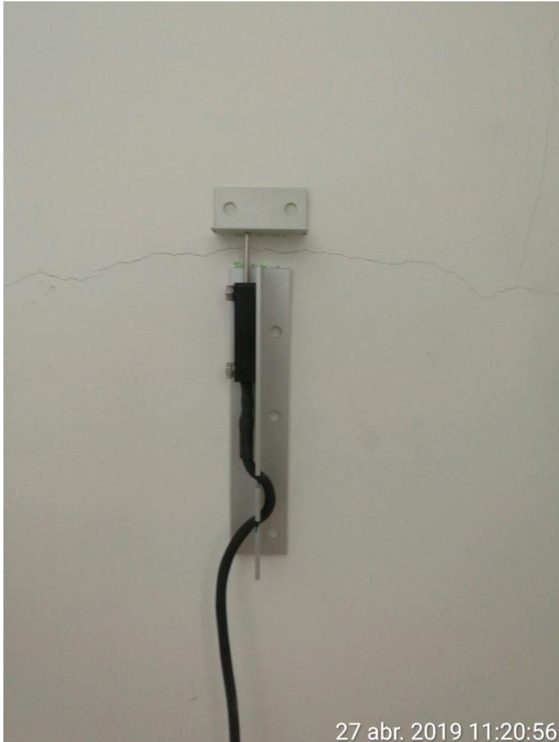
Fotografía 27: Fisura en Columna 02 en Dormitorio 02, Departamento 502
