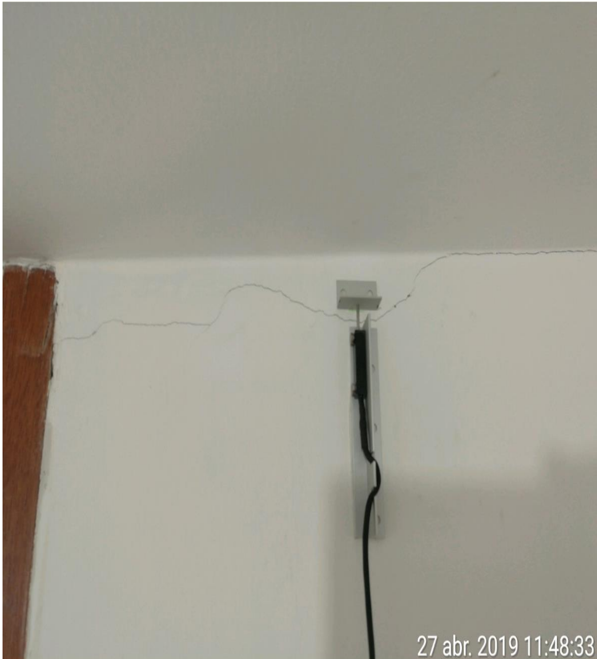
Fotografía 26: Fisura en Puerta de Baño en Dormitorio 02, Departamento 502
