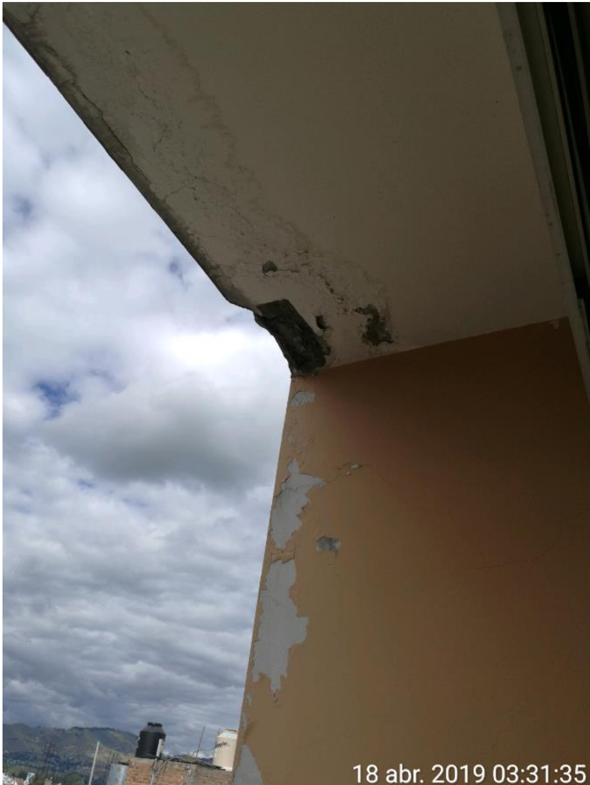
Fotografía 112: Desprendimiento de concreto en voladizo.
