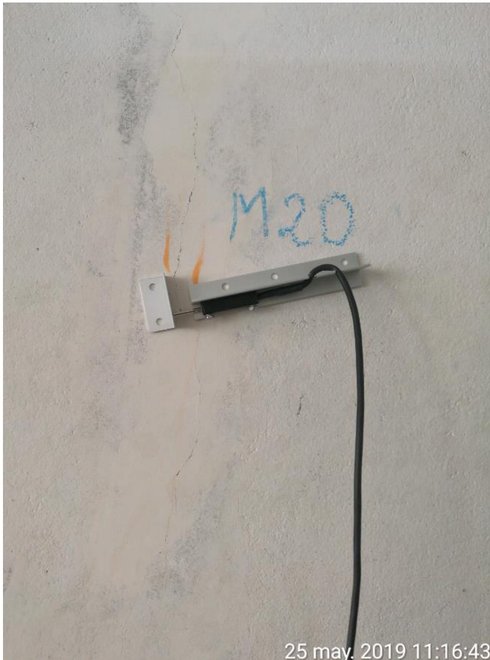
Fotografía 71: Fisura 20 en Muro de Estacionamiento, Zona Común.
