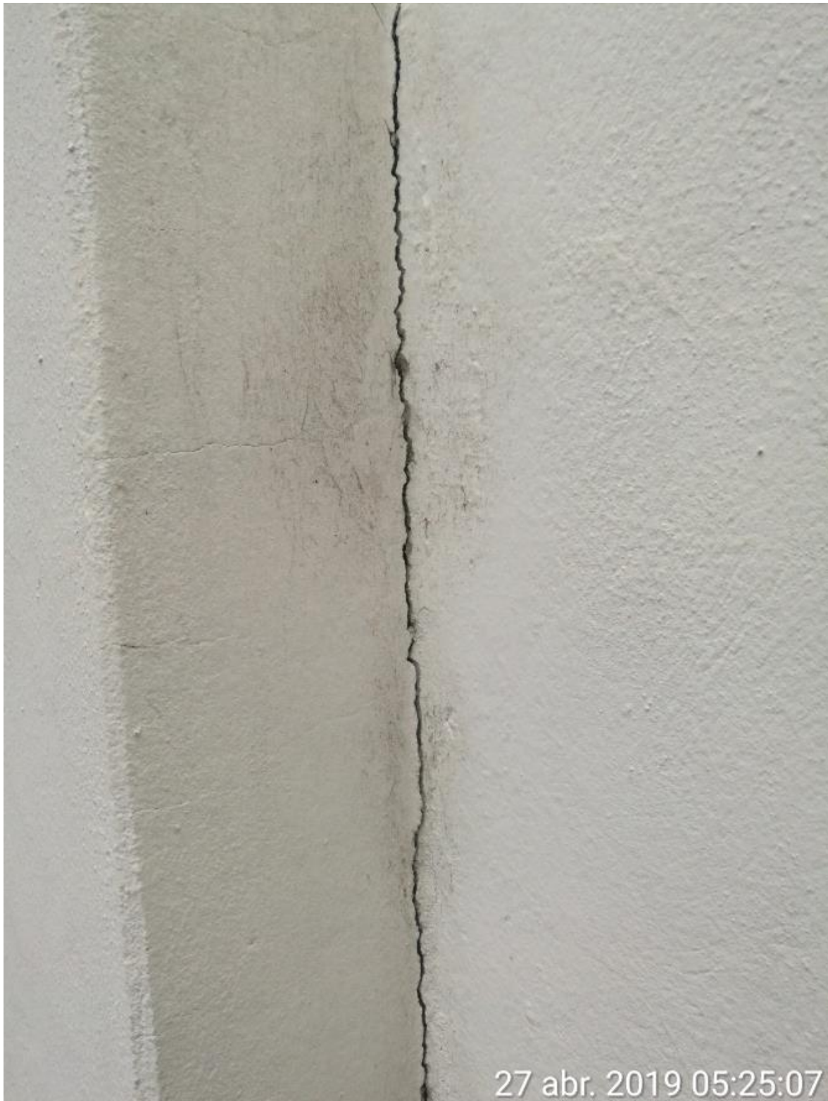
Fotografía 109: Grieta entre columna y muro.
