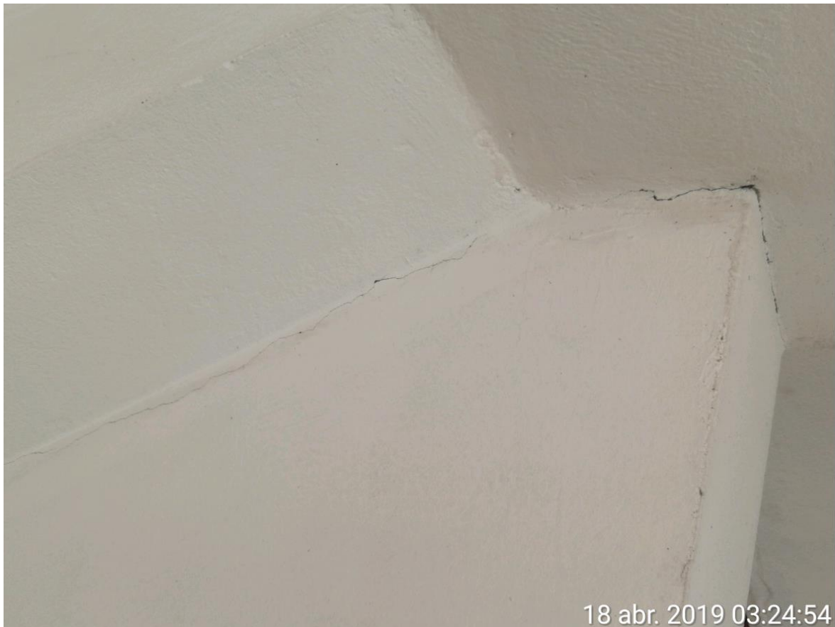
Fotografía 106: Fisuras en Intersección de losa y muro en escalera.
