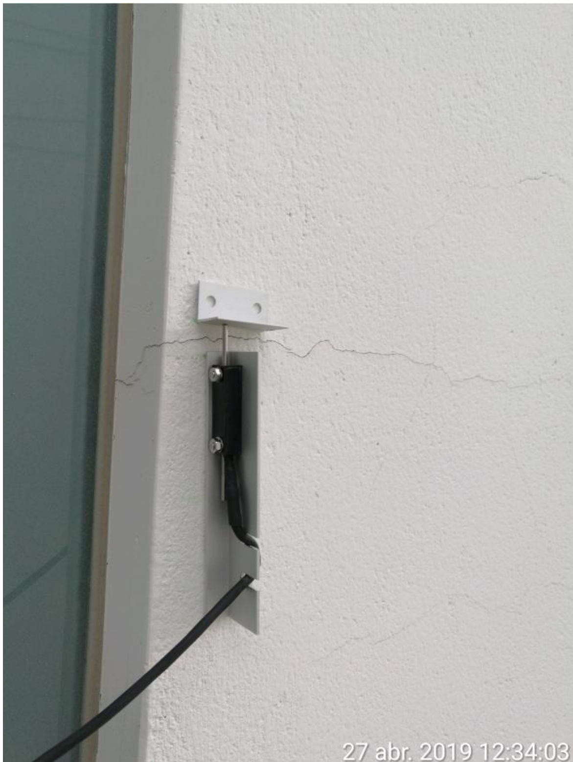
Fotografía 35: Fisura 03 en Ventana de Dormitorio 03, Departamento 502
