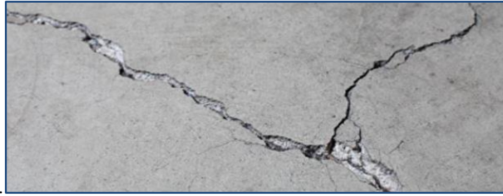
Figura 14: Fisuración por reacción Química , de Rodríguez, (2011), Tesis de grado.
