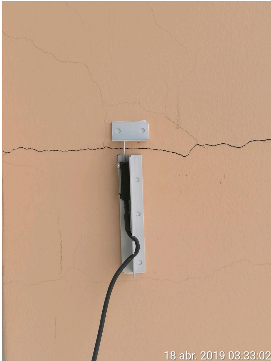
Fotografía 5:. Grieta en Volado en Descanso de Escalera
