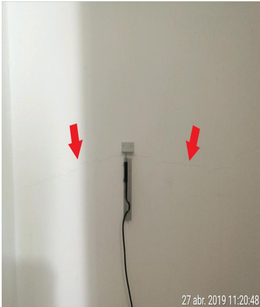
Fotografía 24: Fisura en Respaldo de Closet derecho en Dormitorio 02, Departamento 502
