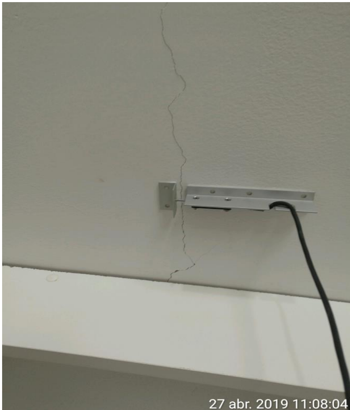
Fotografía 22: Fisura en Closet de Dormitorio 02, Departamento 502
