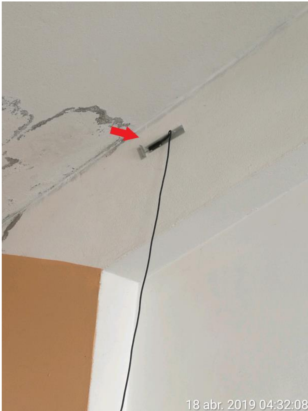
Fotografía 9: Fisura en Viga de Escalera 6 to piso.
