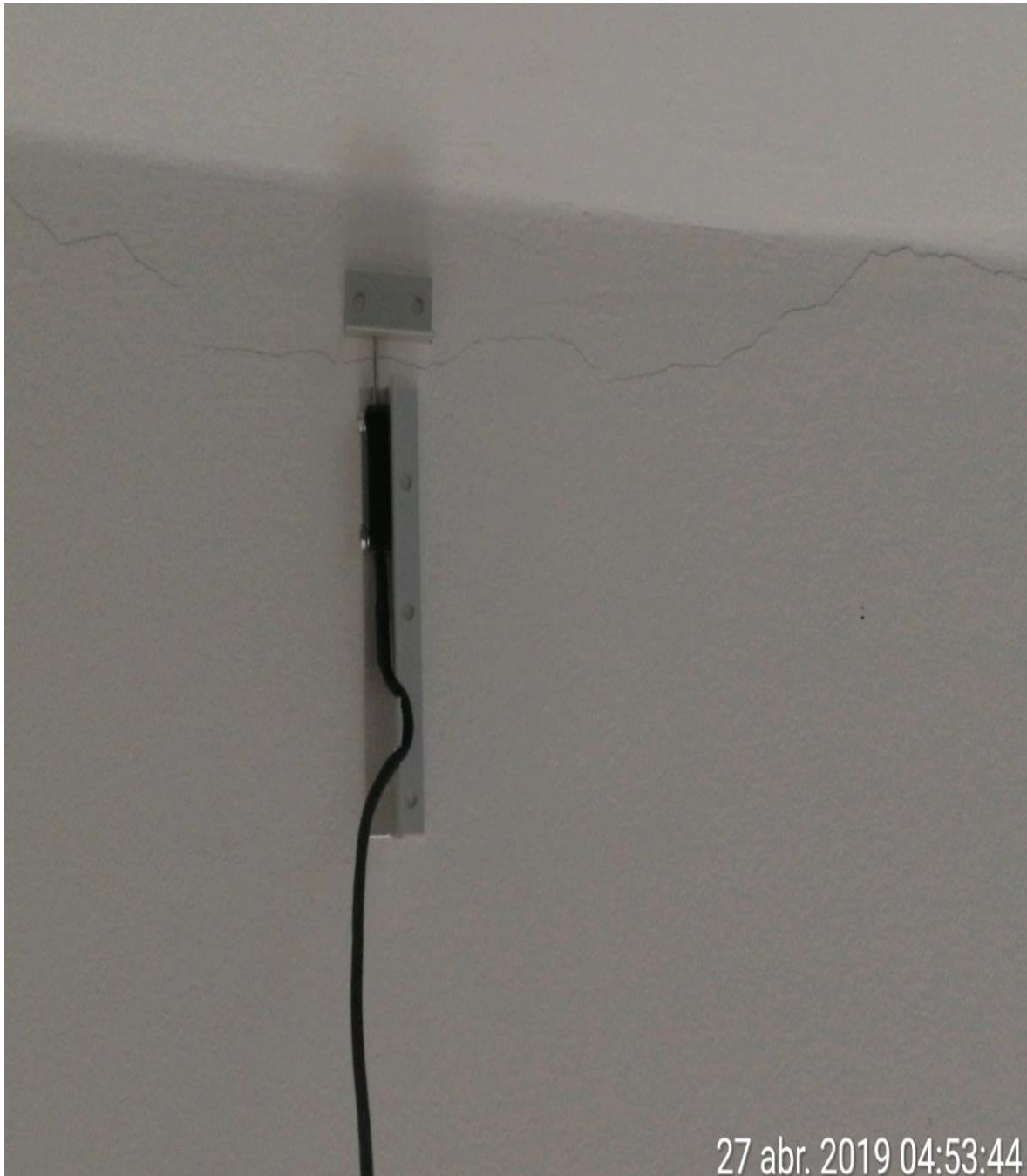
Fotografía 48: Fisura en Escalera de Descanso en 3 a 2 piso, Zona Común.
