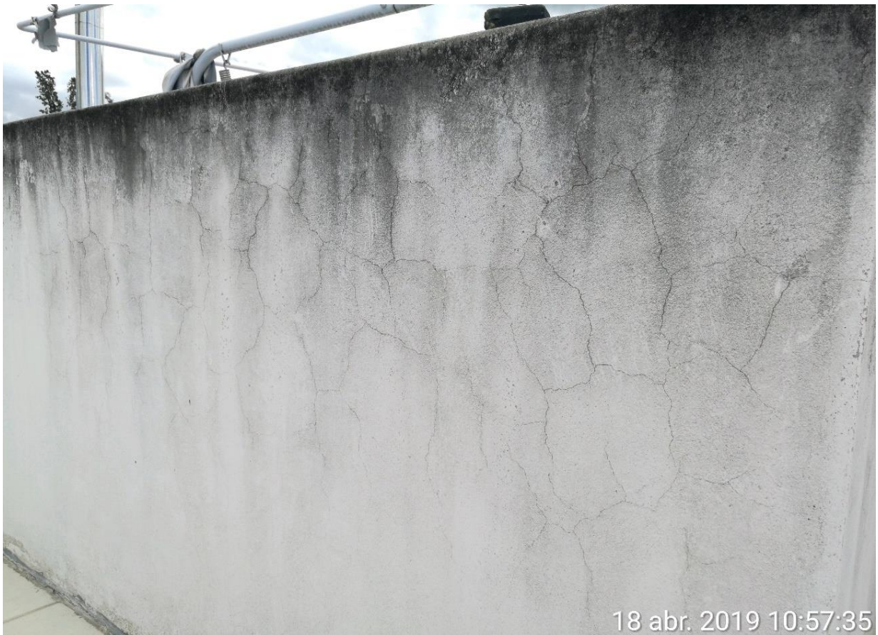
Fotografía 1: Fisuras de Parapeto Central (Azotea)
