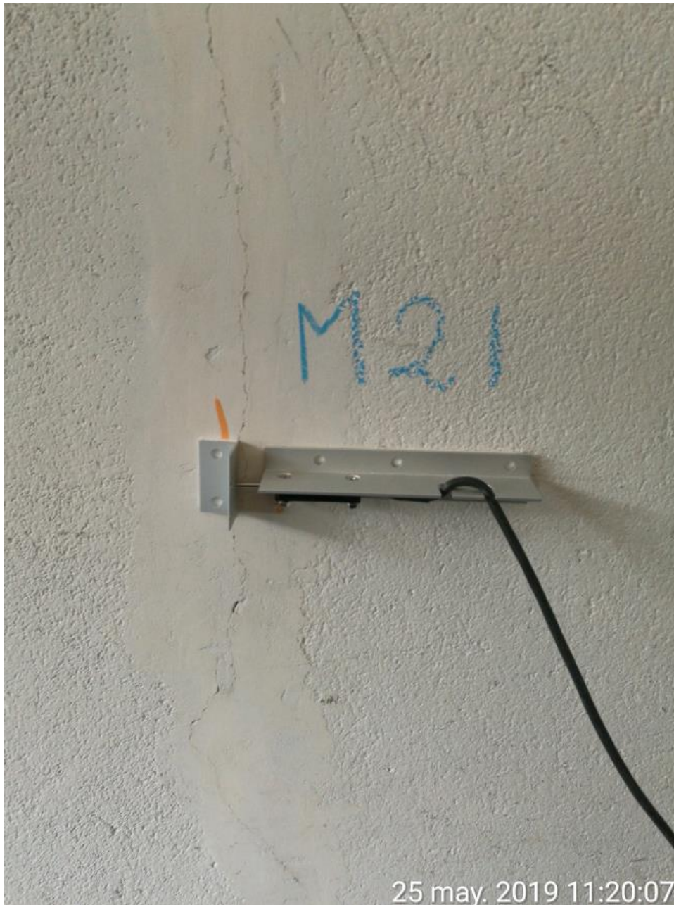
Fotografía 72: Fisura 21 en Muro de Estacionamiento, Zona Común.
