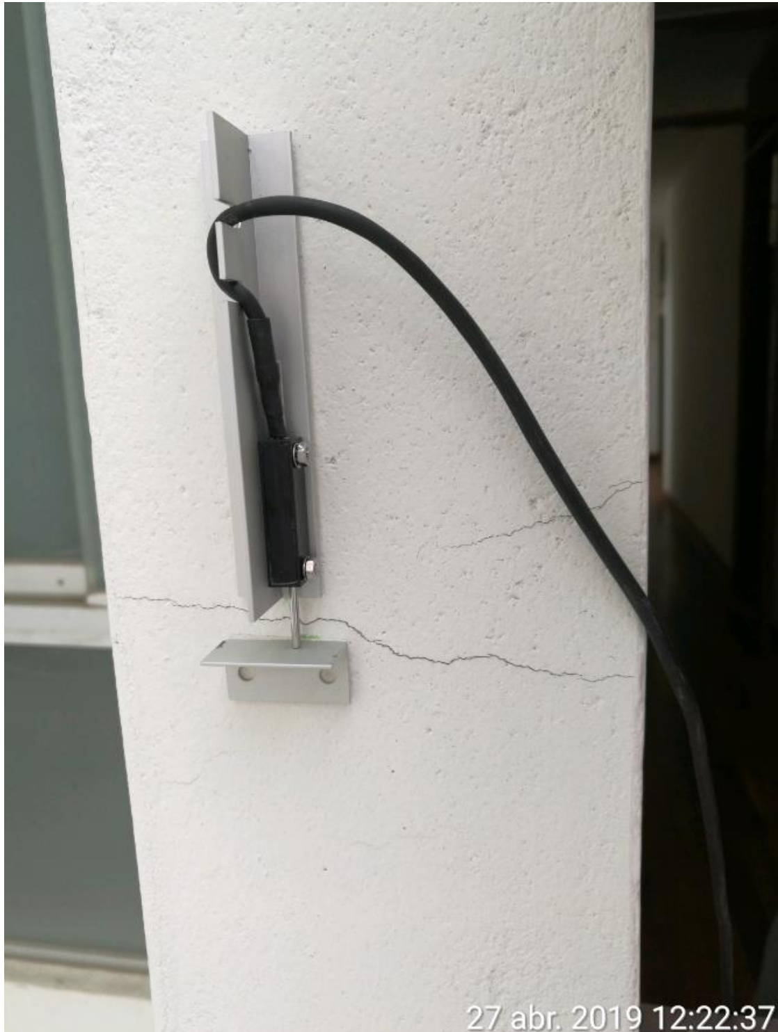
Fotografía 33: Fisura 01 en Ventana de Dormitorio 03, Departamento 502
