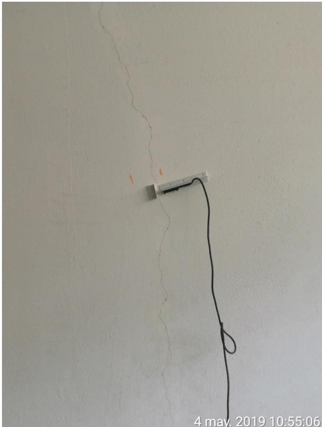
Fotografía 51: Fisura 02 en Pared de Estacionamiento, Zona Común.
