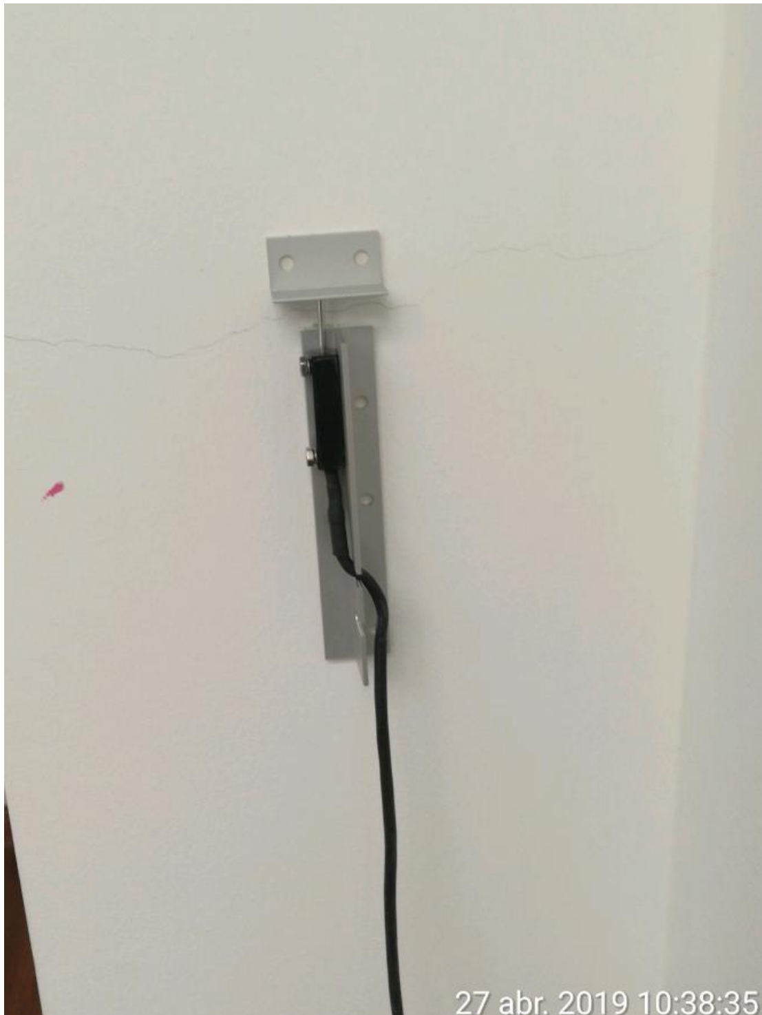
Fotografía 18: Fisura en Columna de Dormitorio 01, Departamento 502
