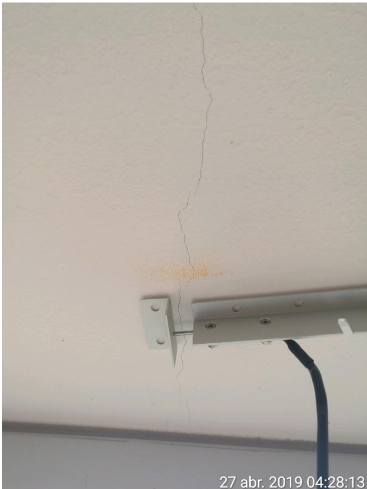
Fotografía 42: Fisura en Losa de Escalera 5 a 4 piso, Zona Común.
