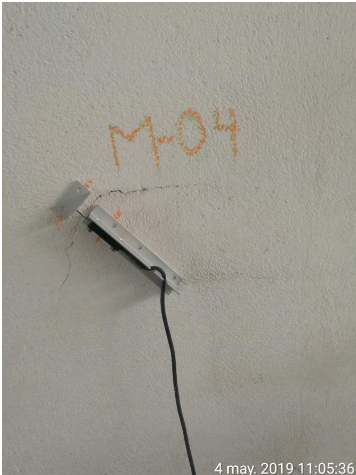
Fotografía 53: Fisura 04 en Pared de Estacionamiento, Zona Común.
