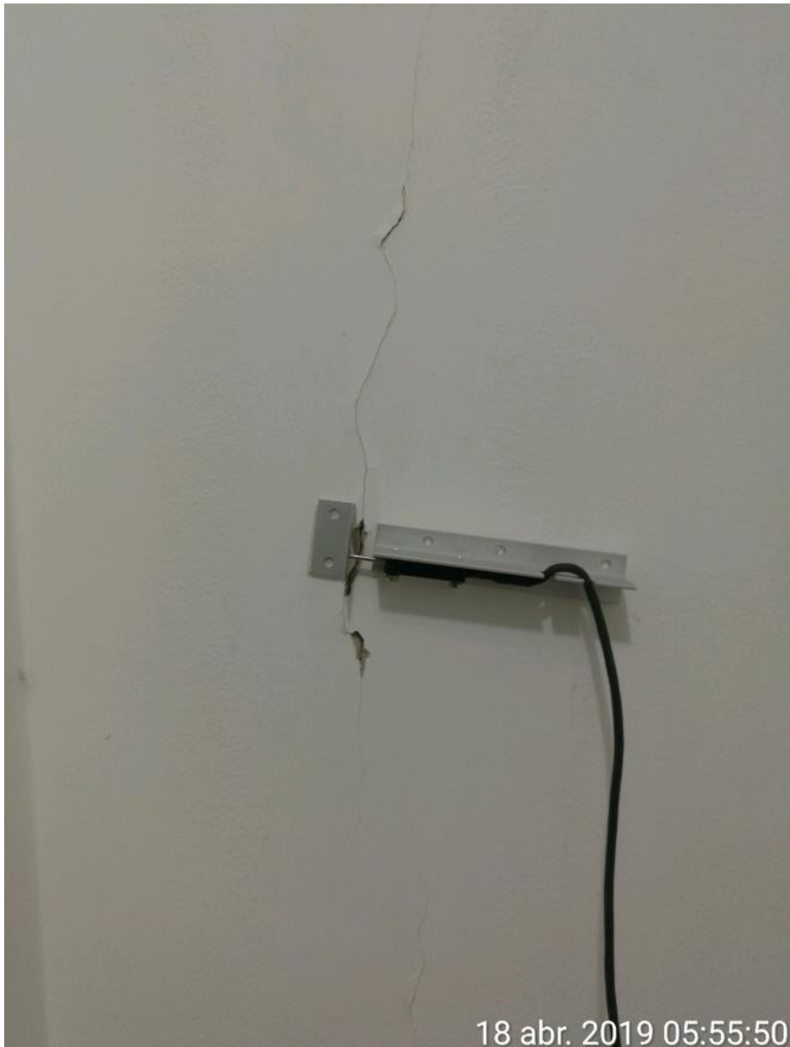
Fotografía 15: Fisura en Lavandería, Departamento 502
