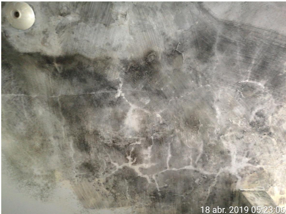
Fotografía 114: Filtración de Agua por micro fisuras en departamento 502.
