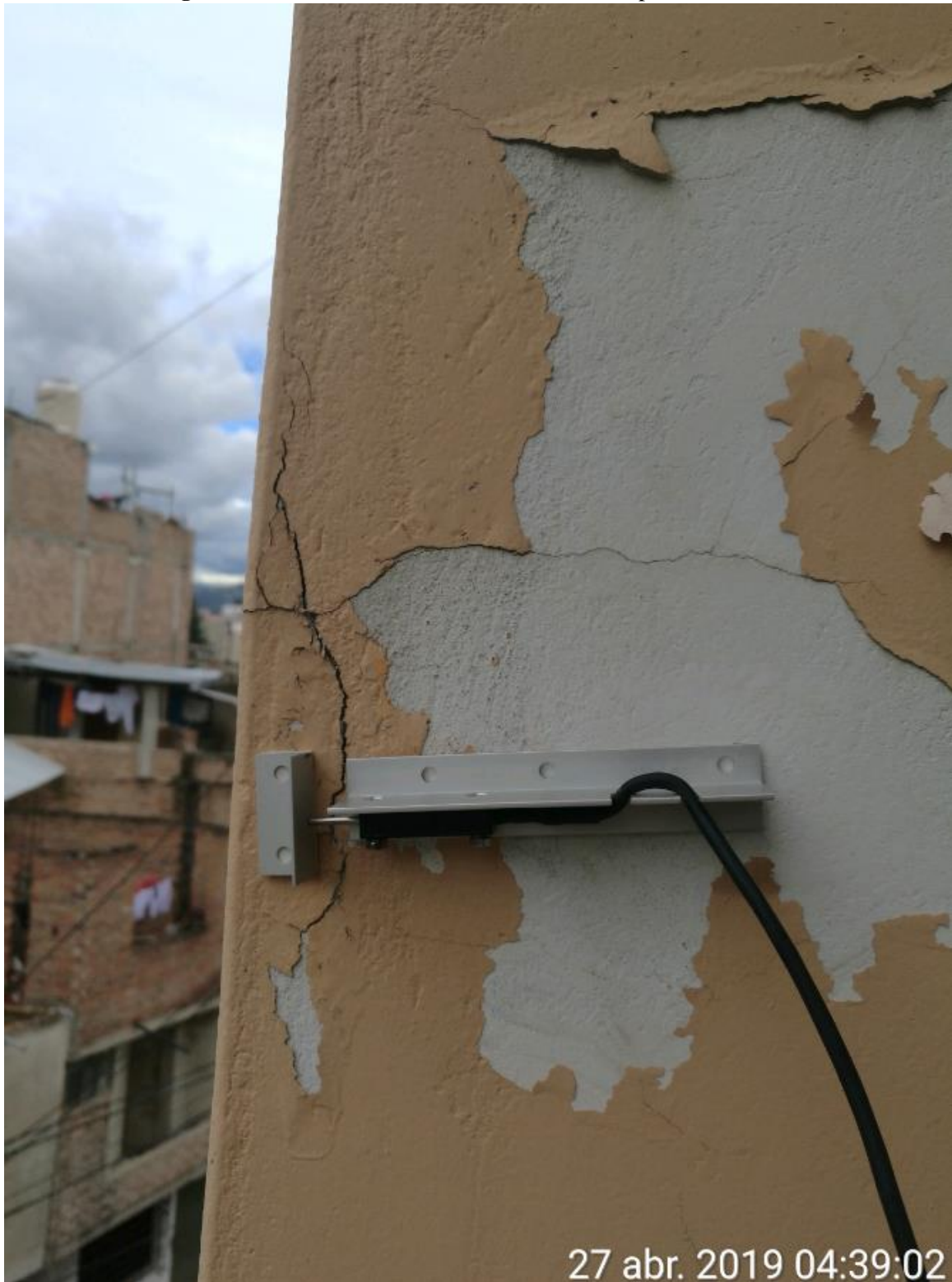
Fotografía 44: Grieta en Volado de Descanso 5 a 4 piso, Zona Común.
