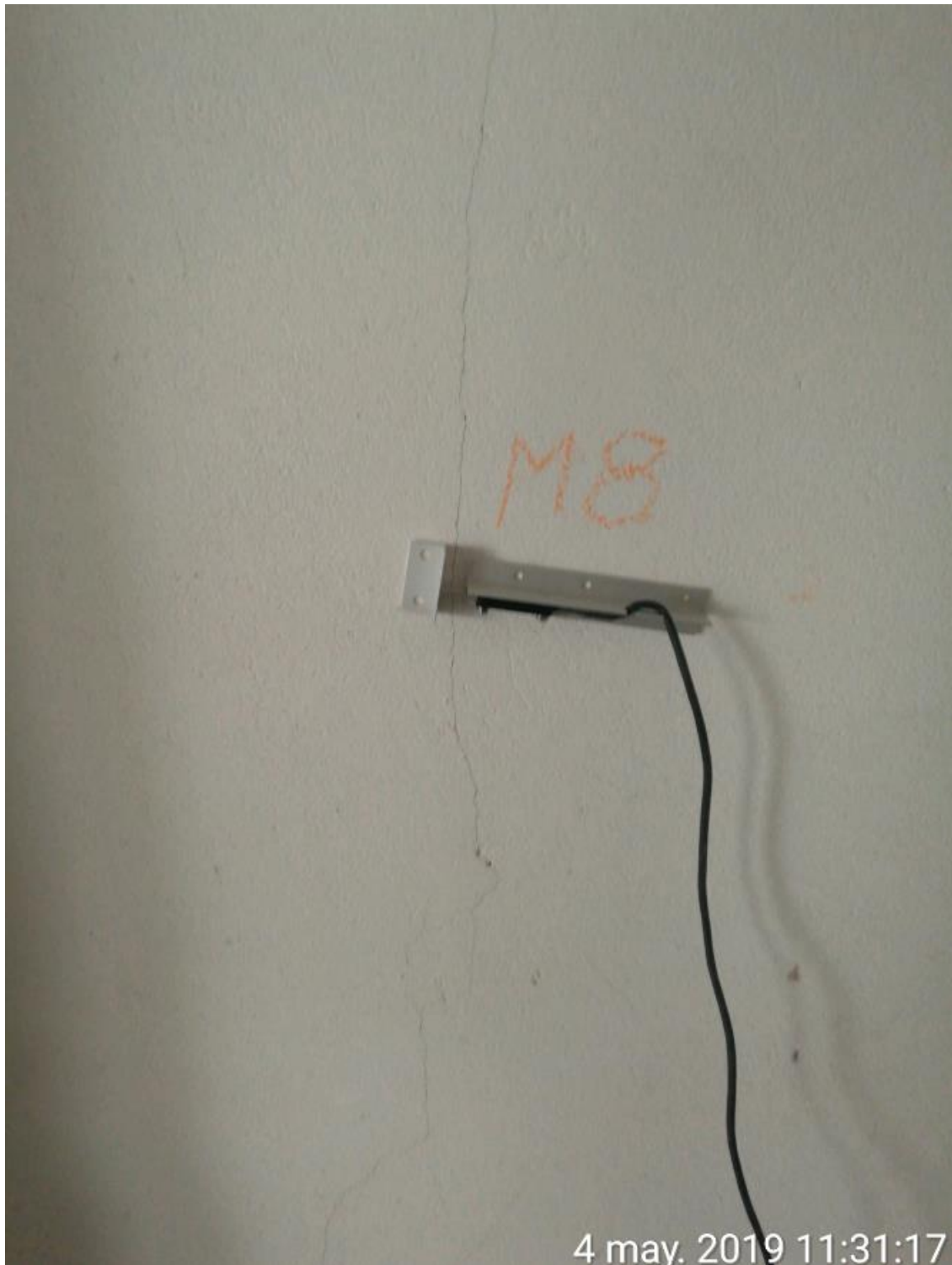
Fotografía 58: Fisura 08 en Pared de Estacionamiento, Zona Común.
