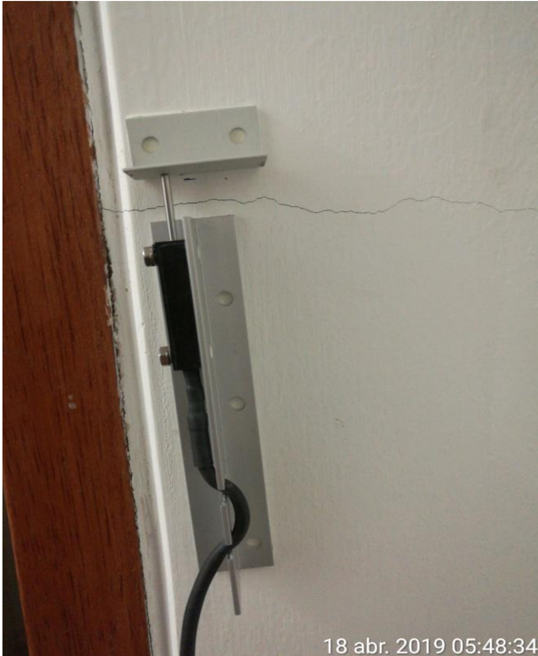
Fotografía 14: Fisura en Puerta de Baño N°1, Departamento 502
