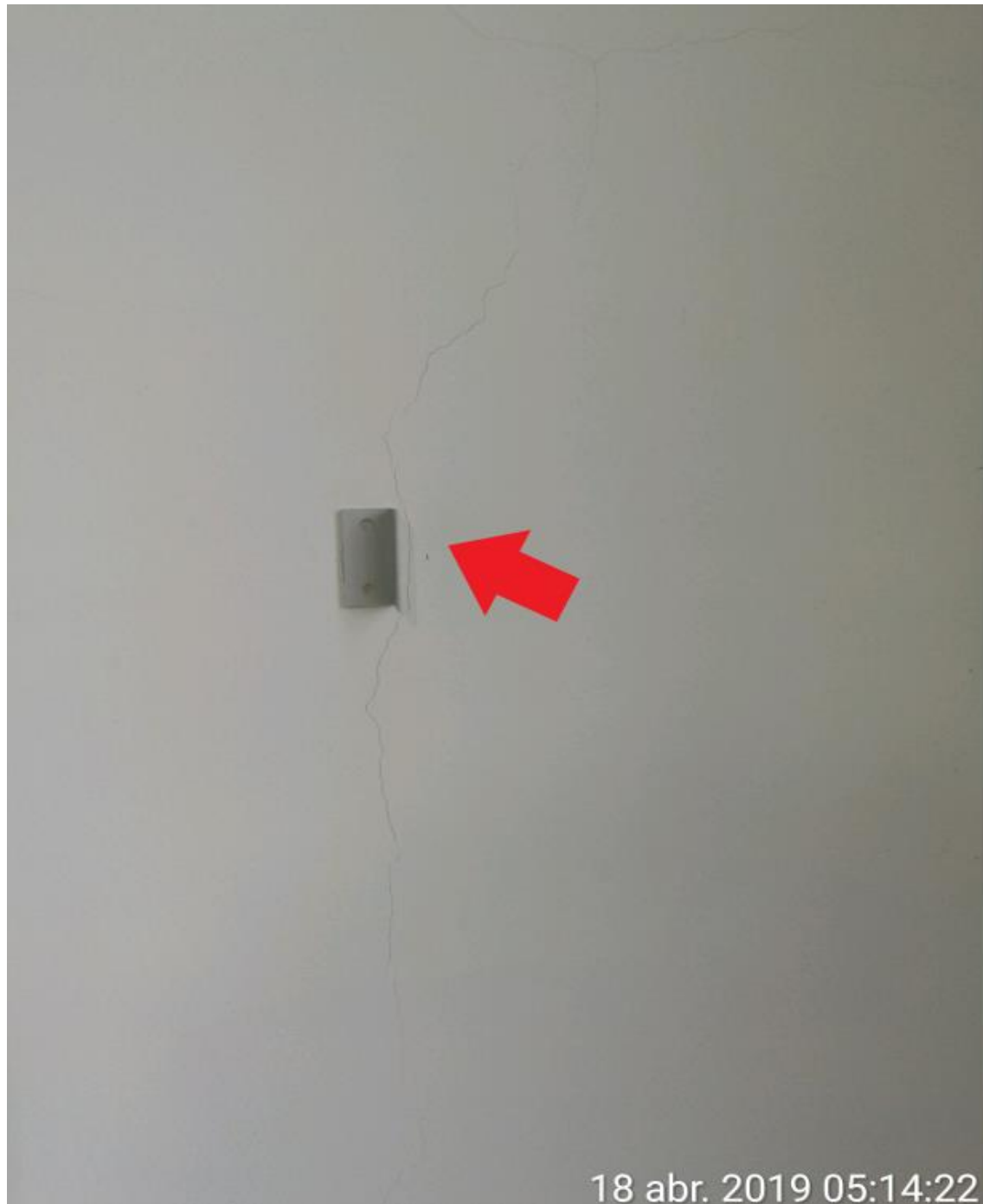
Fotografía 11: Fisura en Muro de Sala Comedor, Departamento 502.
