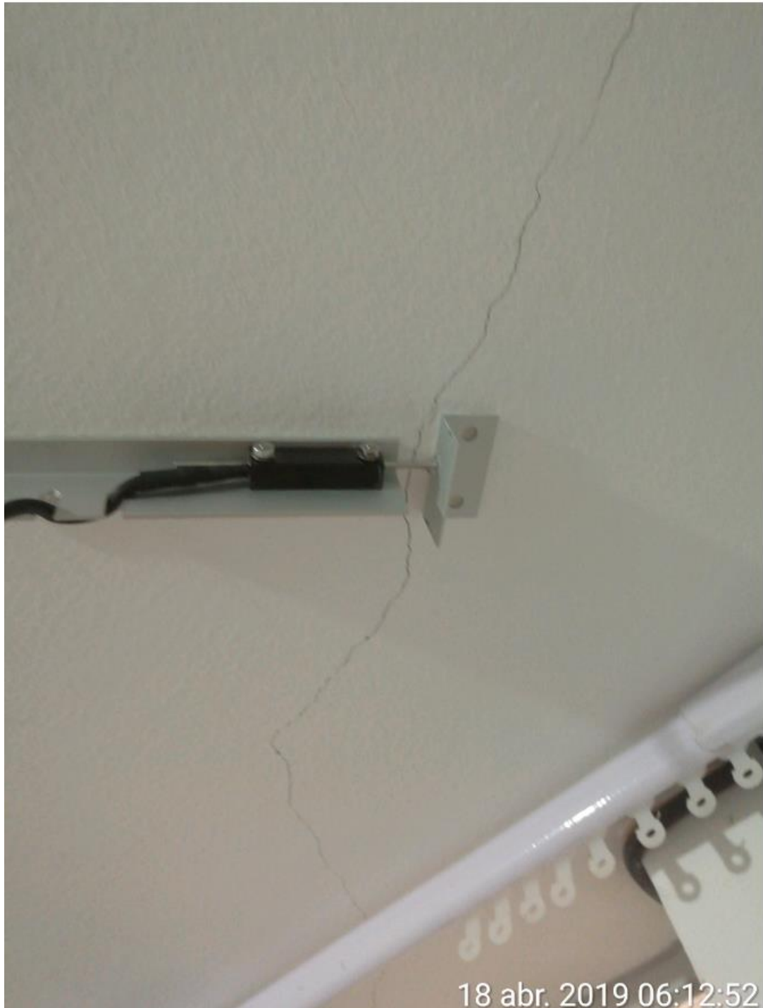
Fotografía 17: Fisura en Losa de Sala Estar, Departamento 502
