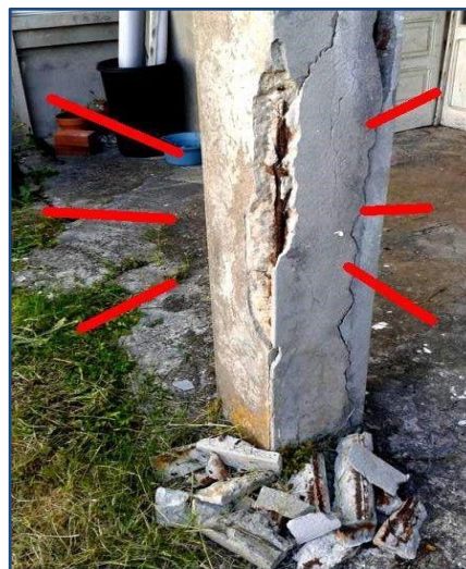
Figura 16: Fisuración y desprendimiento de concreto causados por corrosión en armadura longitudinal, de Google, (2019)
