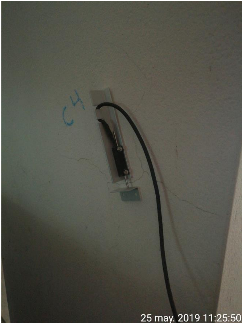
Fotografía 73: Fisura 04 en Columna de Estacionamiento, Zona Común.
