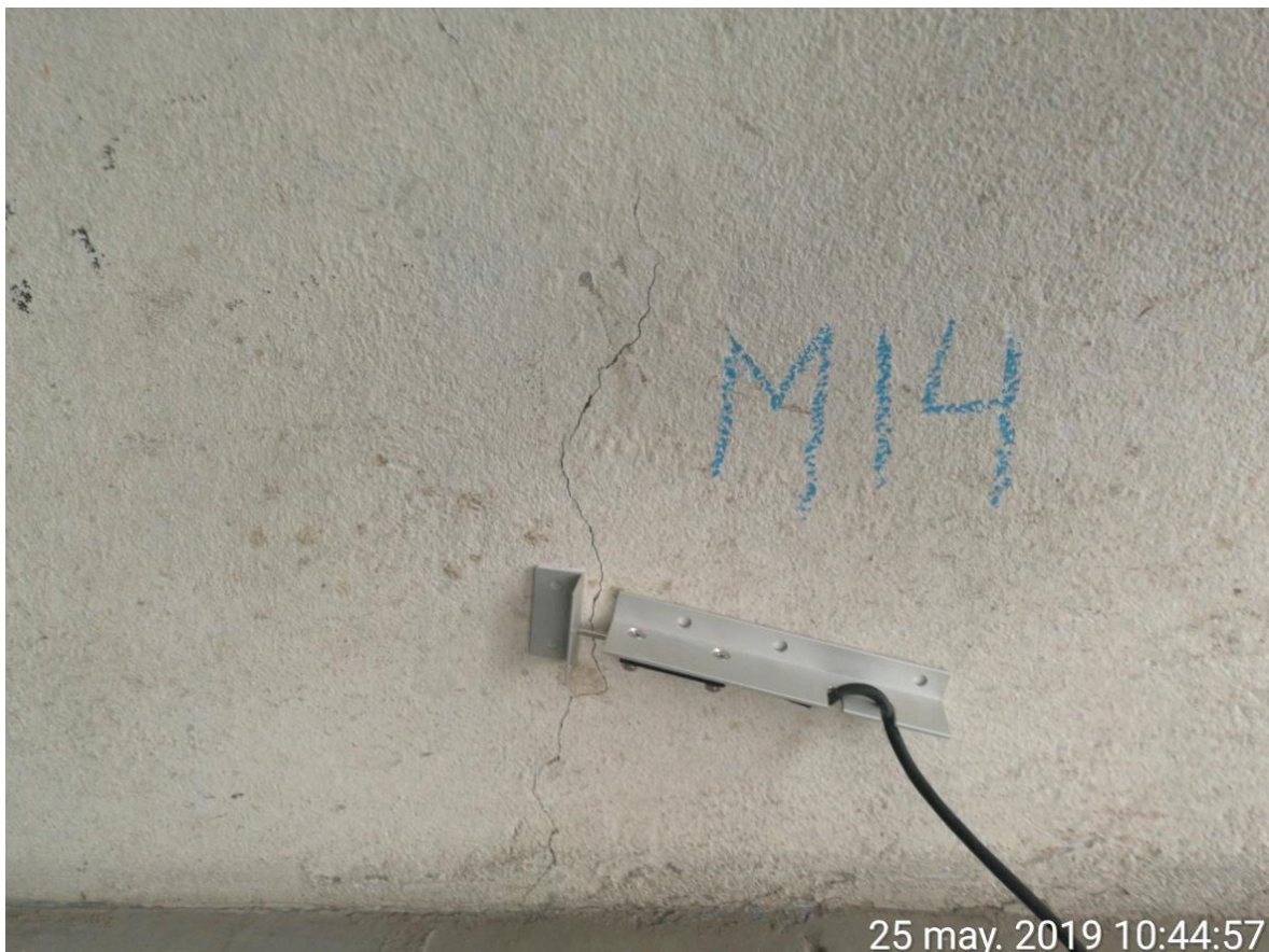
Fotografía 65: Fisura 14 en Muro de Estacionamiento, Zona Común.
