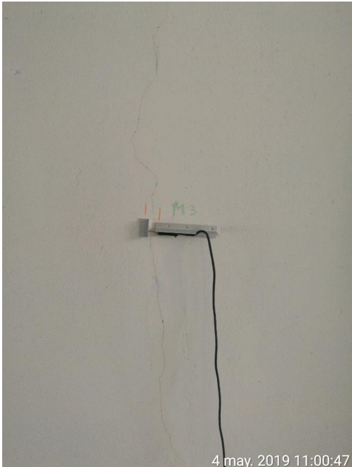
Fotografía 52: Fisura 03 en Pared de Estacionamiento, Zona Común.
