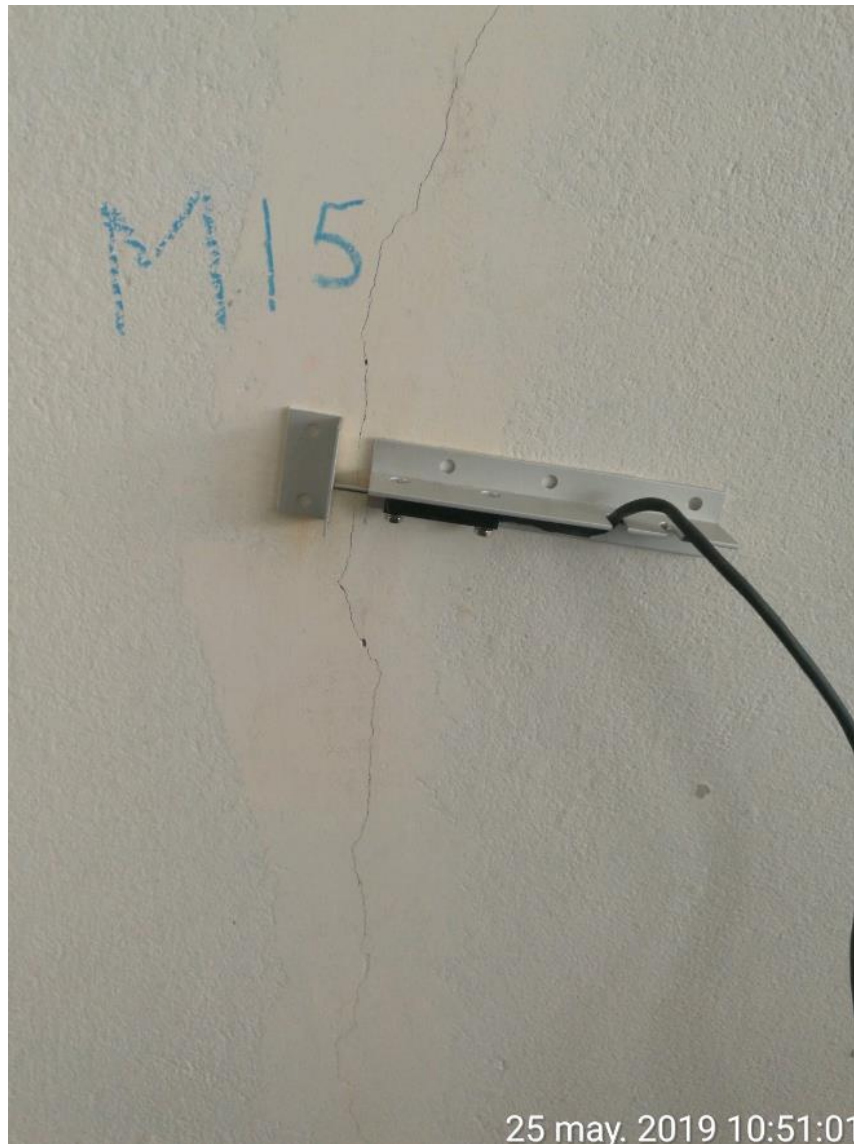
Fotografía 66: Fisura 15 en Muro de Estacionamiento, Zona Común.
