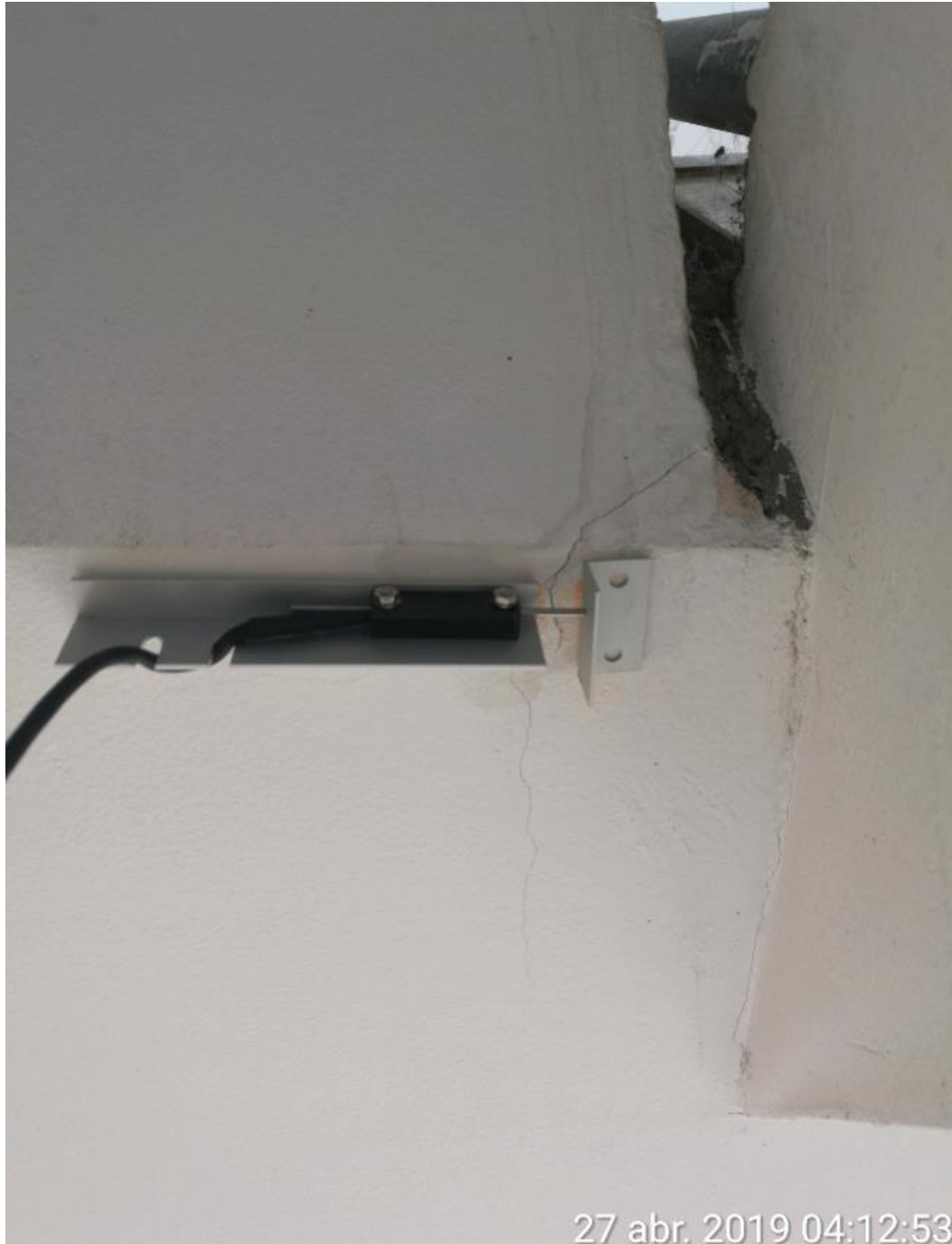
Fotografía 40: Fisura en Junta de Escalera en Descanso 5 a 4 piso, Zona Común.
