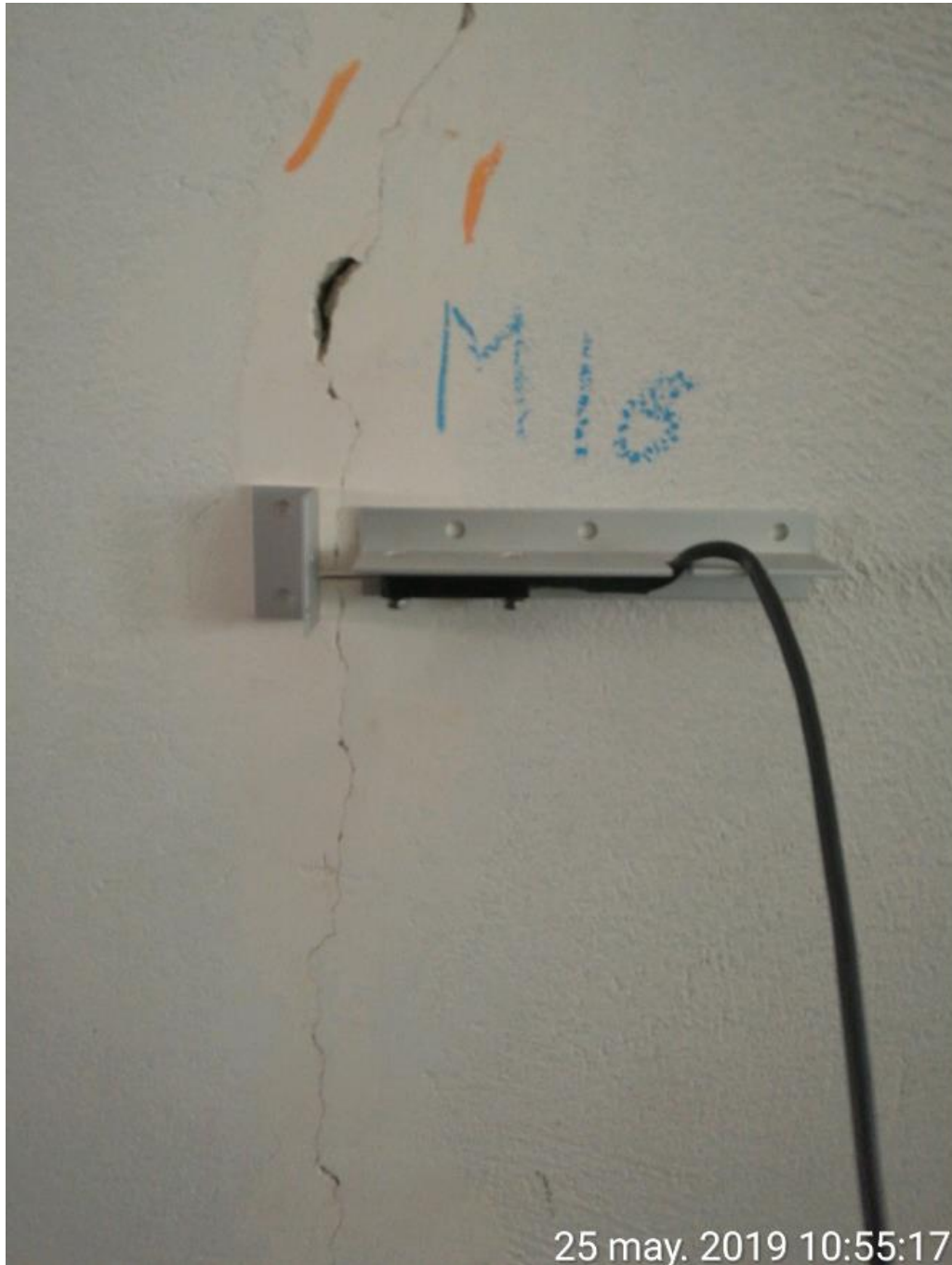
Fotografía 67: Fisura 16 en Muro de Estacionamiento, Zona Común.
