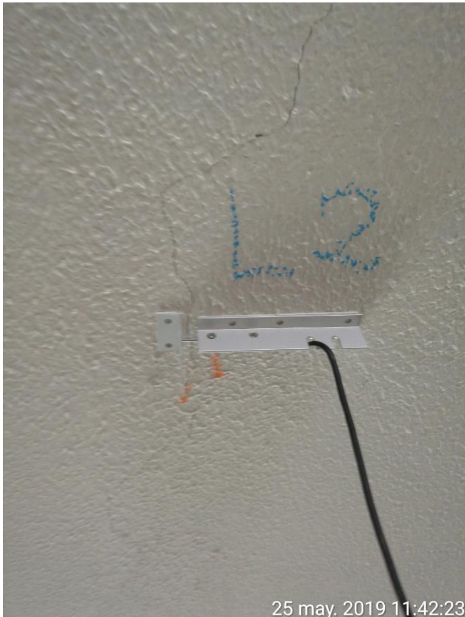
Fotografía 76: Fisura 02 en Losa de Estacionamiento, Zona Común.
