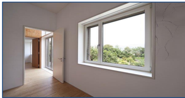
Figura 18: Fisuración y agrietamiento en ventana, de Google, (2019)
