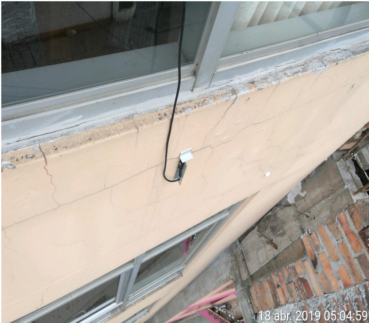
Fotografía 10: Fisura en Ventana de Sala, Departamento 502.
