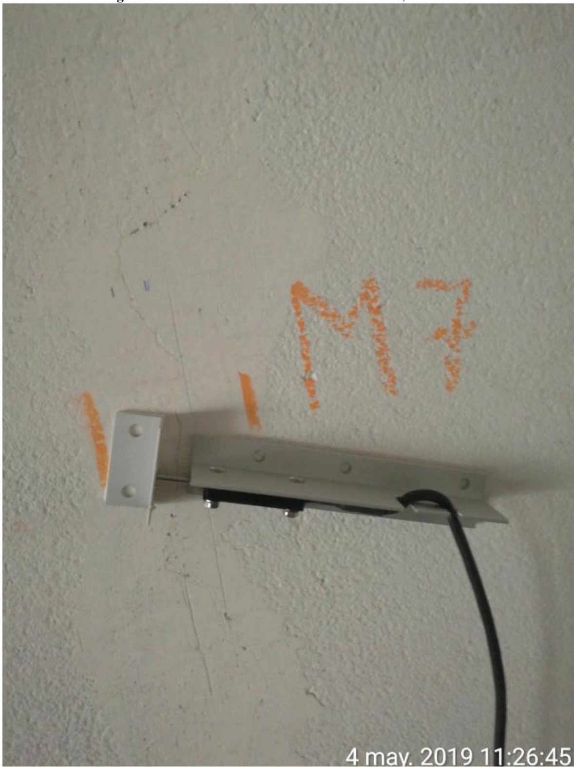
Fotografía 57: Fisura 07 en Pared de Estacionamiento, Zona Común.
