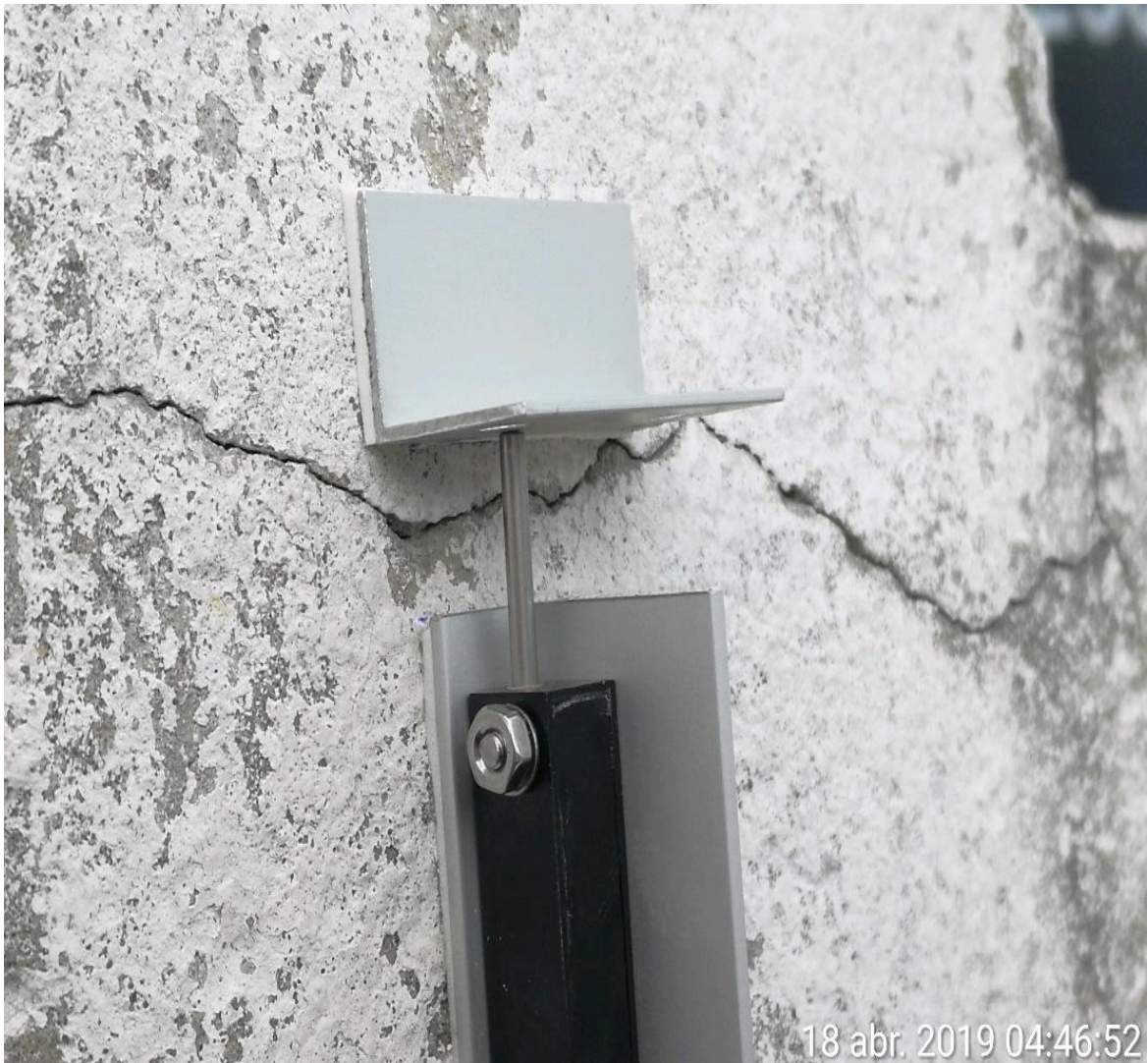
Fotografía 6: Grieta en Losa de Tanque de Agua
