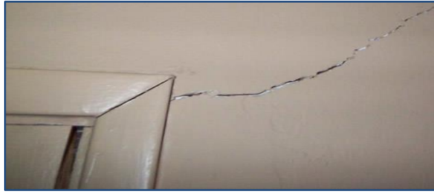
Figura 17: Fisuración típica en ángulos y esquinas en vanos, de Google, (2019)
