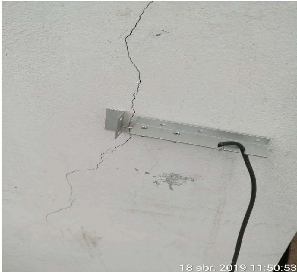
Fotografía 4: Grieta de Parapeto Oeste (Azotea)
