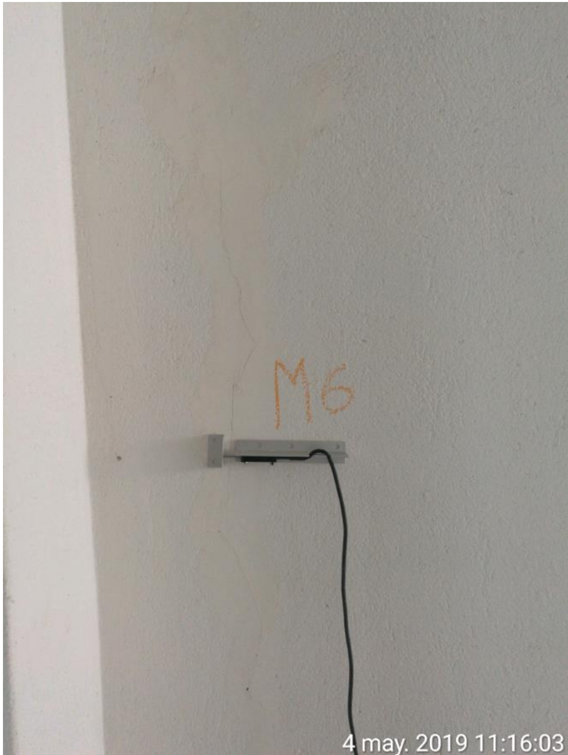
Fotografía 55: Fisura 06 en Pared de Estacionamiento, Zona Común.
