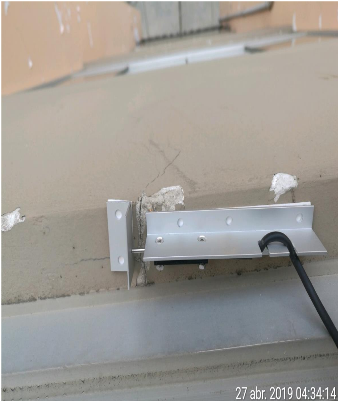
Fotografía 43: Grieta en Ventana en Descanso de 5 a 4 piso, Zona Común.
