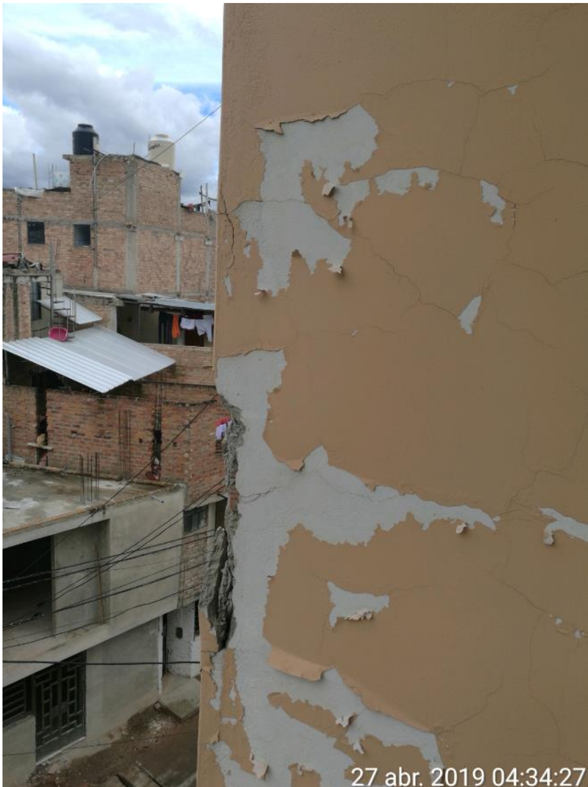
Fotografía 116: Desprendimiento de concreto en Fachada.
