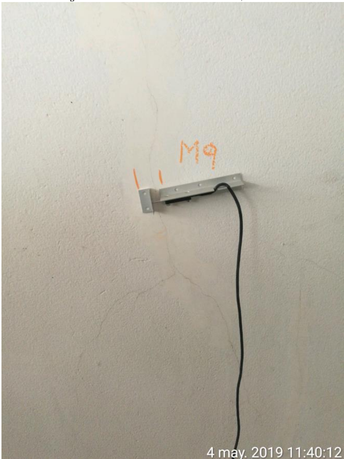
Fotografía 60: Fisura 09 en Muro de Estacionamiento, Zona Común.
