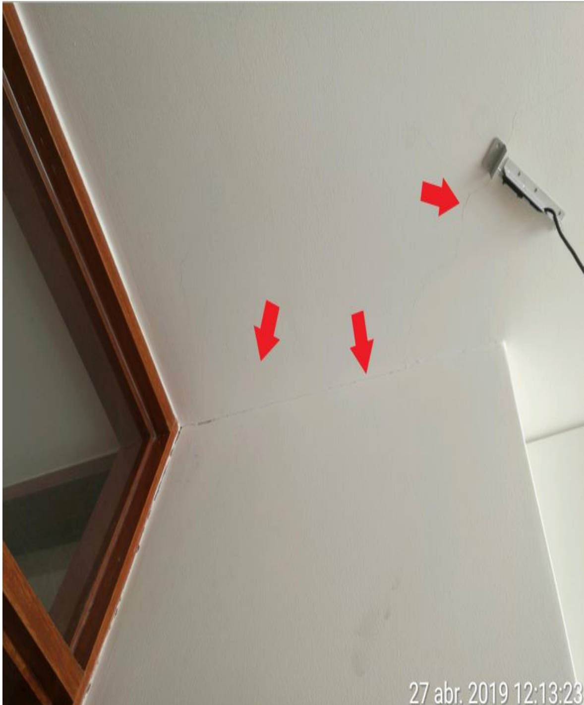
Fotografía 32: Fisura en Puerta de Closet en Dormitorio 03, Departamento 502
