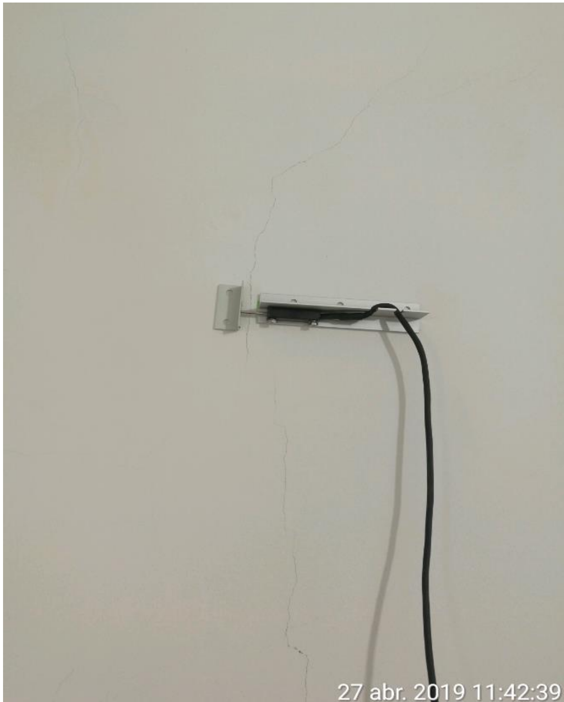
Fotografía 28: Fisura en Pared en Dormitorio 02, Departamento 502
