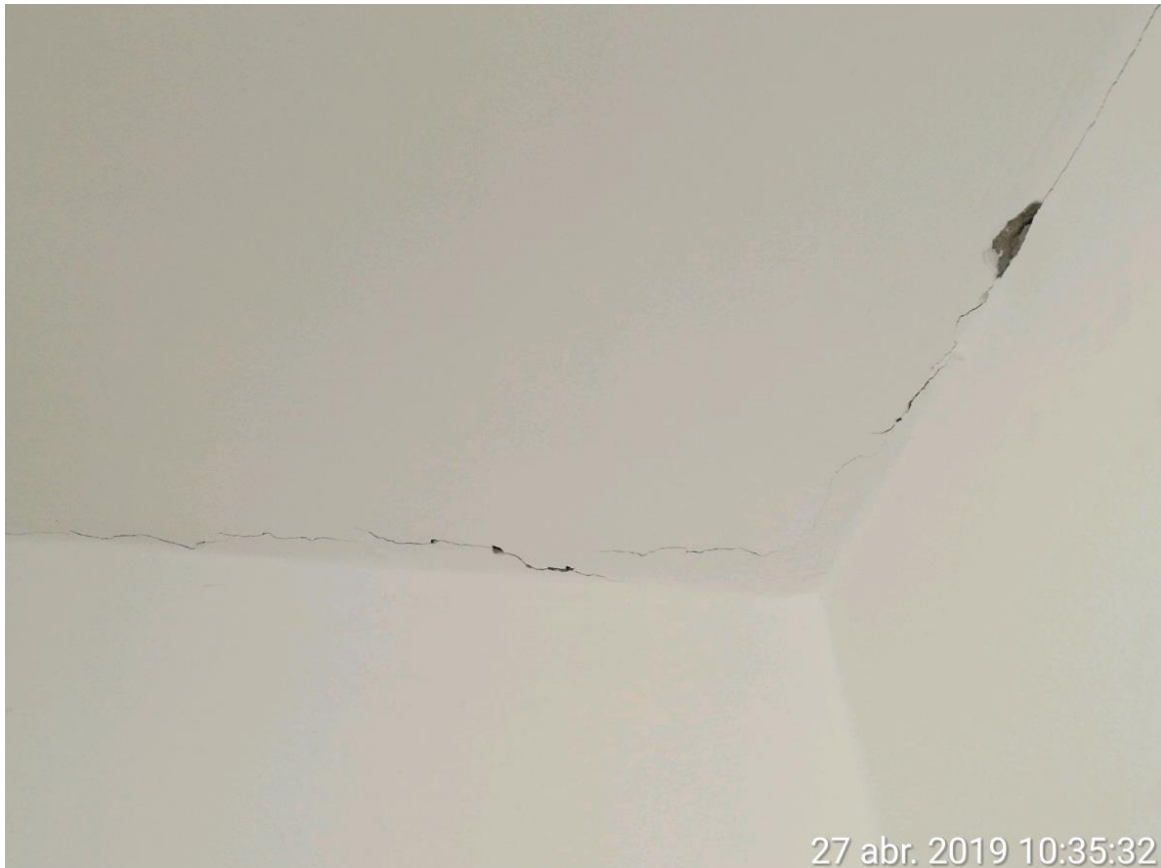
Fotografía 107: Fisuras en Closet de Dormitorio.
