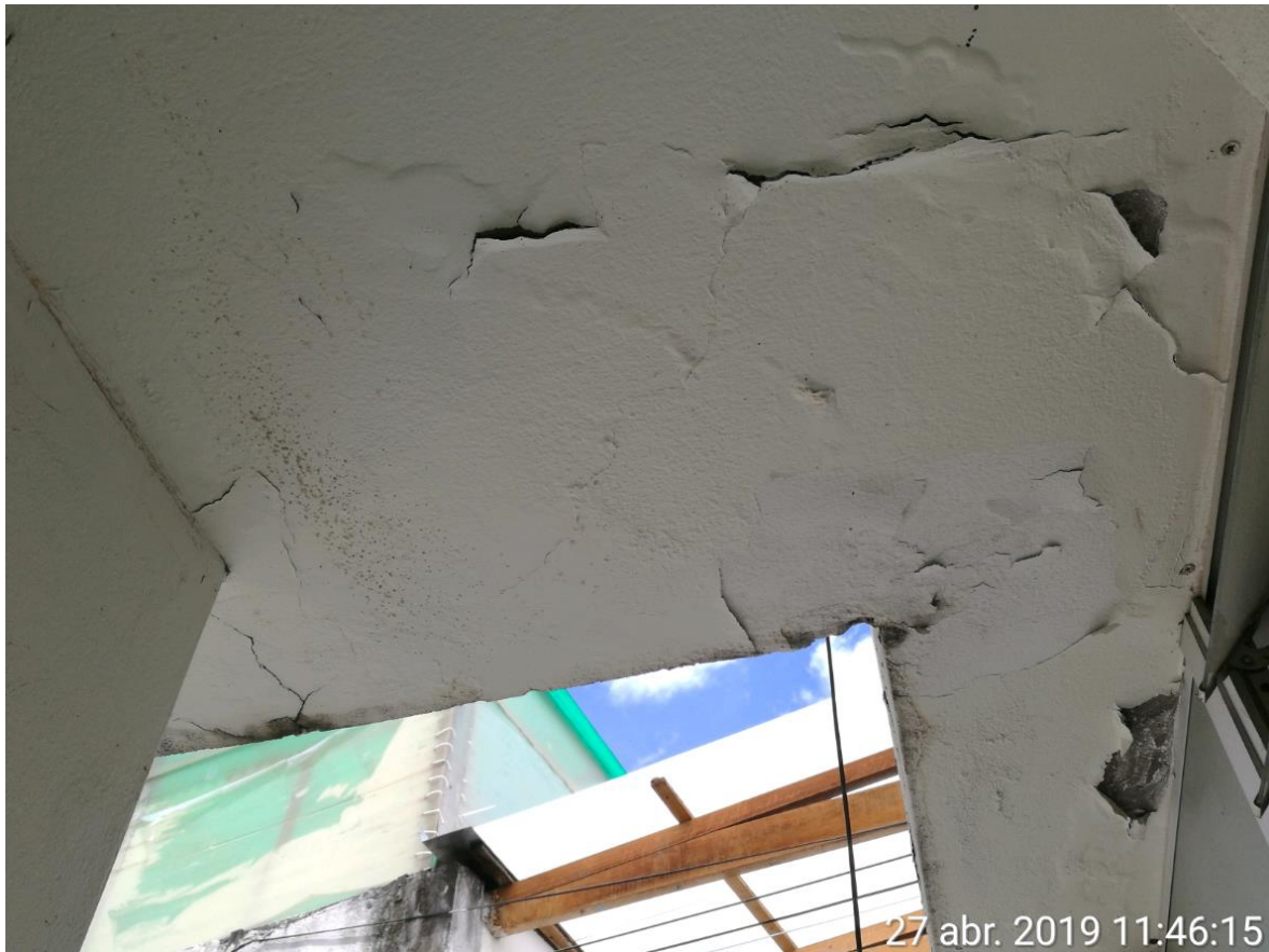
Fotografía 108: Fisuras en Filos de Losa.
