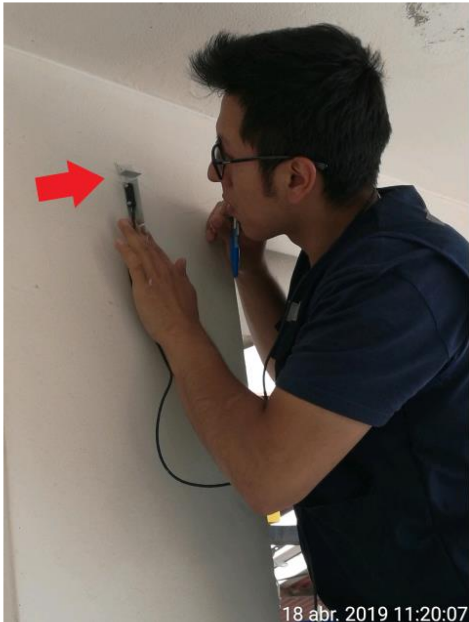
Fotografía 2: Fisura de Viga – Columna en Escalera (Azotea)
