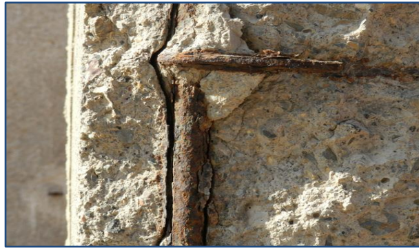
Figura 15: Fisuración y desprendimiento de concreto causados por corrosión localizada y carbonatación, de Google, (2019).
