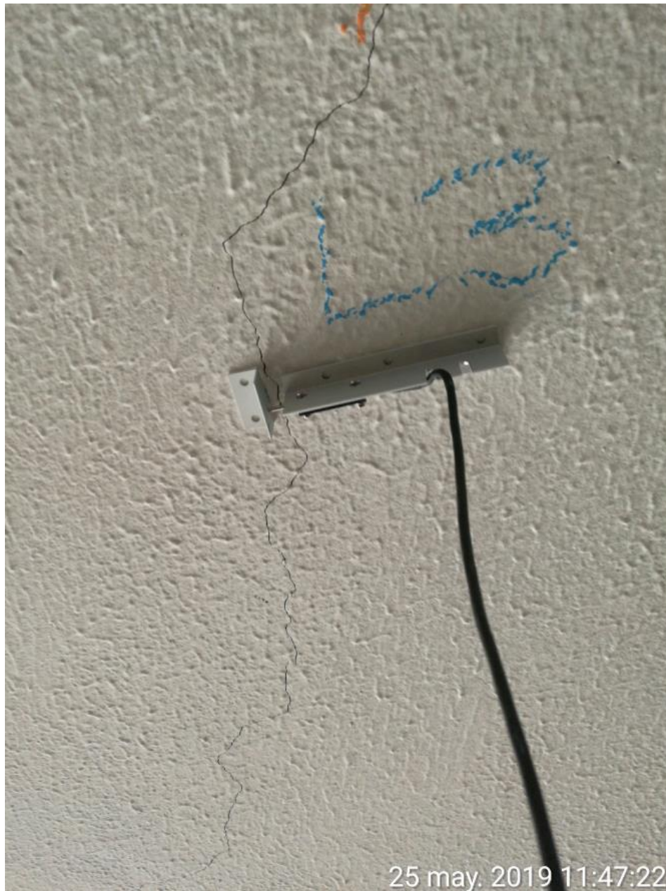
Fotografía 77: Fisura 03 en Losa de Estacionamiento, Zona Común.
