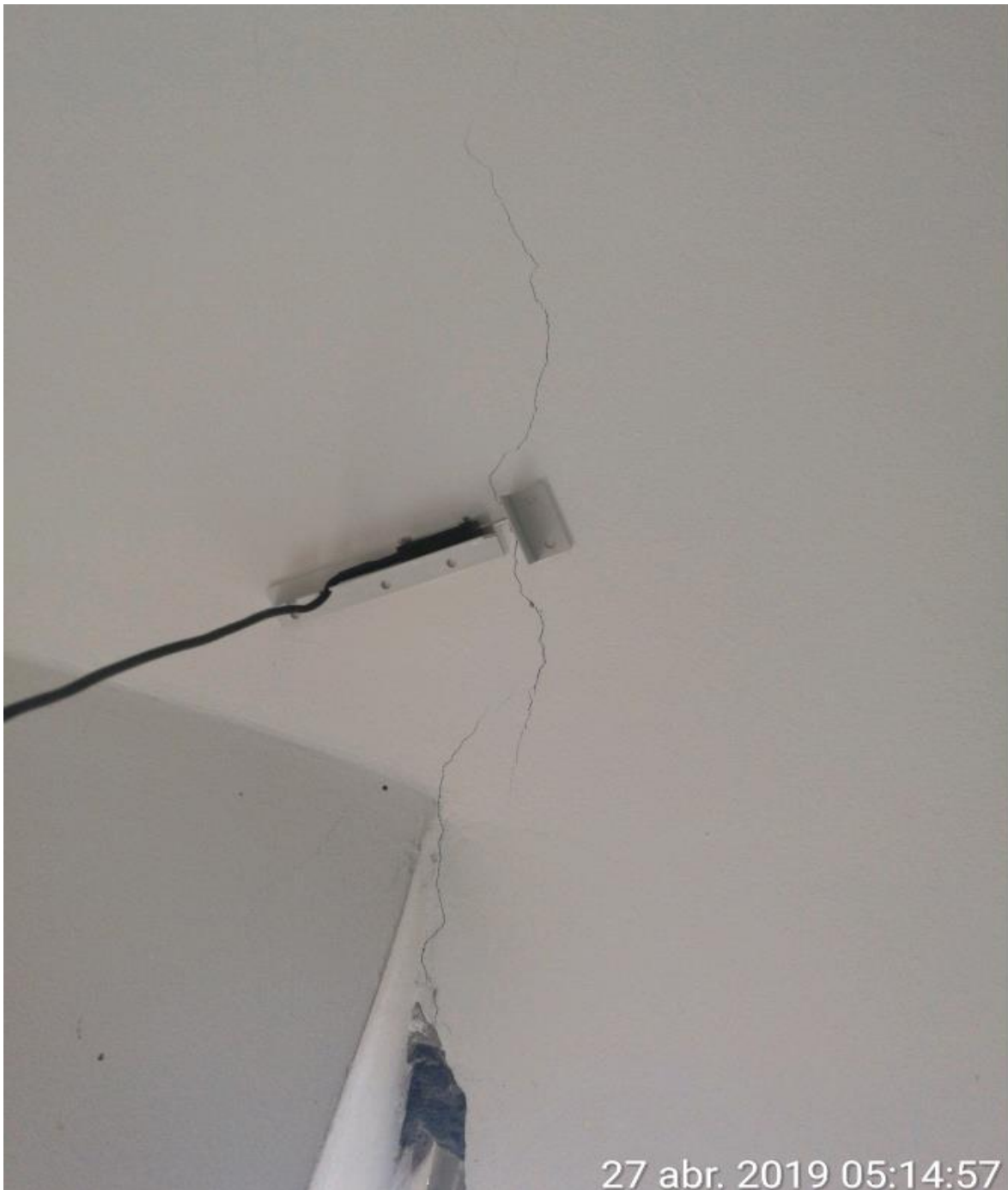
Fotografía 49: Fisura en Junta de Escalera en 2 piso, Zona Común.
