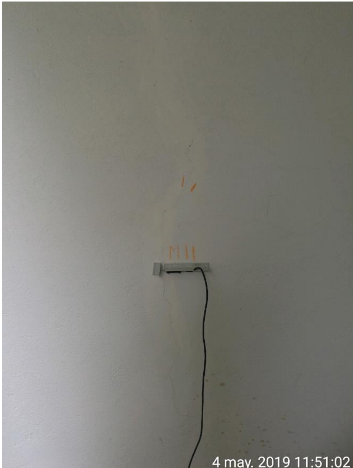
Fotografía 62: Fisura 11 en Muro de Estacionamiento, Zona Común.
