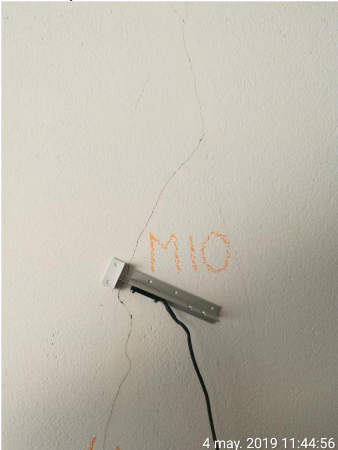
Fotografía 61: Fisura 10 en Muro de Estacionamiento, Zona Común.
