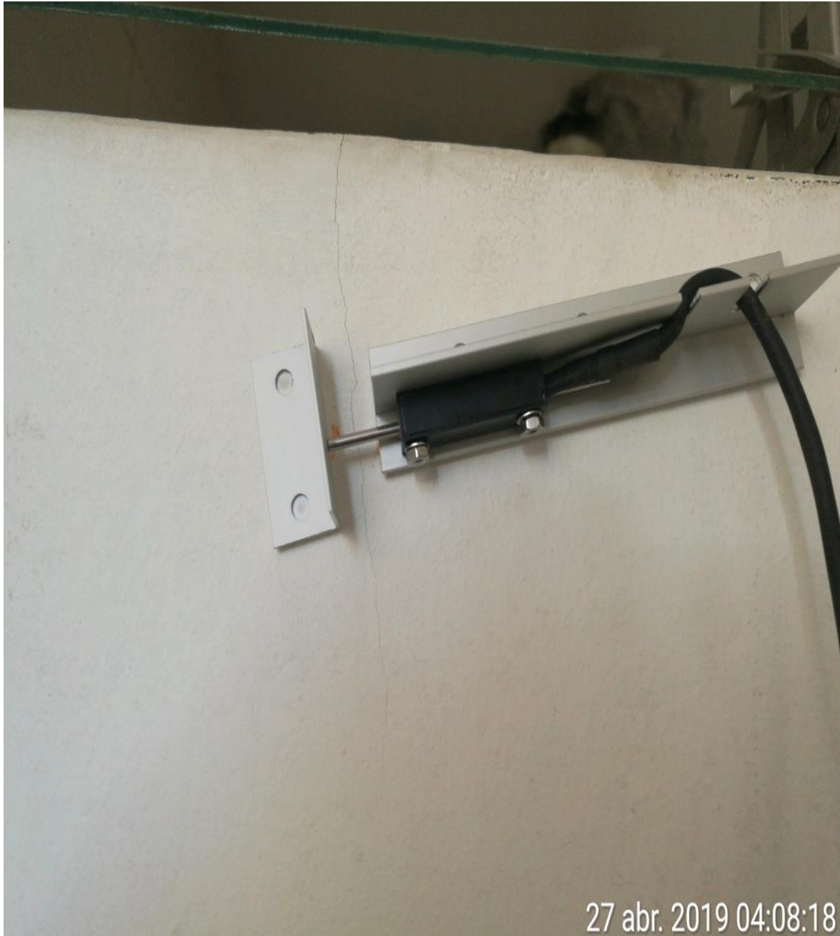
Fotografía 39: Fisura en Ventana de Descanso 5 a 4 piso, Zona Común.
