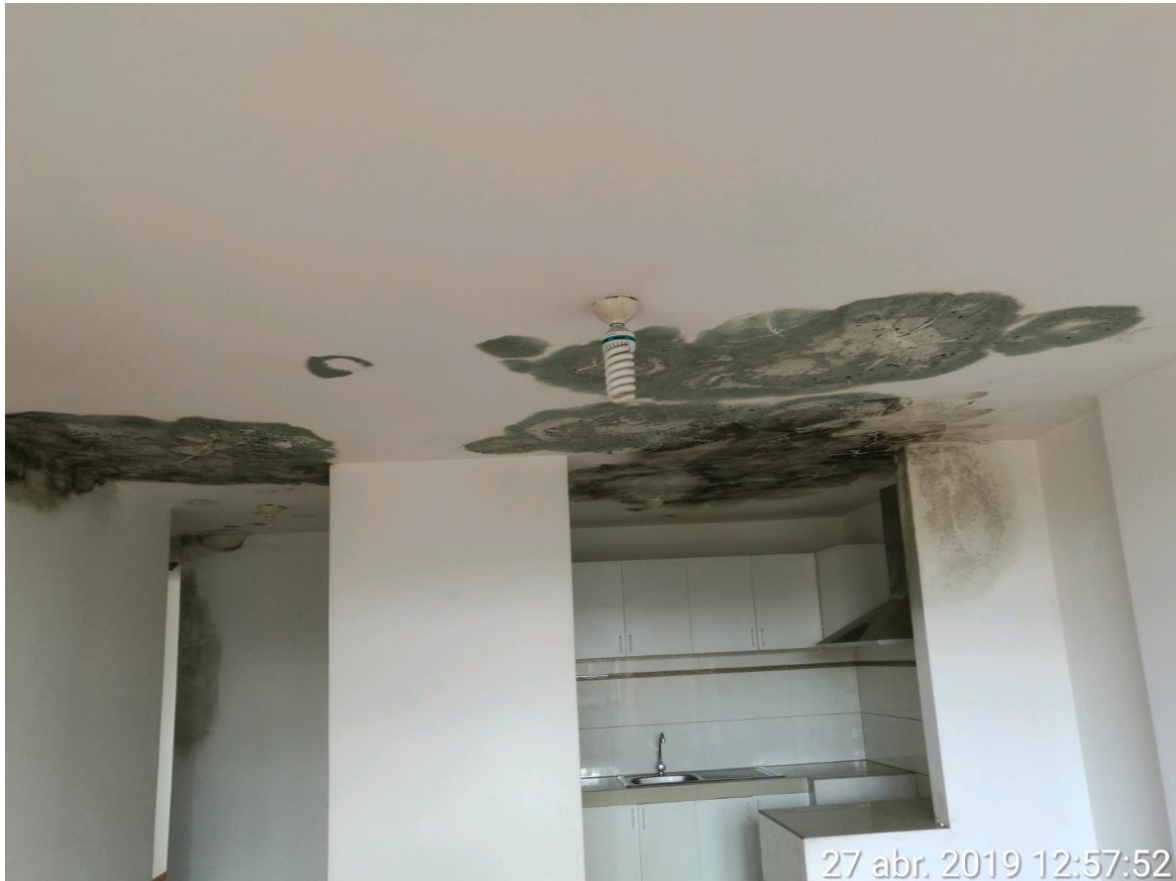
Fotografía 115: Estado Actual del Departamento 502
