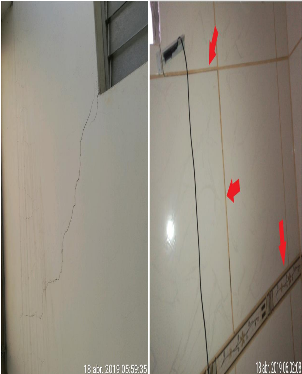
Fotografía 16: Grieta en SS. HH de Lavandería, Departamento 502
