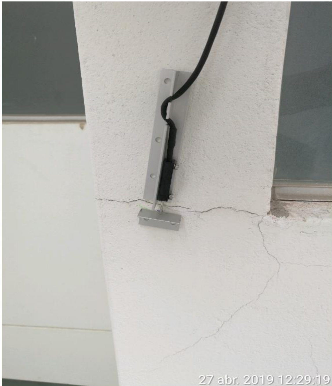
Fotografía 34: Grieta 02 en Ventana de Dormitorio 03, Departamento 502
