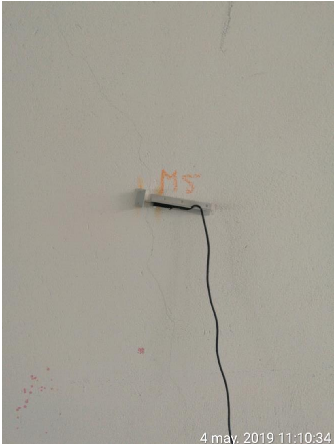
Fotografía 54: Fisura 05 en Pared de Estacionamiento, Zona Común.
