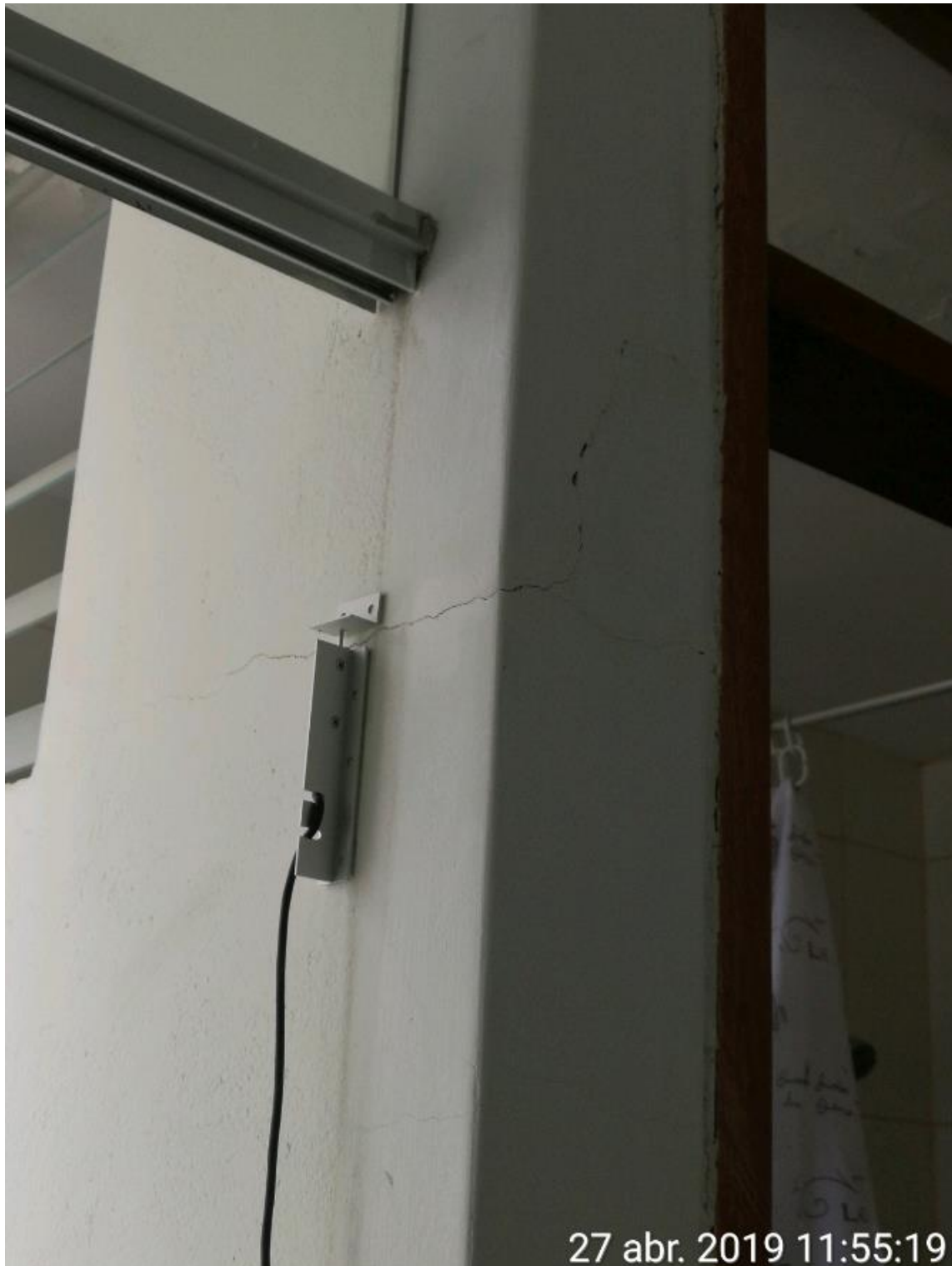
Fotografía 29: Fisura en Ventana – Puerta SS. HH de Dormitorio 02, Departamento 502
