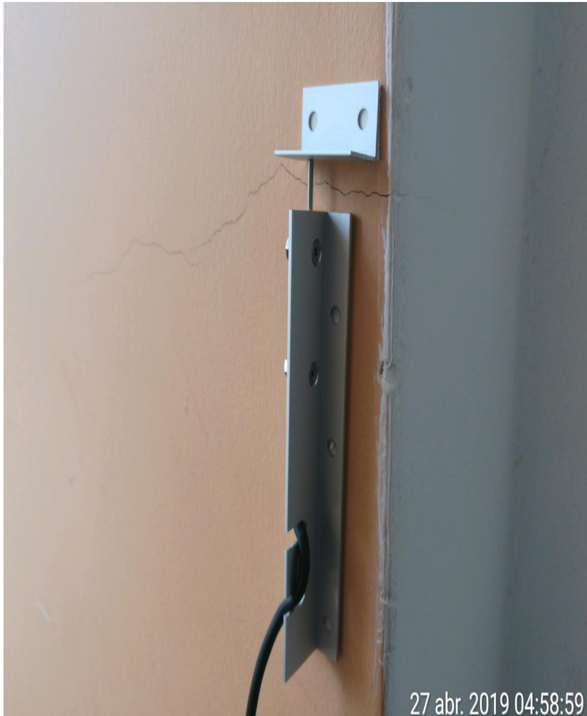
Fotografía 47: Fisura en Muro en Descanso de 4 a 3 piso, Zona Común.
