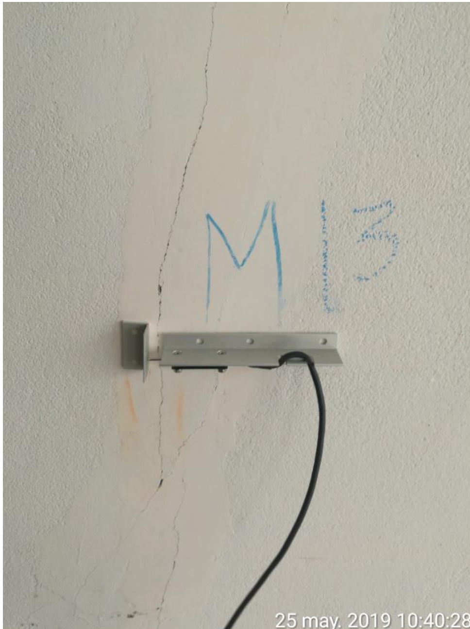
Fotografía 64: Fisura 13 en Muro de Estacionamiento, Zona Común.
