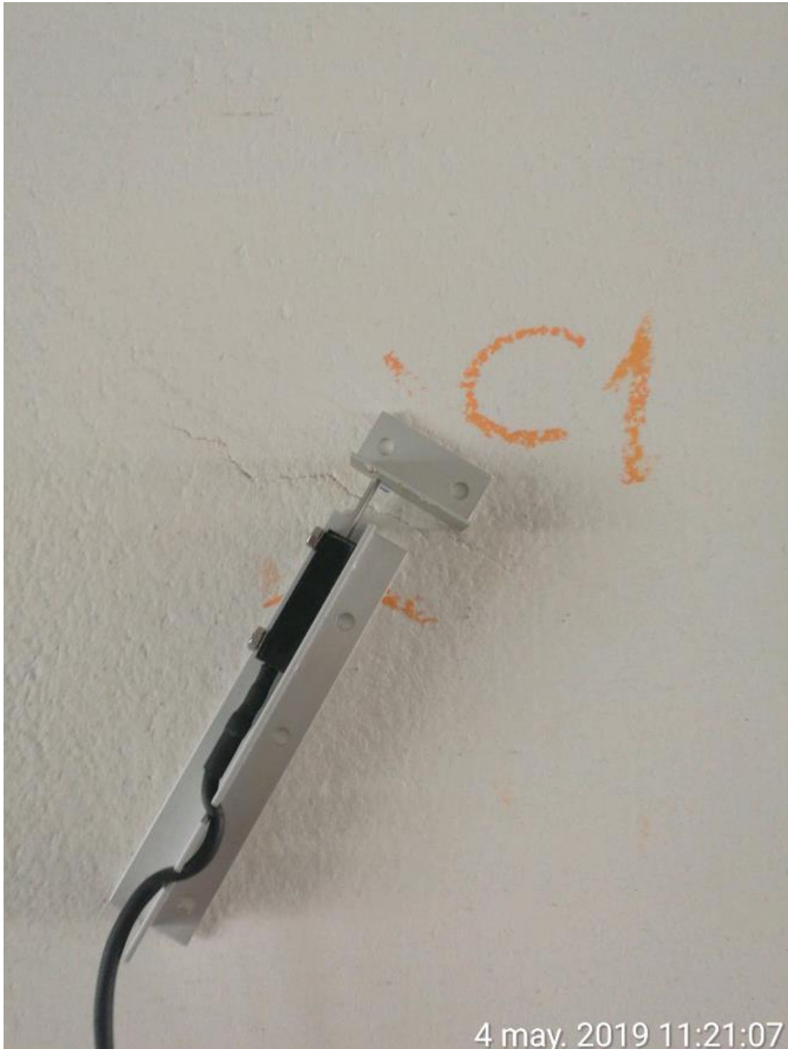
Fotografía 56: Fisura 01 en Columna de Estacionamiento, Zona Común.
