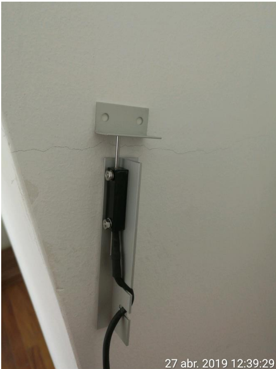
Fotografía 36: Fisura en Columna de Dormitorio 03, Departamento 502
