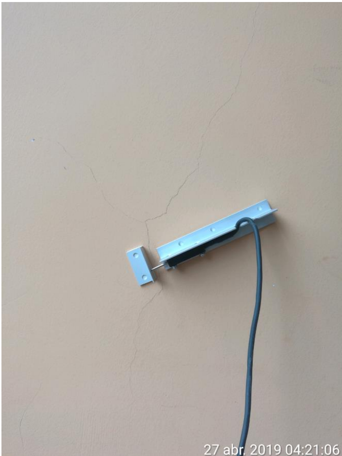
Fotografía 41: Fisura en Pared en Descanso 5 a 4 piso, Zona Común.
