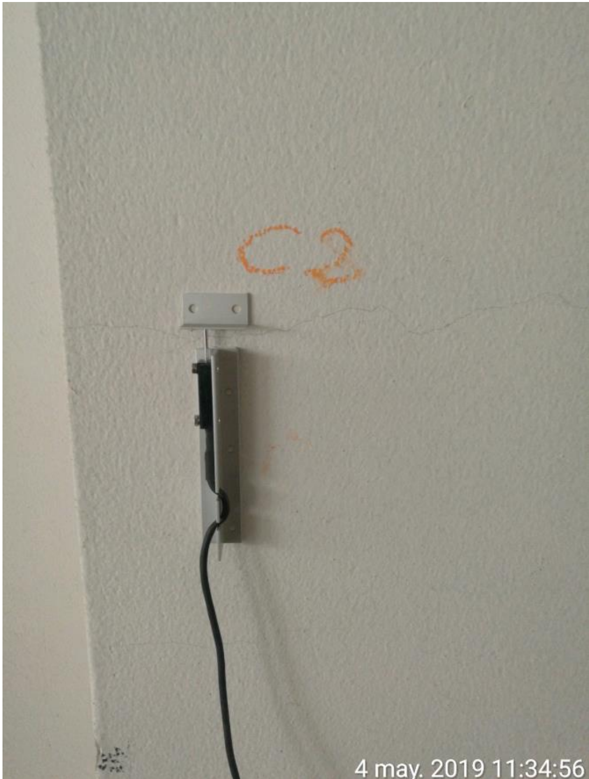
Fotografía 59: Fisura 02 en Columna de Estacionamiento, Zona Común.
