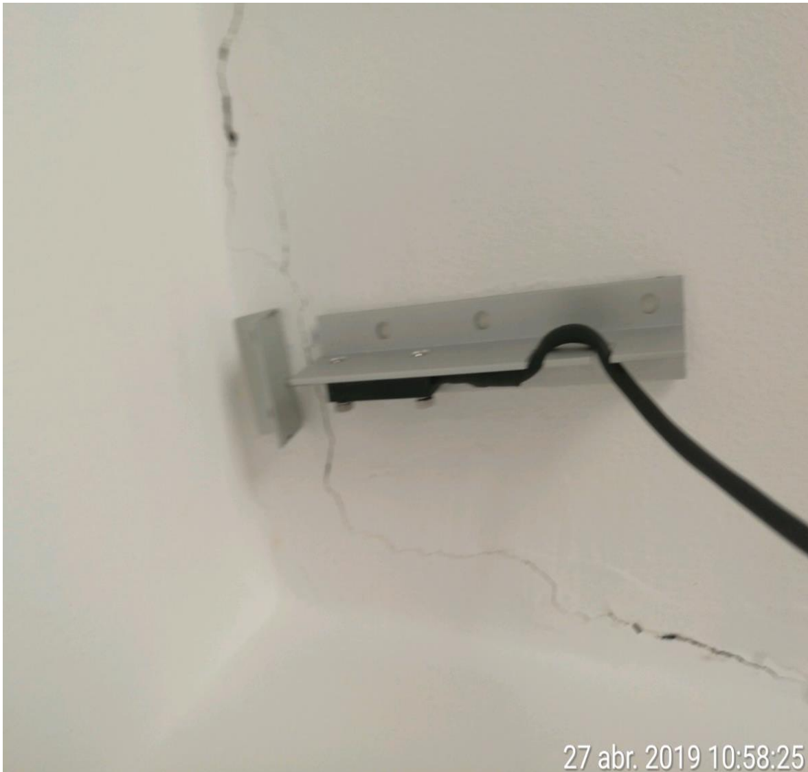
Fotografía 21: Fisura en Closet de Dormitorio 01, Departamento 502
