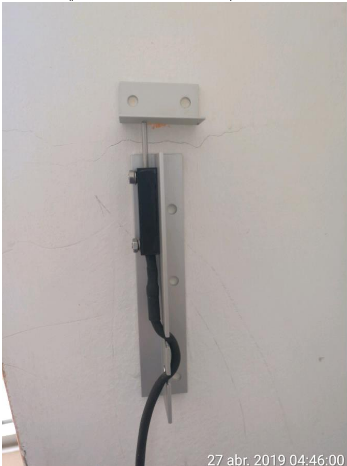
Fotografía 45: Fisura en Muro de Descanso 5 a 4 piso, Zona Común.
