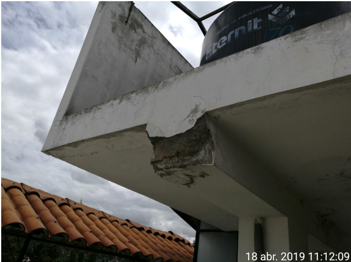
Fotografía 110: Desprendimiento de Concreto en viga.
