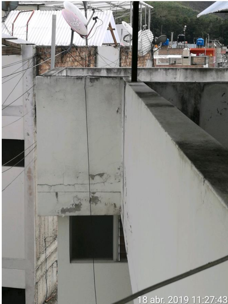
Fotografía 104: Fisuras inaccesibles por ubicación de estas.
