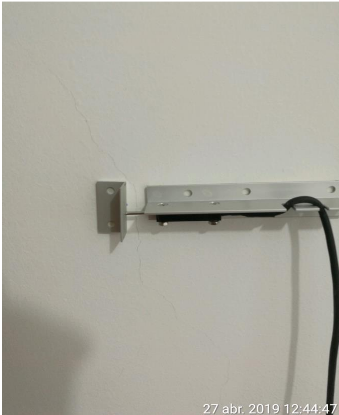
Fotografía 37: Fisura en Muro de Dormitorio 03, Departamento 502
