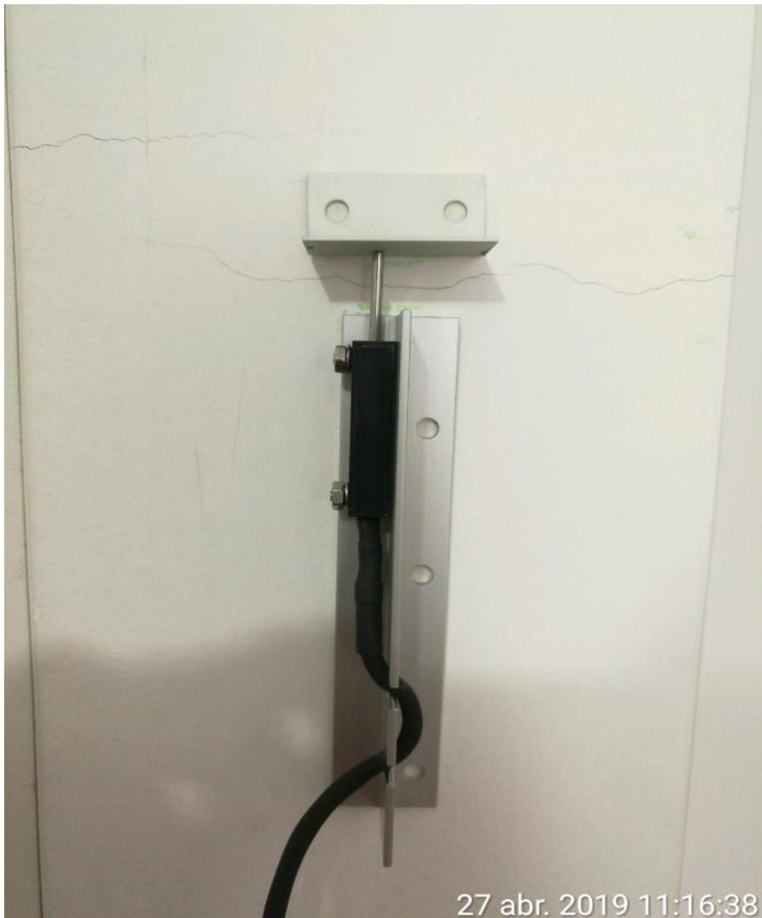
Fotografía 23: Fisura en Muro de Closet derecho en Dormitorio 02, Departamento 502
