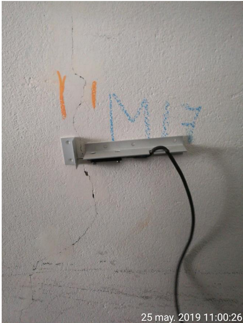
Fotografía 68: Fisura 17 en Muro de Estacionamiento, Zona Común.
