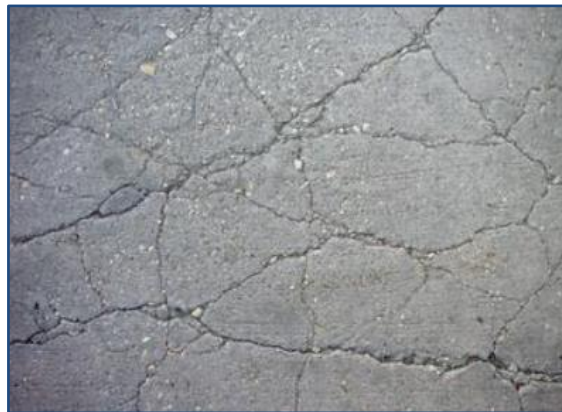
Figura 13: Fisuración por reacción Alkali - Carbonato , de Rodríguez, (2011), Tesis de grado.
