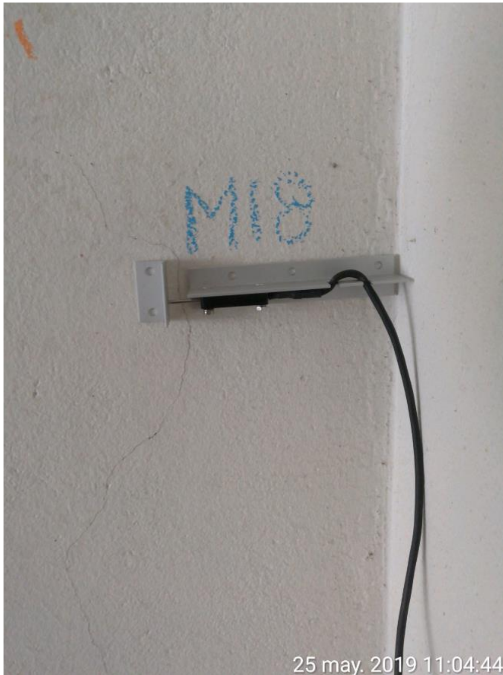
Fotografía 69: Fisura 18 en Muro de Estacionamiento, Zona Común.
