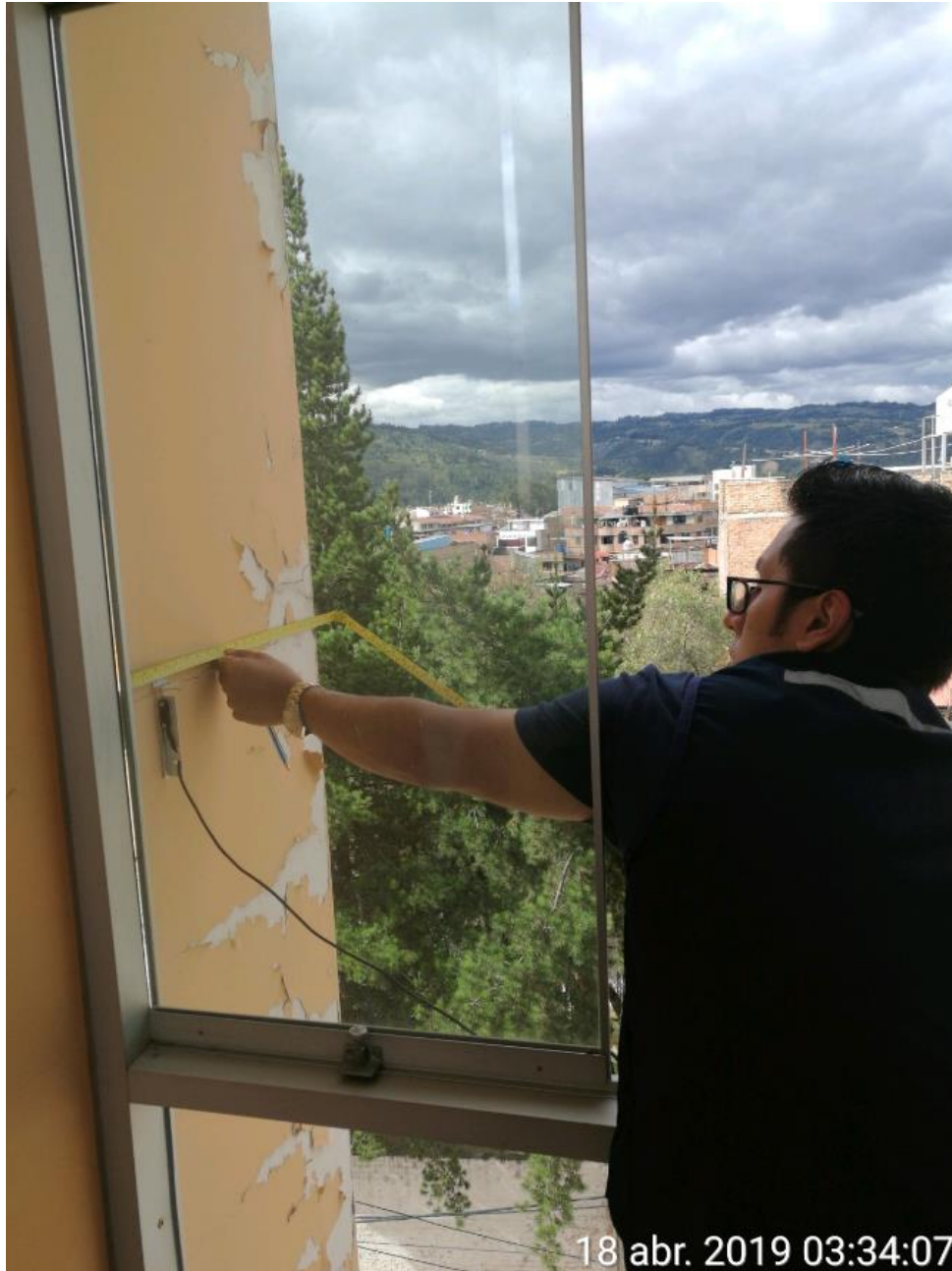
Fotografía 82: Medición de la Longitud de fisura en voladizo.
