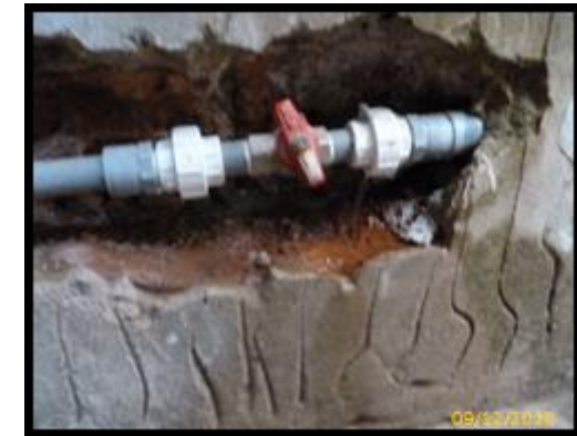
Fotografía 33. Válvula en mal estado.
