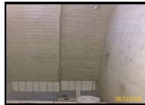
Fotografía 26. Humedecimiento de paredes de baño.
