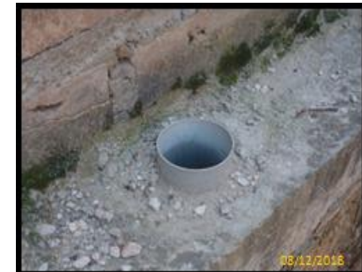
Fotografía 32. Tubería de ventilación expuesta.
