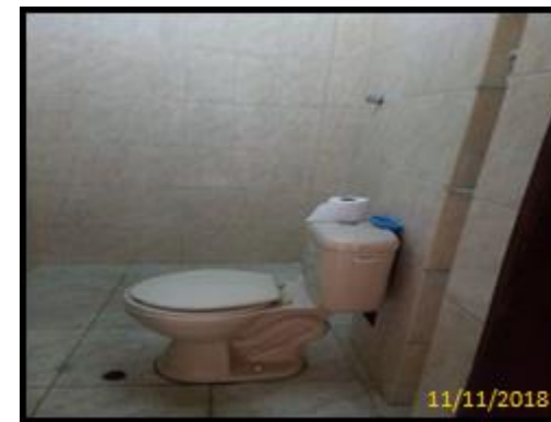
Fotografía 7. Escasa pendiente para la evacuación de agua.
