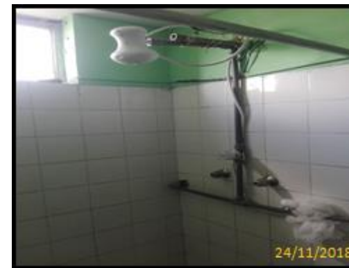
Fotografía 13. Tubería de ducha expuesta.
