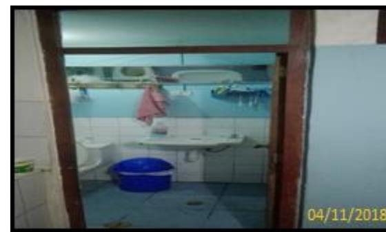
Fotografía 2. Losa de los servicios higiénicos inexistente.
