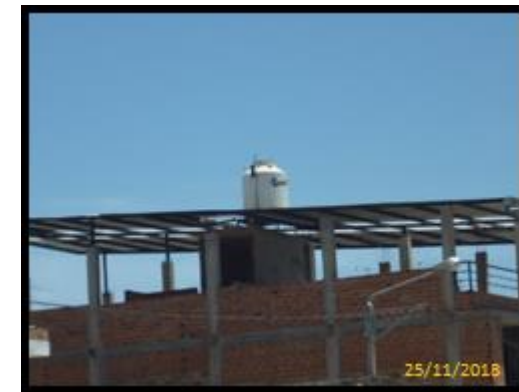
Fotografía 16. Tanque elevado no cuenta con soporte adecuado
