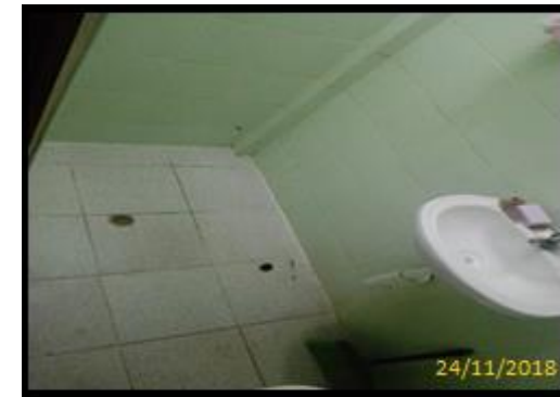
Fotografía 11. Distribución y ergonómica inadecuada.
