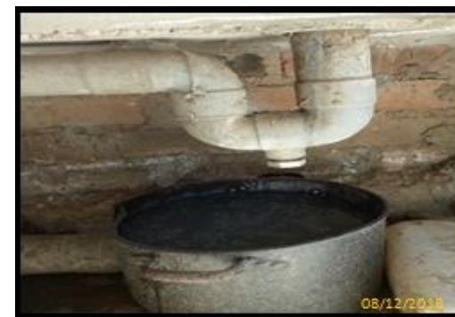
Fotografía 25. Desgaste de accesorios en lavadero.
