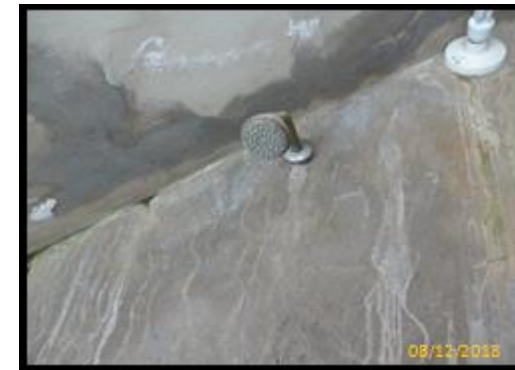
Fotografía 28. Filtración del agua a las paredes.
