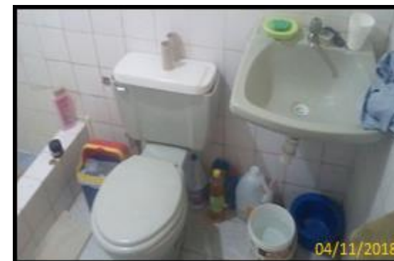
Fotografía 3. Accesorio de lavatorio en mal estado.
