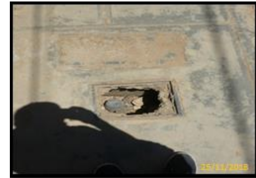
Fotografía 15. Medidor expuesto a la intemperie.
