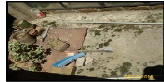
Fotografía 31. Tanque hidroneumático en mal estado.
