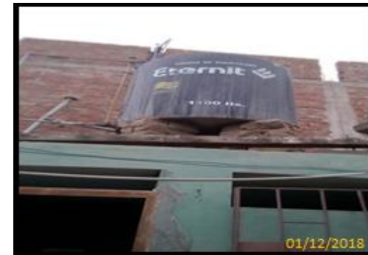
Fotografía 20. Mala ubicación de tanque elevado.
