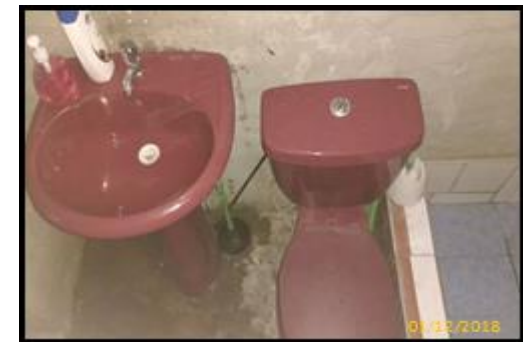
Fotografía 24. Desgaste de accesorios en lavatorio.
