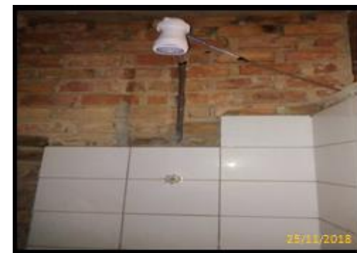
Fotografía 18. Tubería de la ducha expuesta.
