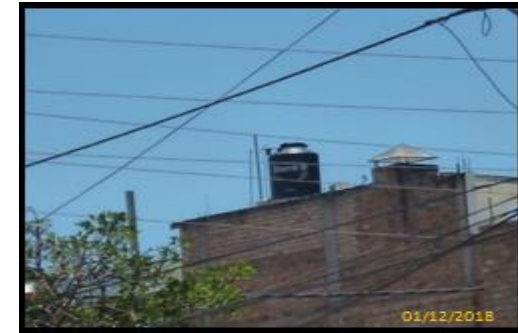
Fotografía 23. Mala ubicación de tanque elevado.
