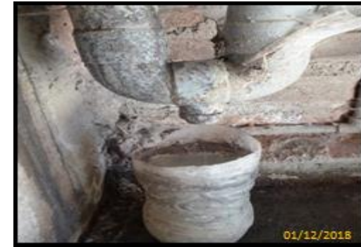
Fotografía 21. Accesorio de lavadero en mal estado.
