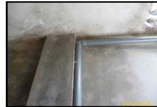
Fotografía 22. Tuberías de desagüe expuestas.
