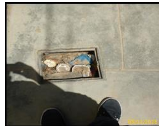
Fotografía 36. Medidor sin tapa metálica.
