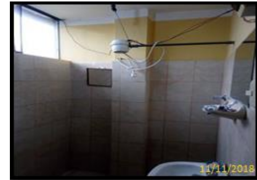
Fotografía 5. La ducha se encuentra conectada a varios cables.
