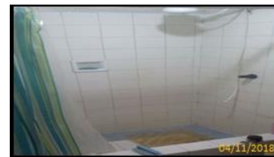
Fotografía 4. No cuenta con ventilación adecuada.
