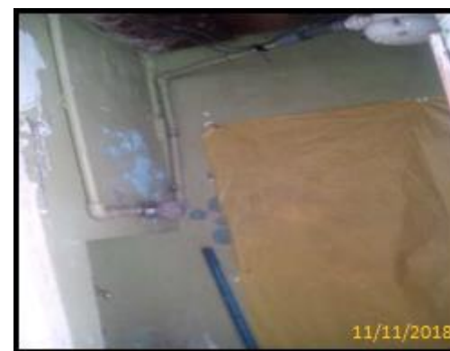
Fotografía 10. Tubería de agua expuesta.
