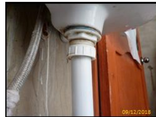
Fotografía 35. Lavatorio con fuga de agua.
