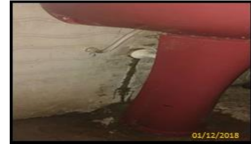
Fotografía 19. Accesorio de lavatorio en mal estado.
