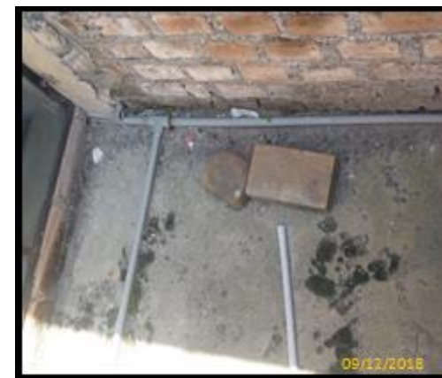
Fotografía 37. Tuberías de distribución expuestas.
