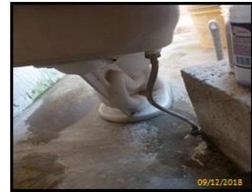
Fotografía 34. Inodoro con fuga de agua.
