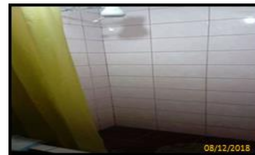
Fotografía 30. Poca pendiente para la evacuación de las aguas.
