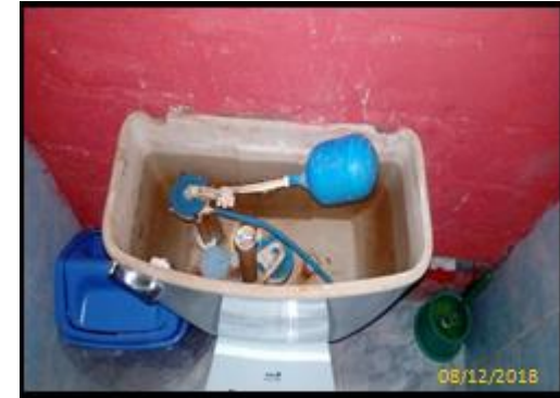
Fotografía 27. Inodoro en mal estado
