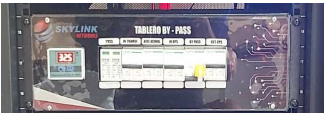
Figura N° 23 tablero eléctrico del microdatacenter.
