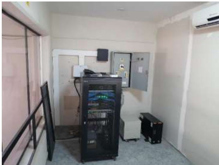
Figura N° 3 Imagen del datacenter actual
