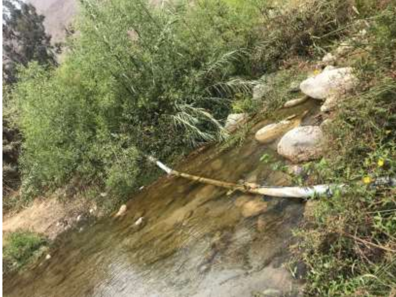
Figura 11: Pases aéreos destruidos-Simbal
