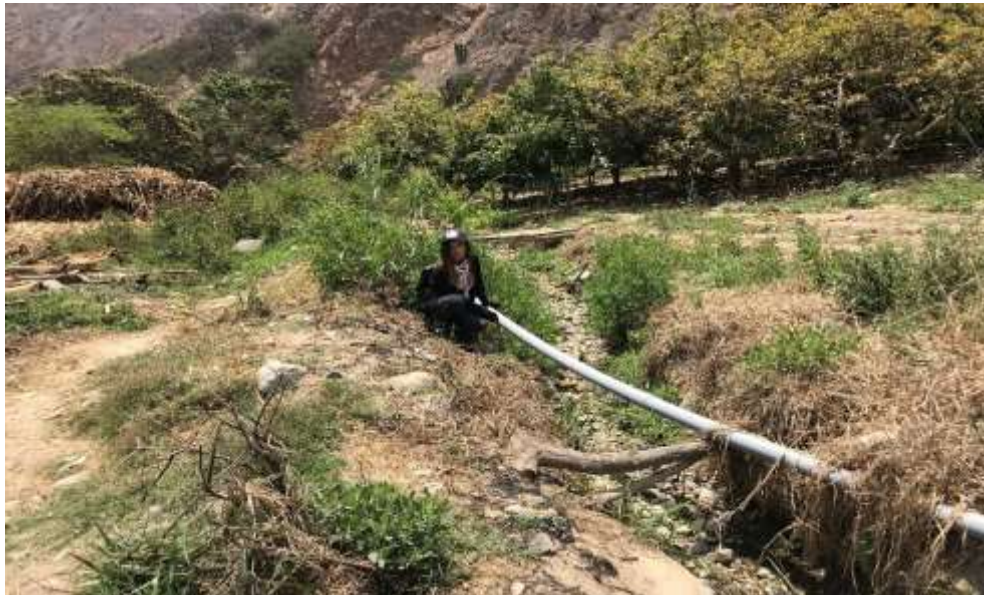
Figura 16: Líneas de conducción expuestas- Simbal
