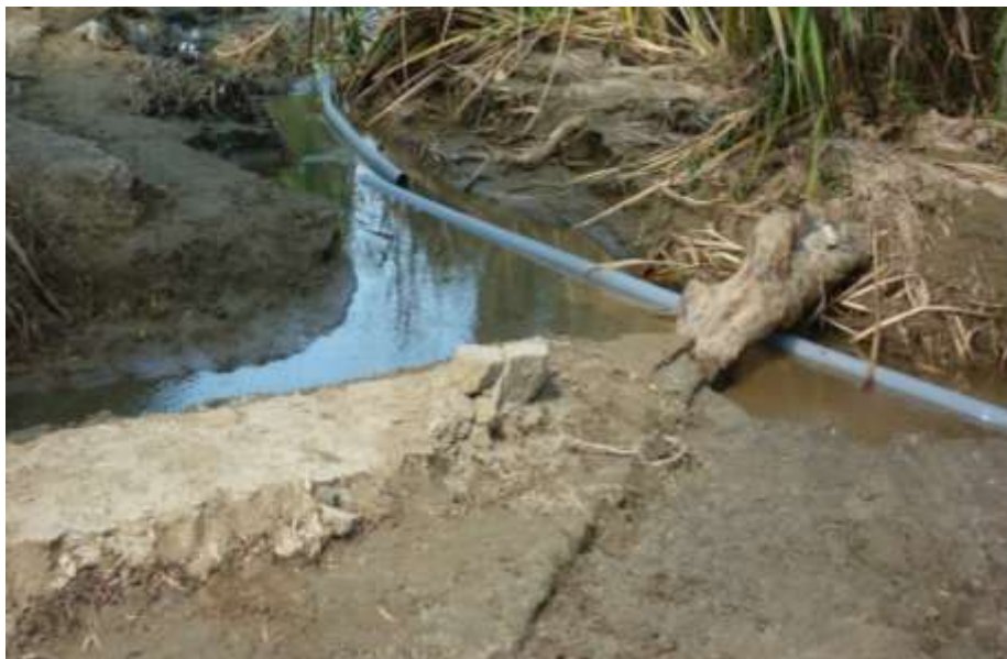
Figura 18: Línea de conducción destruida.
