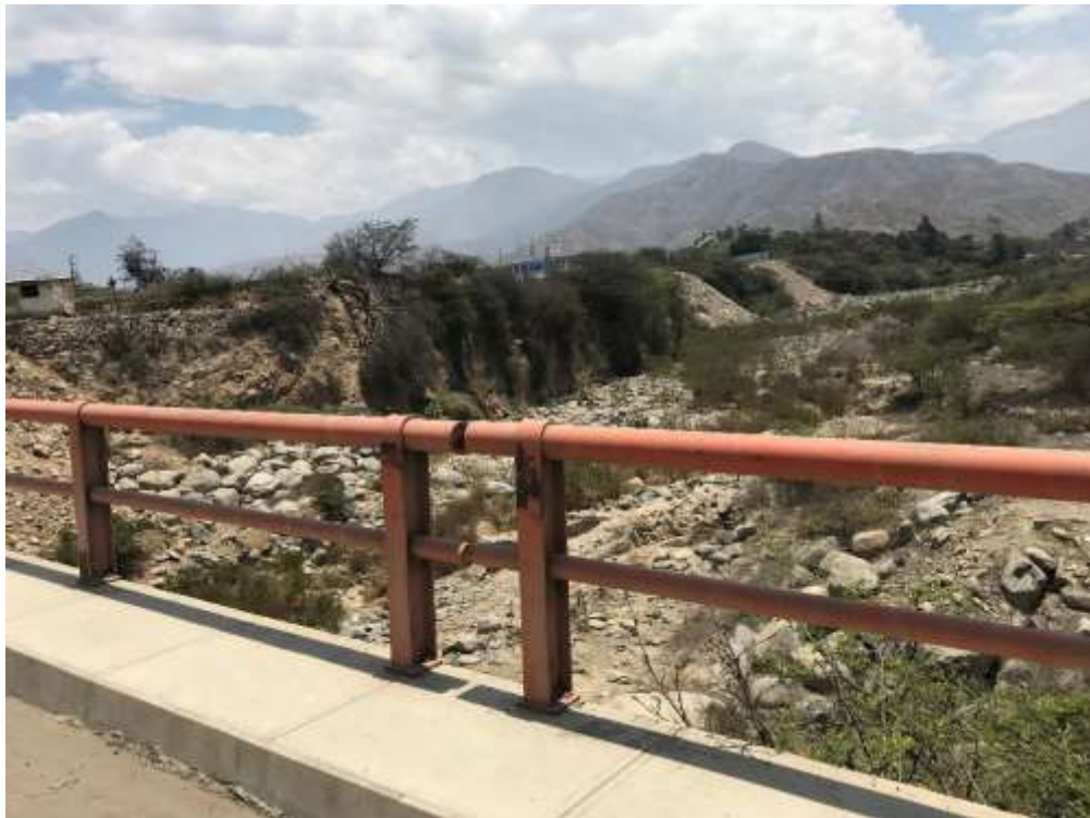
Figura 13: Zona de deslizamientos en el Río La cuesta.
