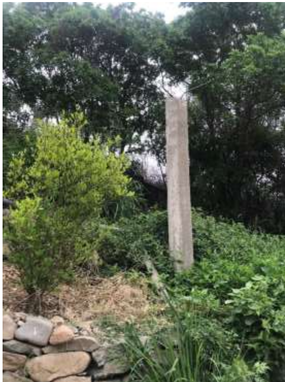
Figura 12: Parante de concreto destruido- Simbal
