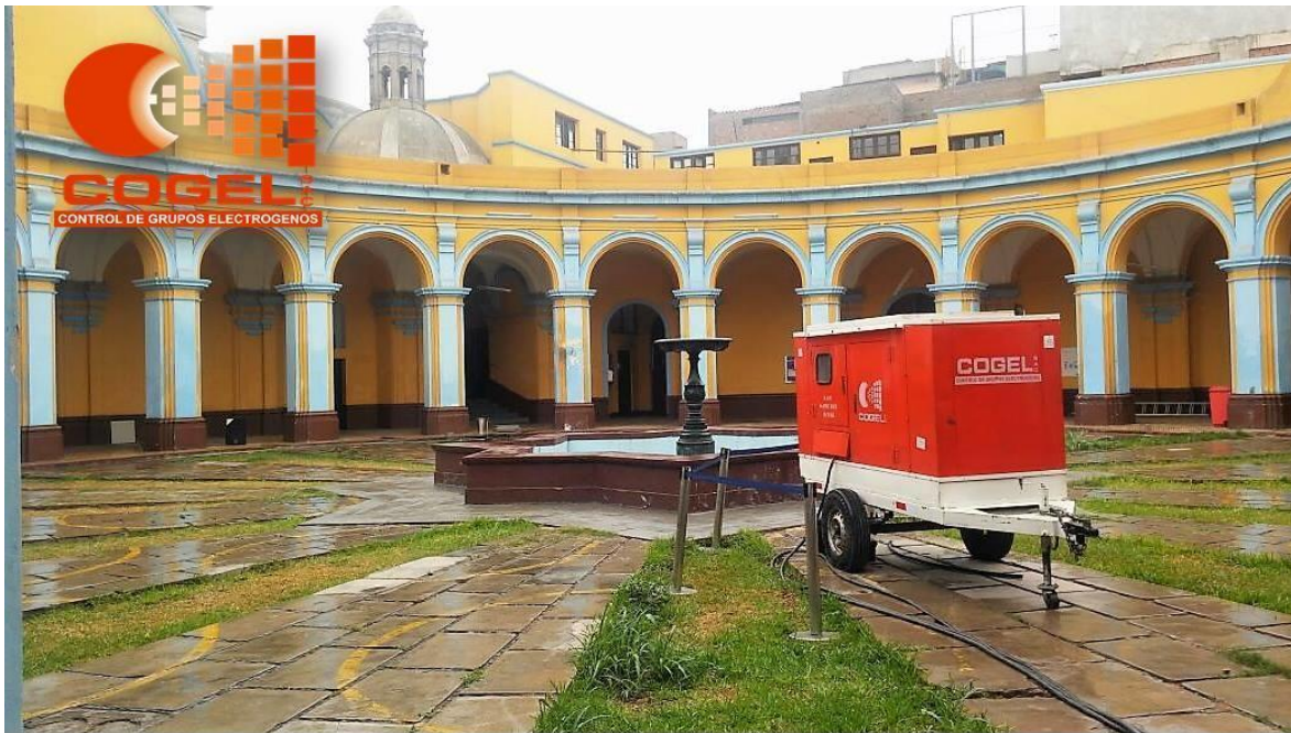
Figura N° 1: Grupo electrógeno brindando servicio, capacidad 20Kw
